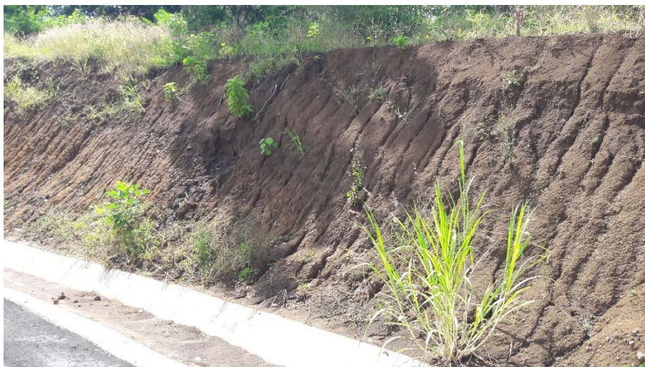
Figura 2 Depósito de suelo erosionado en las cunetas producto de la escorrentía superficial en el talud derecho (sentido ruta 1 – ruta 106)
