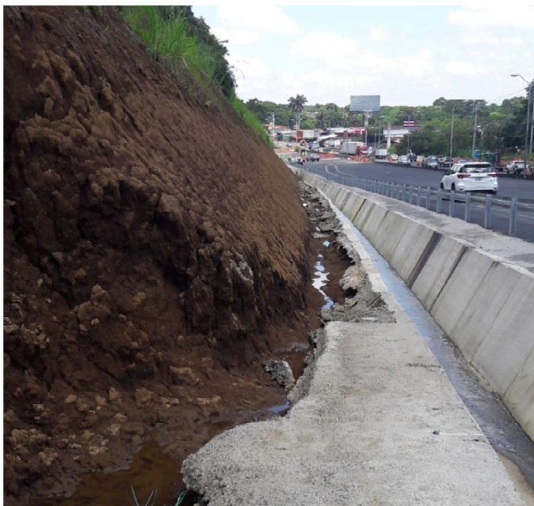
Figura 11 Socavación del terreno próximo a estructuras del drenaje superficial
