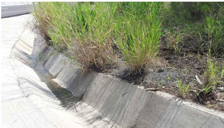
Figura 4 Flujo de agua en la cuneta del talud derecho (sentido ruta 1 – ruta 106), producto de la presencia de niveles de agua subterránea superficiales
