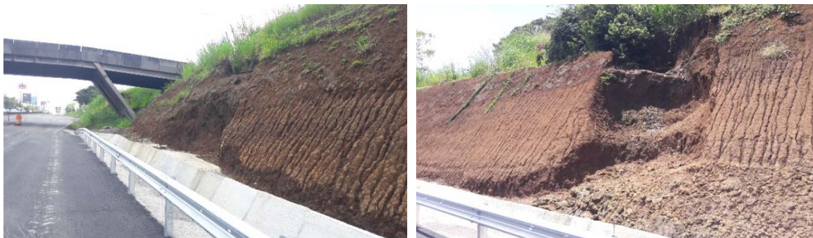
Figura 10 Evidencias de serios problemas de erosión y estabilidad en las caras del talud del estacionamiento 13+950 debido a lluvias intensas
