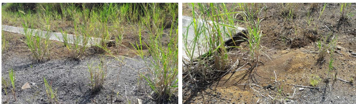
Figura 5 Nivel del terreno por debajo de la altura o nivel de las obras de control de la escorrentía superficial
