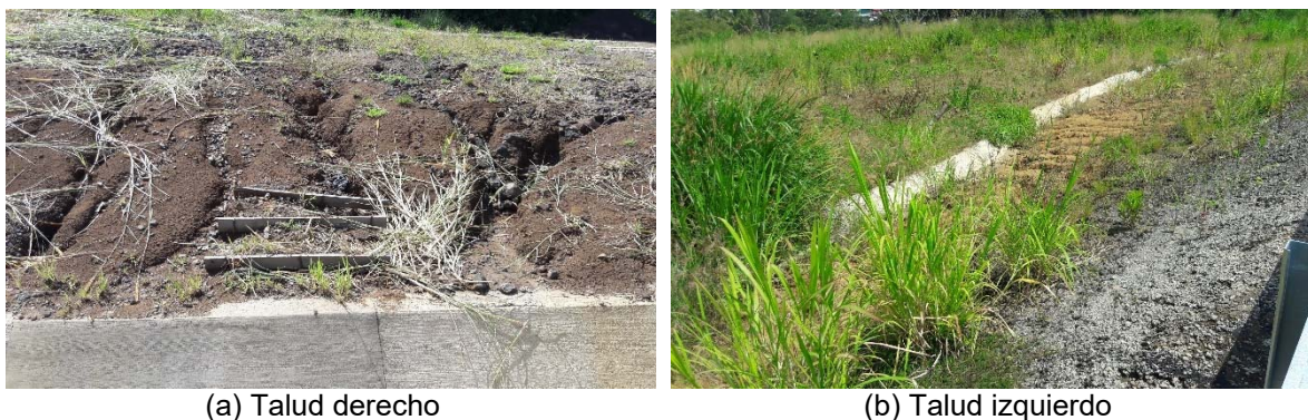
Figura 1 Evidencia de formación de cárcavas en los taludes del corredor Barreal - Castella
