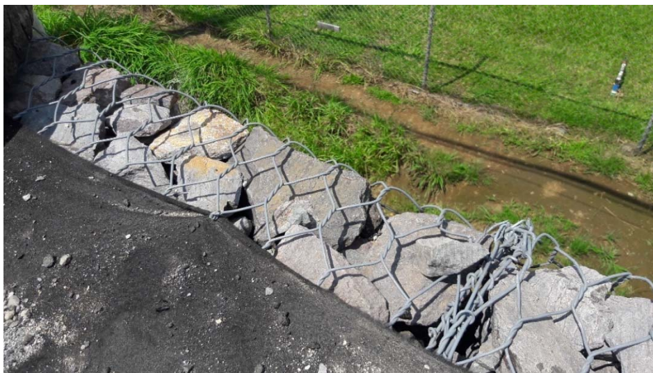
Figura 9 Presencia de piedras con tamaños inadecuados
