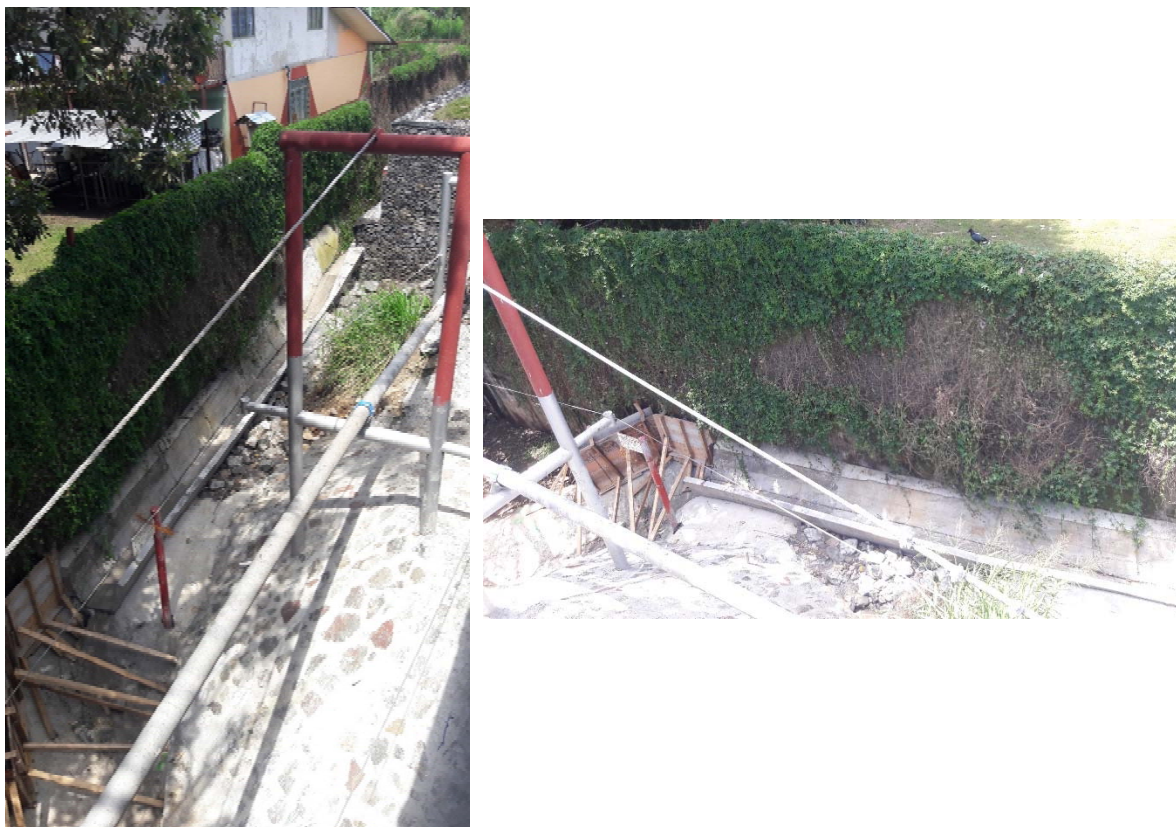
Figura 17 Estructuras hidráulicas en etapas finales de construcción y muro de mampostería de propiedad privada colindante
