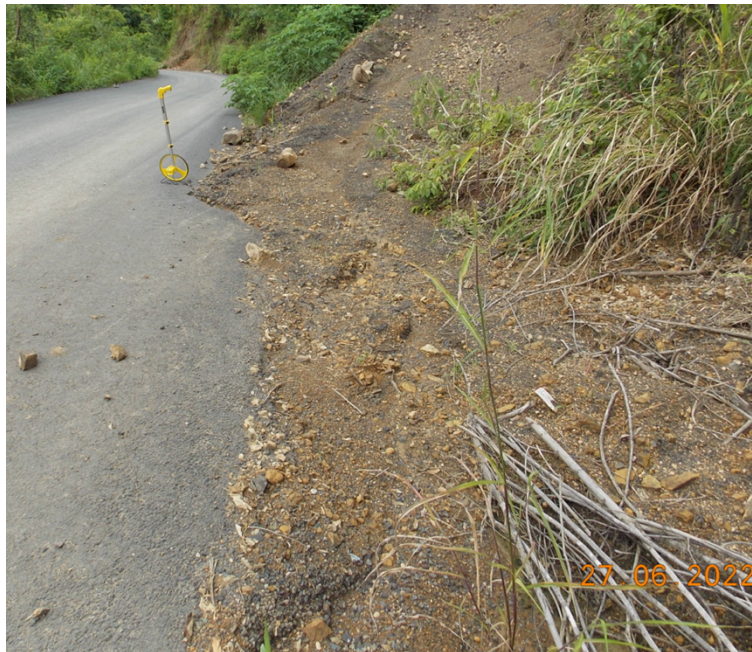
Figura 11: Obstrucción en cuneta por construcción de acceso a propiedad colindante Fuente: LanammeUCR
