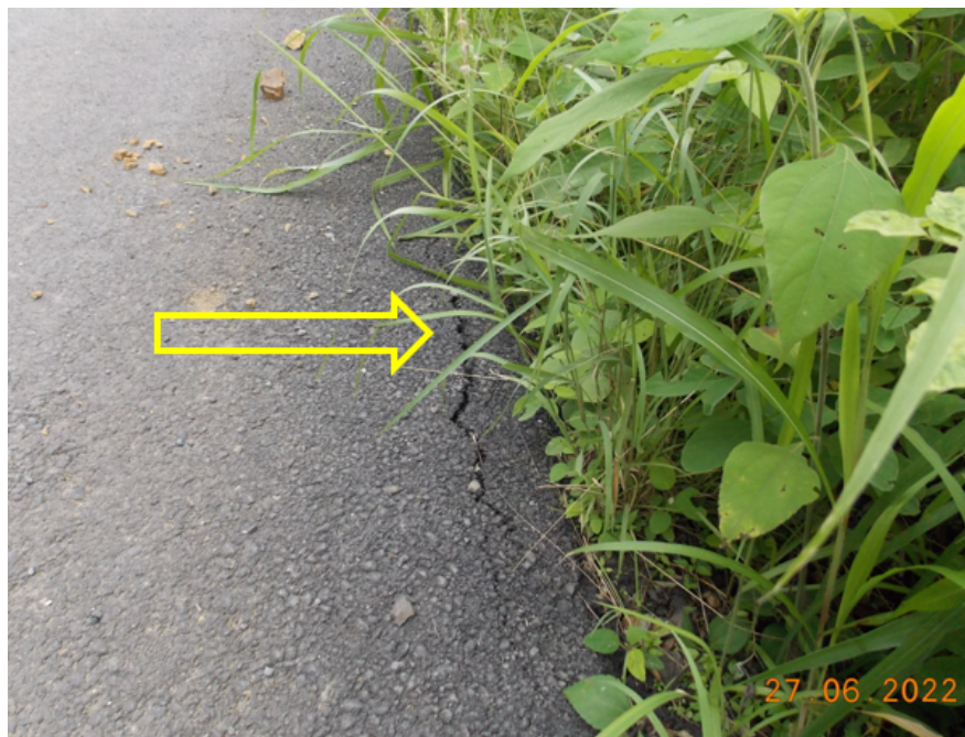
Figura 9: Grietas longitudinales de borde en zona afectada por cárcava en estacionamiento 0+042 Fuente: LanammeUCR
