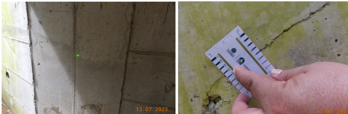
Figura 7: Agrietamiento por junta fría con un ancho máximo medido de 1mm. Fuente: LanammeUCR
