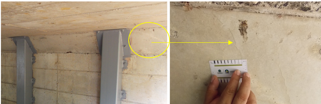
Figura 9: Agrietamientos por contracción en borde superior del bastión. Fuente: LanammeUCR
