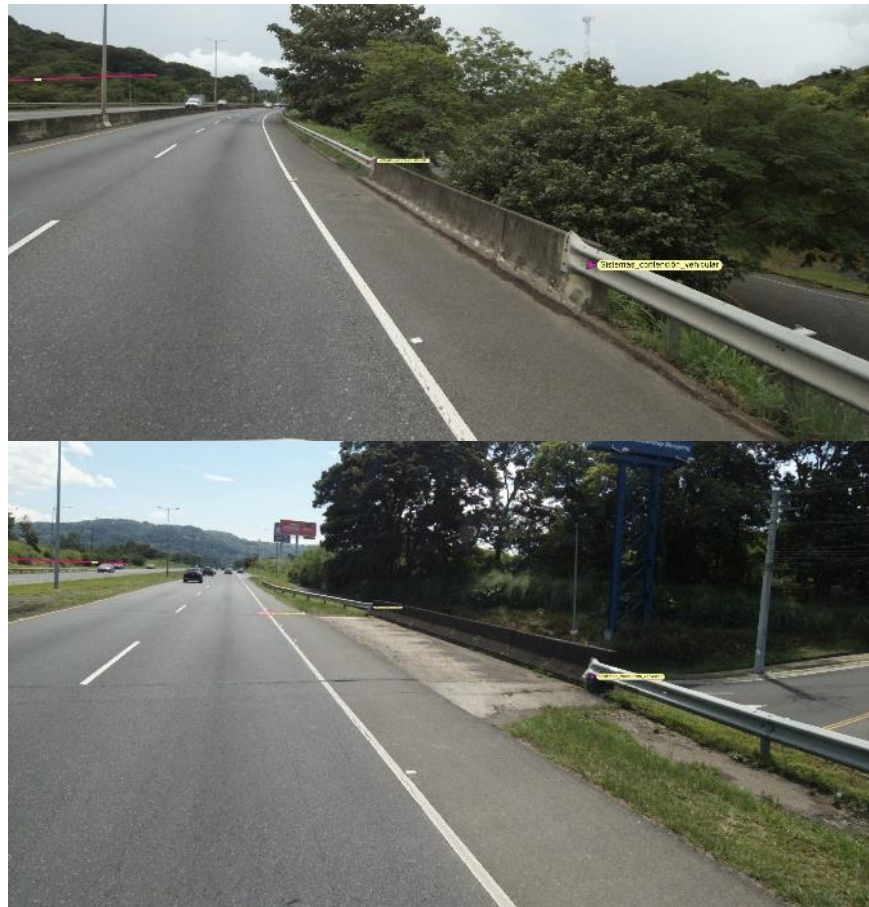
Figura 42. Deficiencias regulares a nivel de transiciones entre barrera metálica y barrera de concreto
