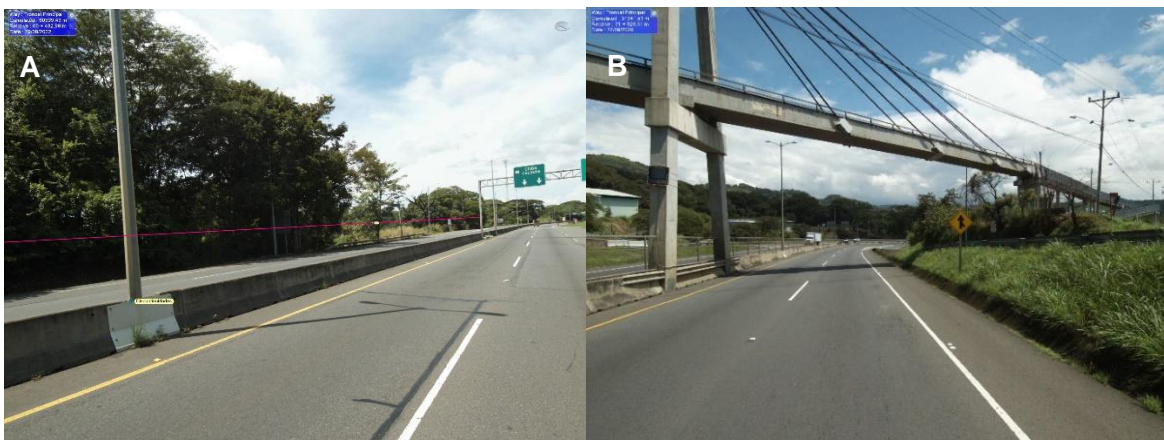
Figura 50. Deficiencias críticas a nivel de discontinuidades en barrera medianera (A) y en pretil de puente (B)
