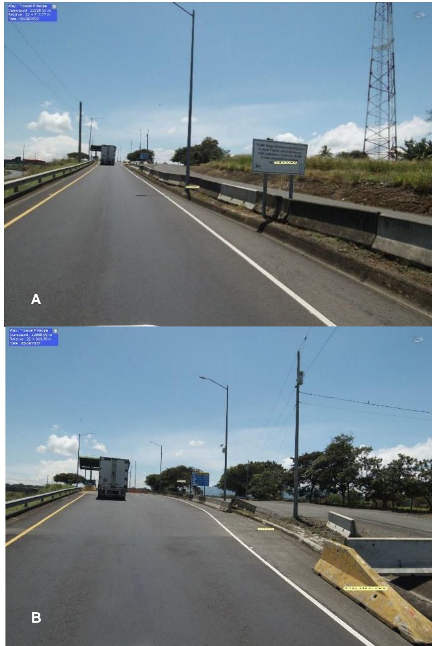
Figura 67. Deficiencias críticas a nivel de discontinuidades en barreras de concreto en la Radial El Coyal (A) y Radial Atenas (B)
