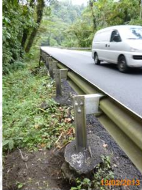
Fotografía 9. Poste hincado y colocado en una base de concreto que se encuentra socavada. Ubicación: Ruta Nacional 32 Aproximadamente Km 38+200 Sentido San José-Limón Fecha: 13/02/2013.
