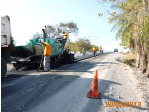
Fotografía 17. Cono que requiere limpieza y cinta retrorreflectiva.
