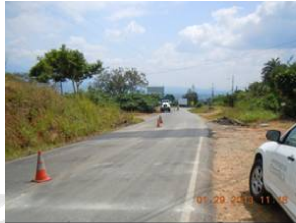
Fotografía 15. Frente de trabajo sin banderillero. Ruta Nacional 2, San Rafael de Pérez Zeledón. Aproximadamente 6 km al norte de San Isidro de Pérez Zeledón.
