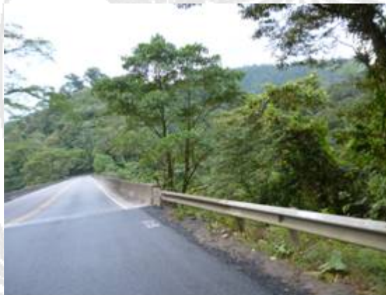
Fotografía 10. Transición inadecuada. Ubicación: Puente sobre el Río Sucio, Ruta Nacional 32 Fecha: 08/02/2013
