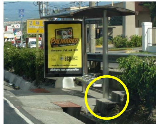
Fotografía A.6.2. Acceso inadecuado hacia la parada de autobús. Autopista General Cañas. (Fecha: 26 de febrero del 2009)
