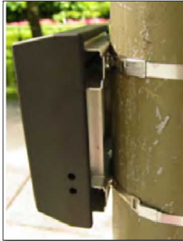
Figura 5. Contador PyroBox instalado Fuente: (Roca, 2016)
