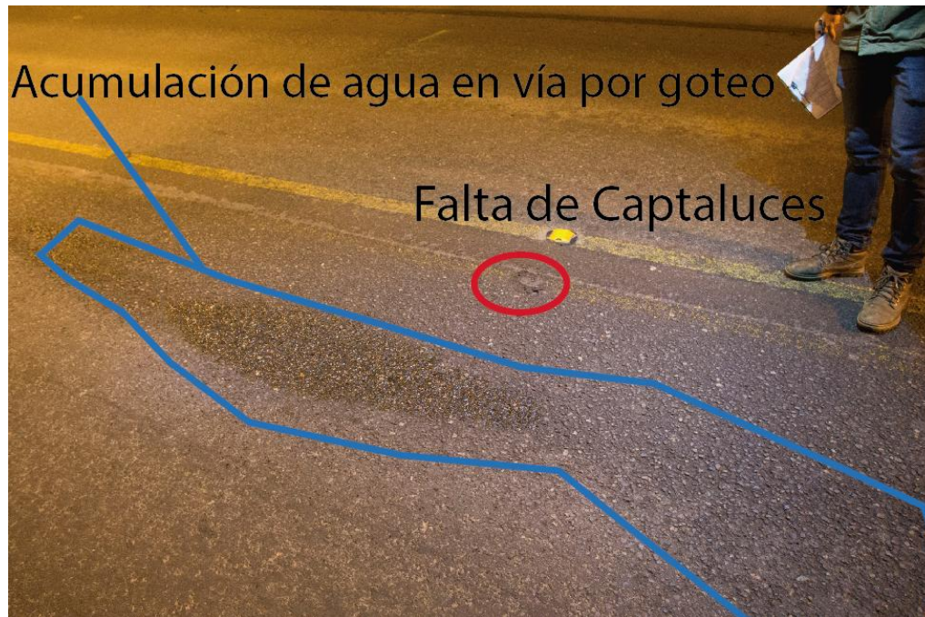
Figura 6. Acumulación de agua en la vía por goteo y falta de captaluces.
