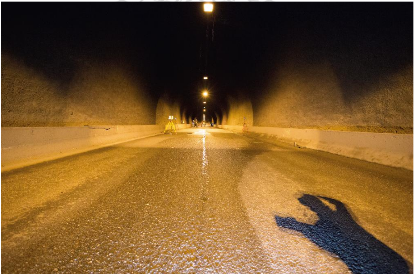
Figura 8. Acumulación de agua en parte central la vía por goteo y falta de captaluces. También se observa el desgaste de la capa asfáltica
