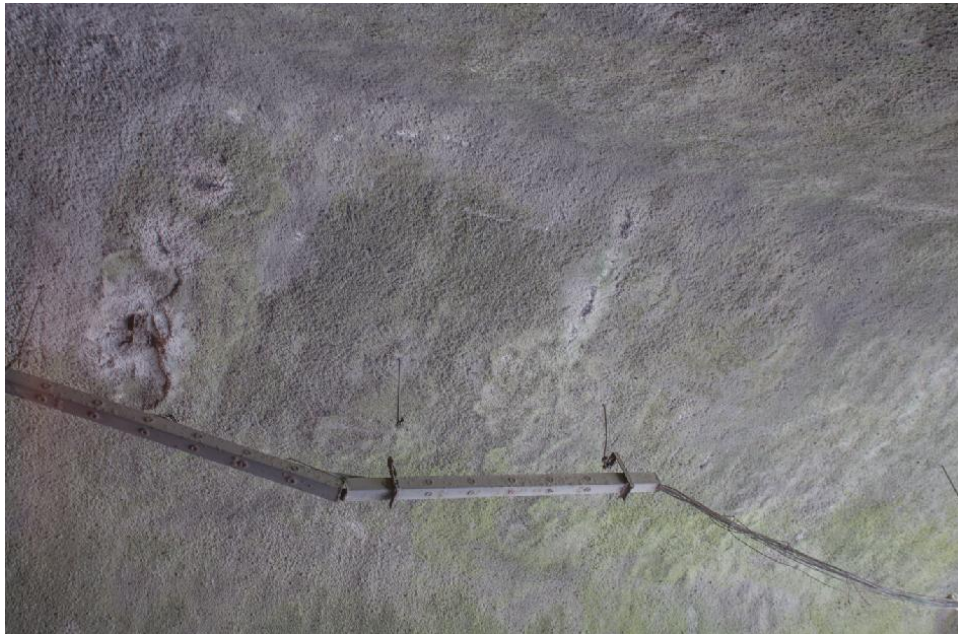
Figura 16. Regleta que sostiene lámparas desprendida y sin estas.
