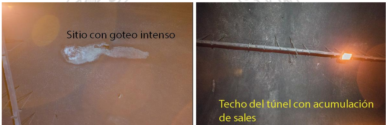
Figura 10. Eflorescencia y puntos con goteo
