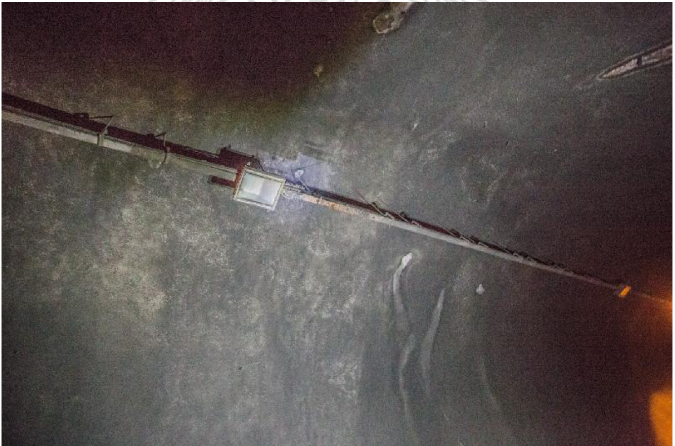
Figura 9. El tubo que sostienen el sistema de iluminación en este sector es colgando. En la pared LD y en el techo, se pueden observar eflorescencias.
