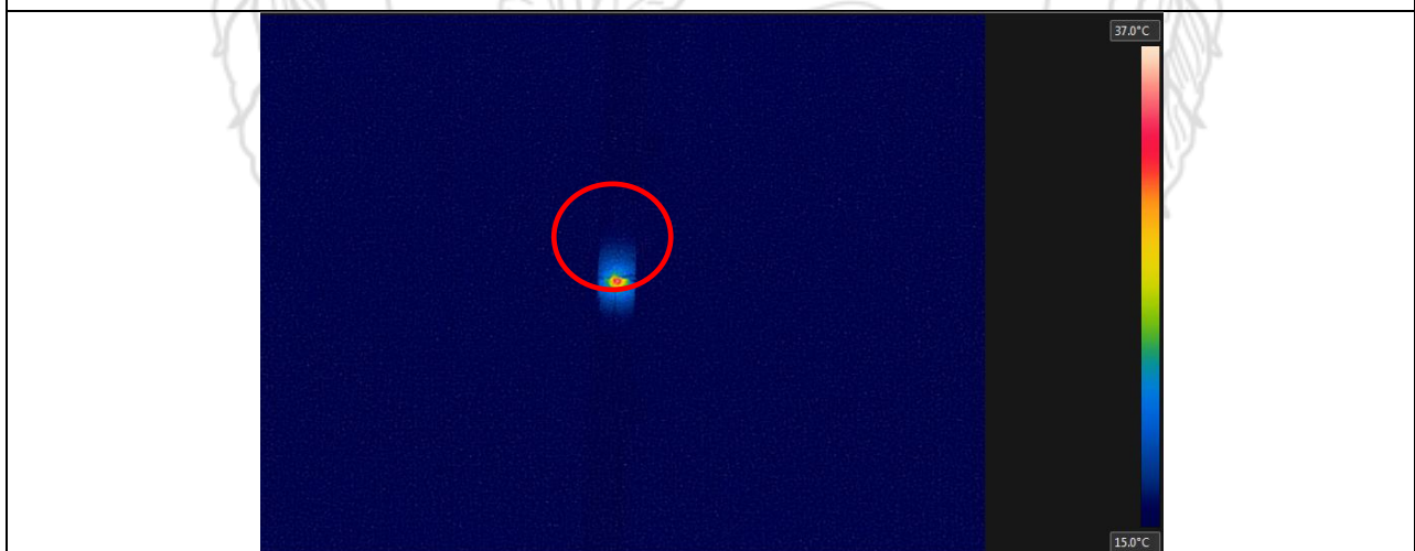
Figura 26. Est. 0+365 se observa un punto en el conducto del cableado eléctrico que se encuentra en una temperatura de alrededor de 35°C
