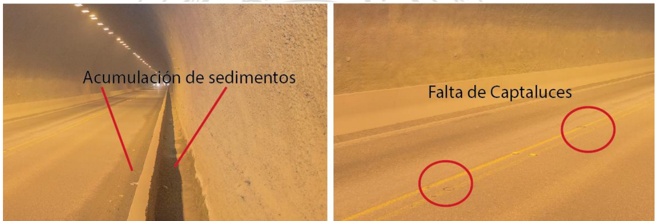
Figura 5. Acumulación de sedimentos en los bordes y falta de captaluces.
