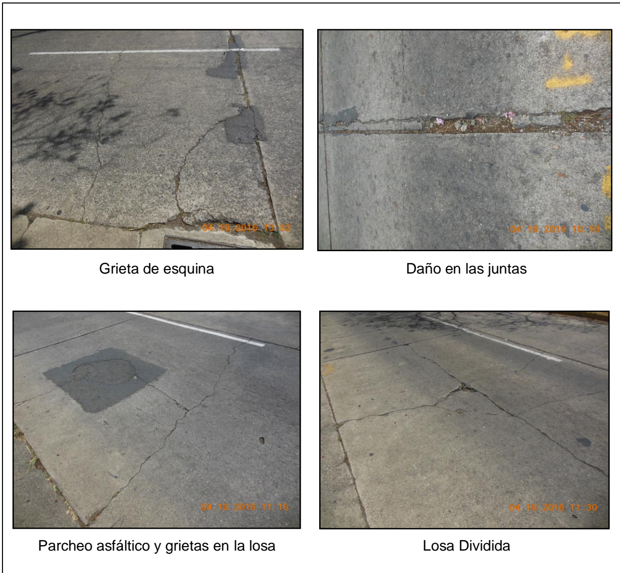
Figura 31. Deterioros del pavimento de concreto hidráulico en los tramos analizados
