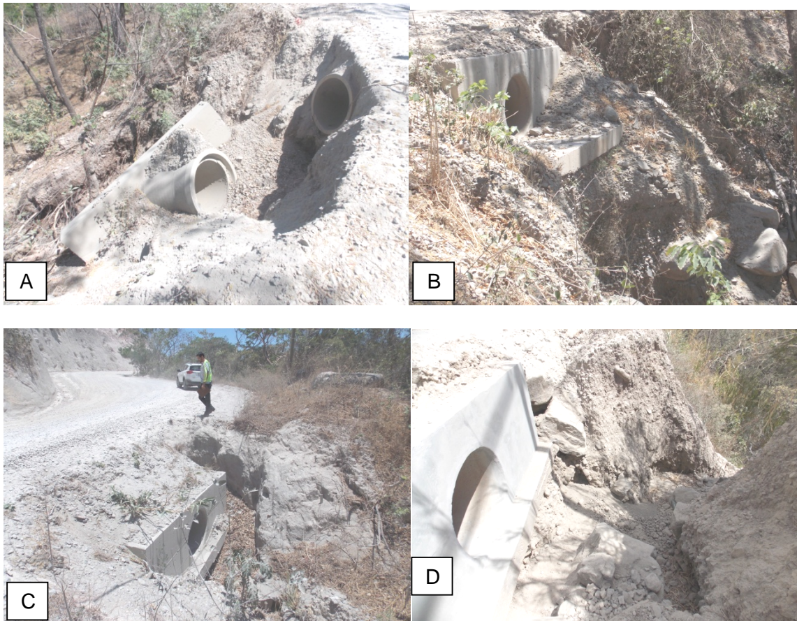
Figura No.24 Daño en el cabezales de salida en los pasos de alcantarilla (Abril 2016) A) Est 7+030, B) 9+300, C) 11+860, D) 22+350
