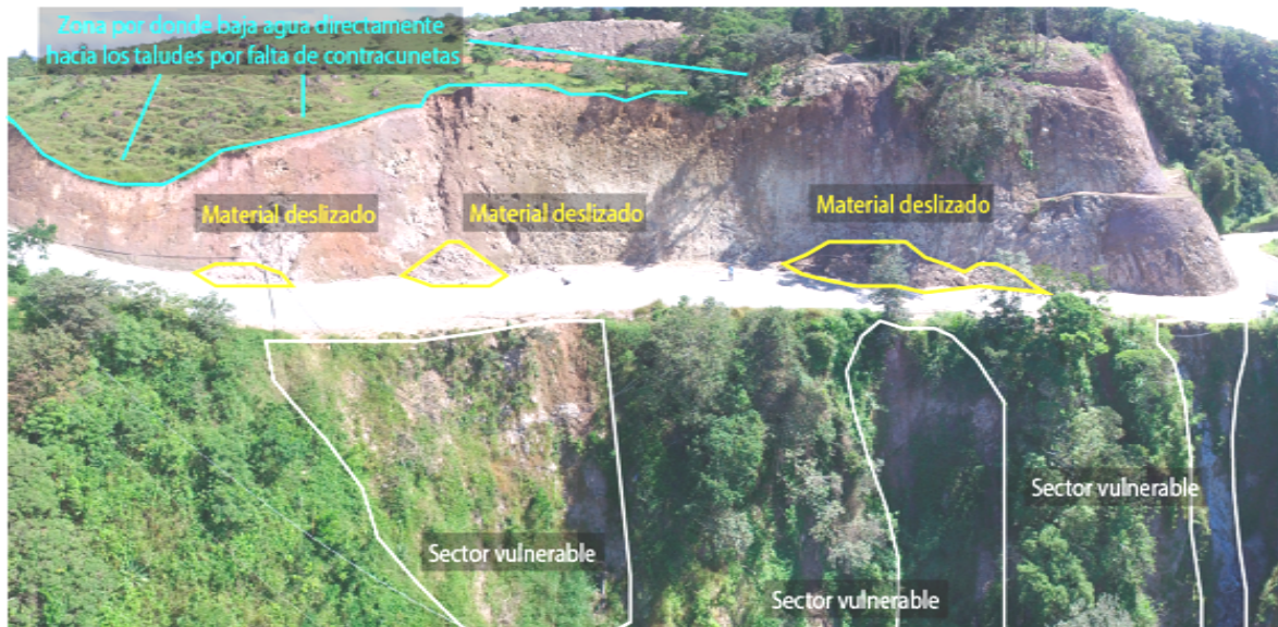
Figura No.7 Vista aérea del talud de corte en el estacionamiento 21+750. Se destaca la vulnerabilidad de los taludes ante la ausencia de obras para el manejo del agua de escorrentía, así como los puntos en los cuales se identificó material caído sobre la carretera.
