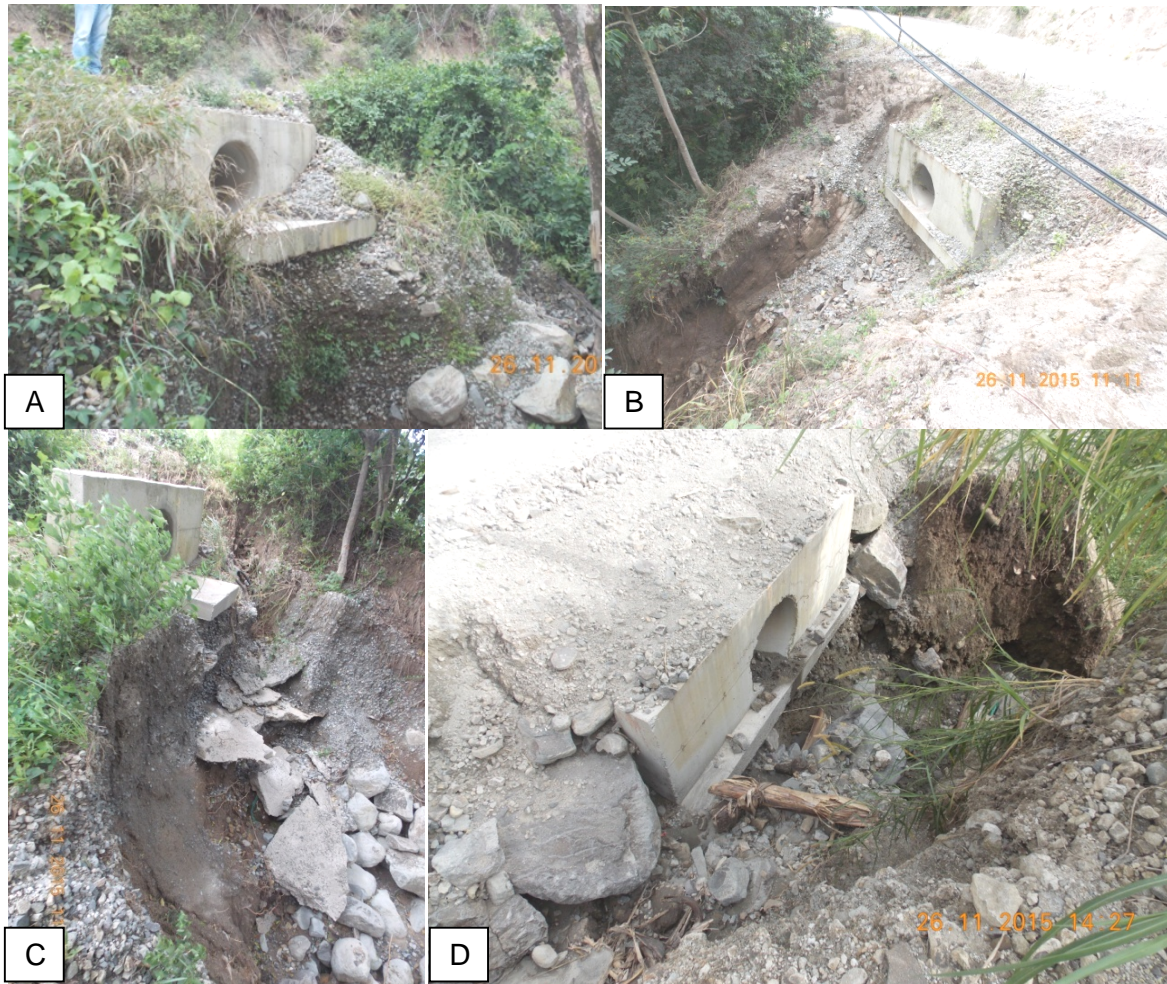
Figura No.22 Erosión e inestabilidad en cabezales de salida (Noviembre 2015). A) Est. 7+920. B) Est. 9+705. C) Est. 10+415. D) Est. 21+440.
