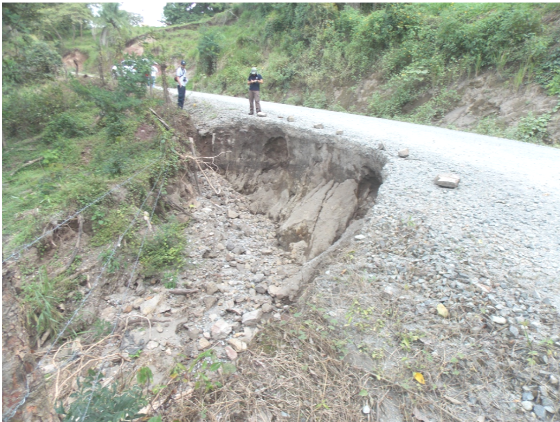
Figura No.10 Relleno erosionado e inestable en el estacionamiento 7+300, condición en noviembre del 2015.
