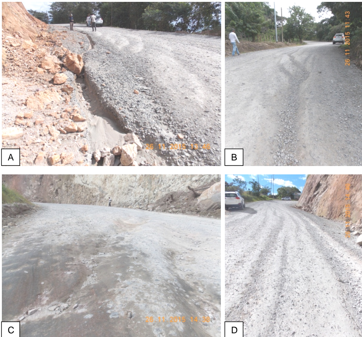
Figura No.19 Erosión de calzada y hombros provocada por falta de cunetas (Noviembre 2015).
