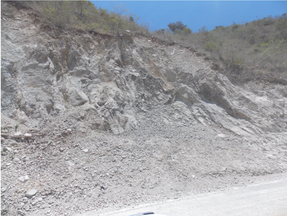
Figura No.8 Deslizamiento en estacionamiento 13+680 (condición en abril 2016). Se observan rocas de tamaño métrico y suelos residuales.
