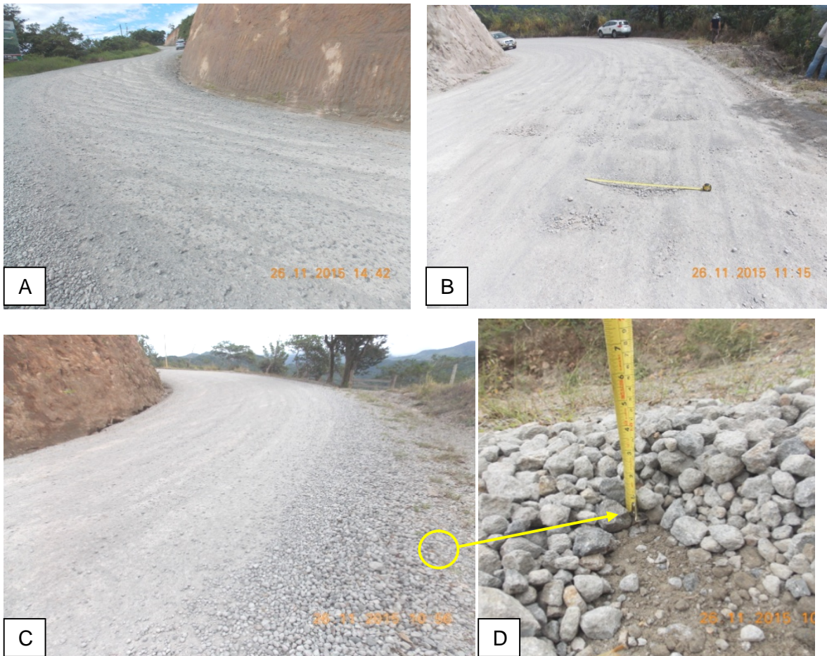
Figura No.15 Deterioros la superficie de ruedo (Noviembre 2015).
