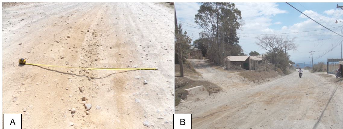
Figura No.17 Deterioros de la superficie de ruedo (Abril 2016) . A) Ahuellamiento severidad alta Est 20+250, B) Deformaciones Est 22+480
