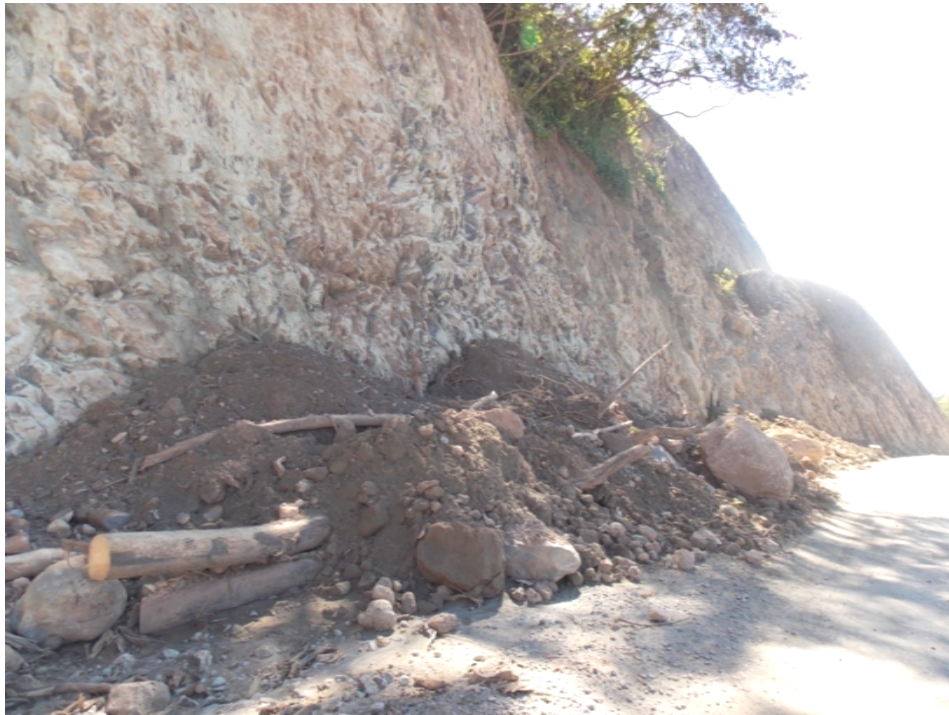
Figura No.6 Deslizamiento de rocas, suelo residual con troncos de árboles en el estacionamiento 21+750 observado en noviembre del 2015. En este sitio, las rocas caídas pueden llegar a ser de tamaño métrico y junto con el suelo logran bloquear las cunetas.
