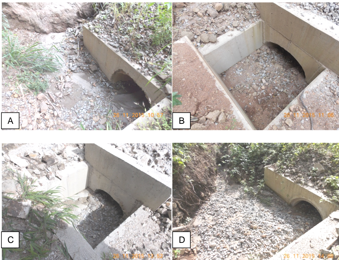
Figura No.21 Sedimento en entrada de pasos de alcantarilla (Noviembre 2015)
