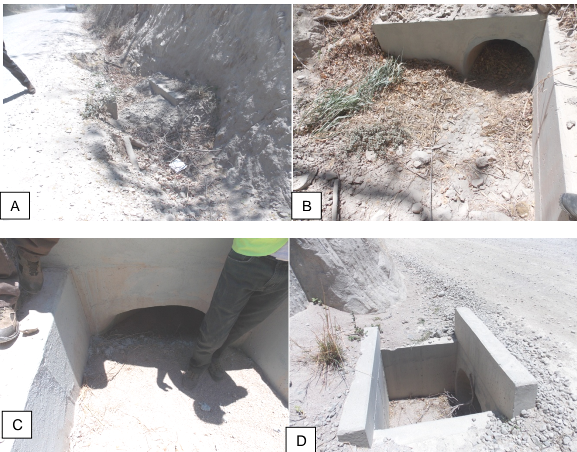
Figura No.23 Sedimentación en cabezales de entrada (Abril 2016) A) Est. 7+720, B) Est 8+550, C) Est 9+855 D) Est 11+000
