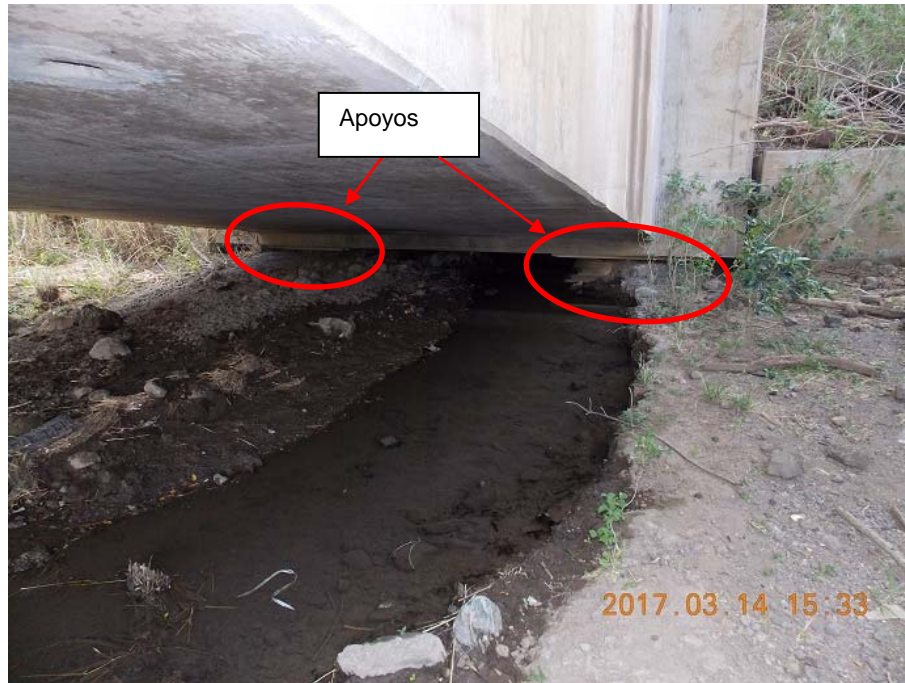
Figura 9. Descarga de agua y acumulación de sedimentos sobre el bastión 2 y sus apoyos.
