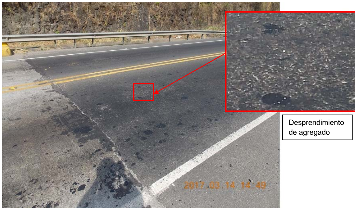
Figura 6. Desprendimiento de agregado en el pavimento del acceso 1.
