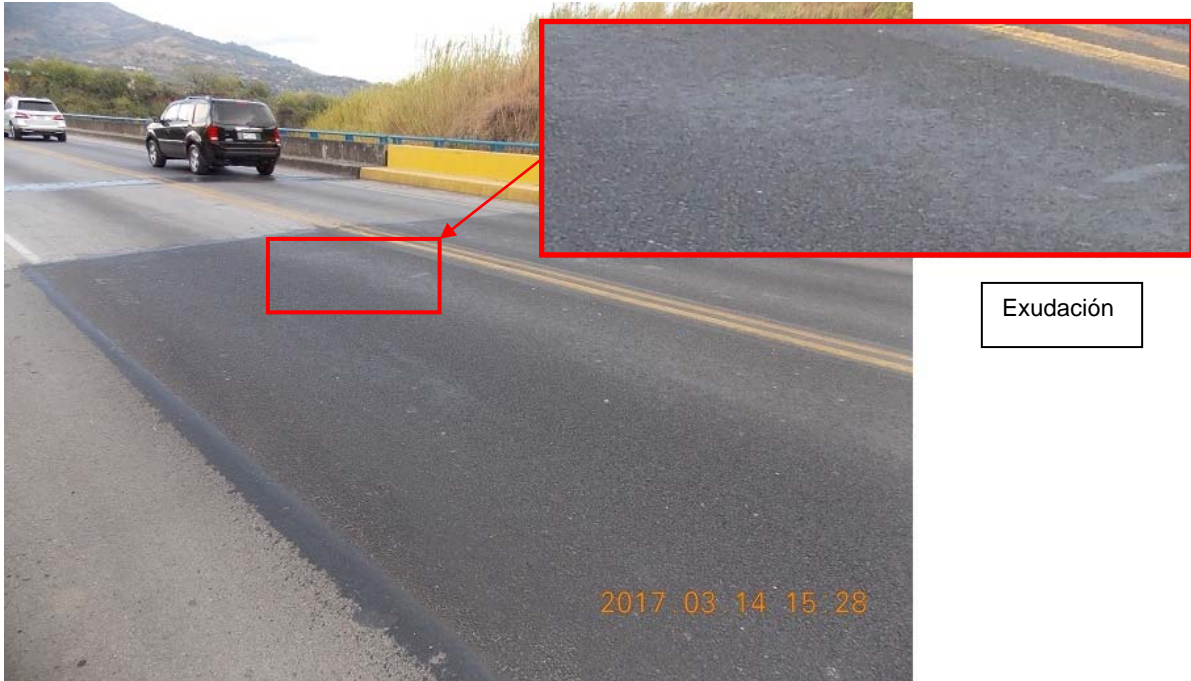
Figura 7. Desprendimiento de agregado y exudación en el pavimento del acceso 2
