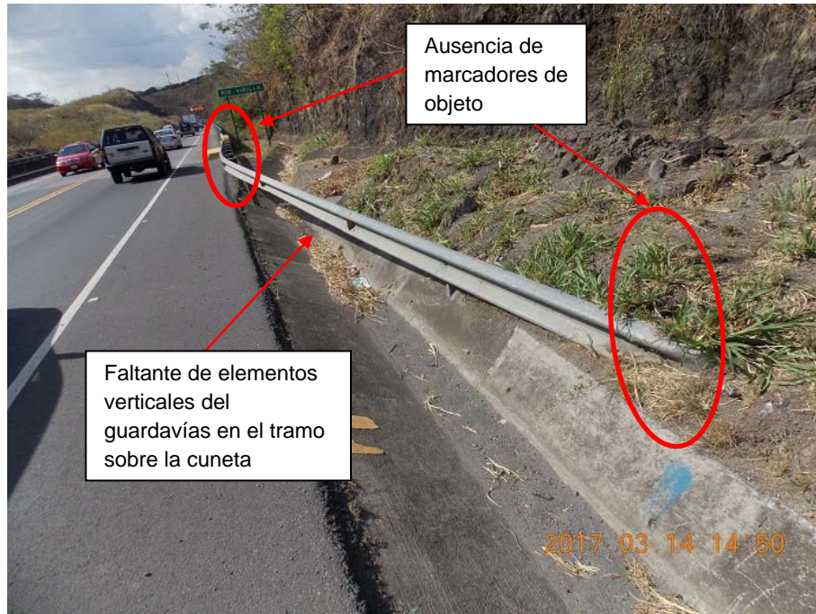
Figura 1. Ausencia de marcadores de objeto y faltante de elementos en el guardavías del acceso 1.
