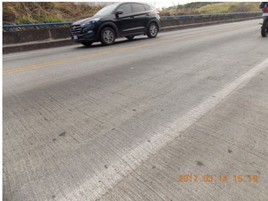
Figura 2. Demarcación horizontal en mal estado
