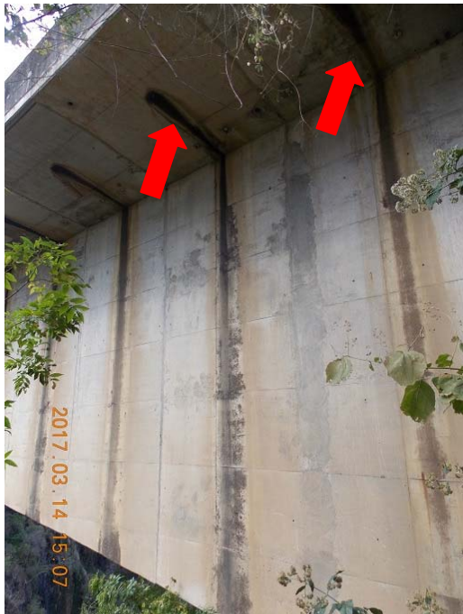
Figura 4. Ausencia de tubos de extensión en los drenajes de la superestructura y evidencia de descarga de agua sobre la viga principal
