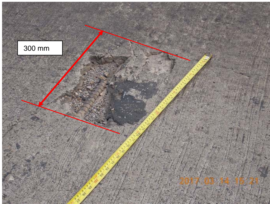
Figura 12. Desprendimiento de concreto del tablero con exposición de la barra de refuerzo.
