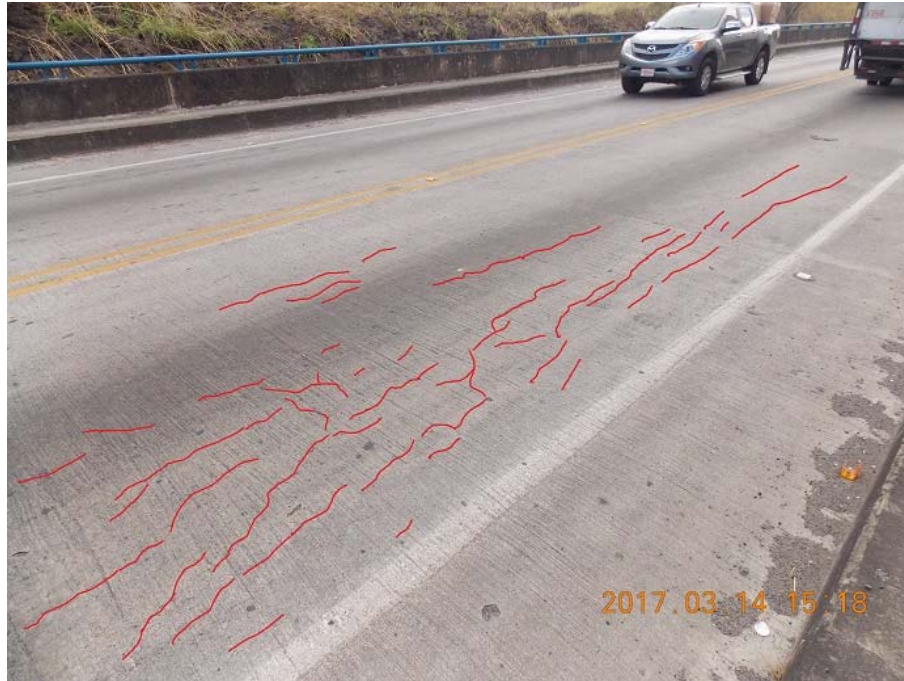
Figura 11. Agrietamiento en una dirección
