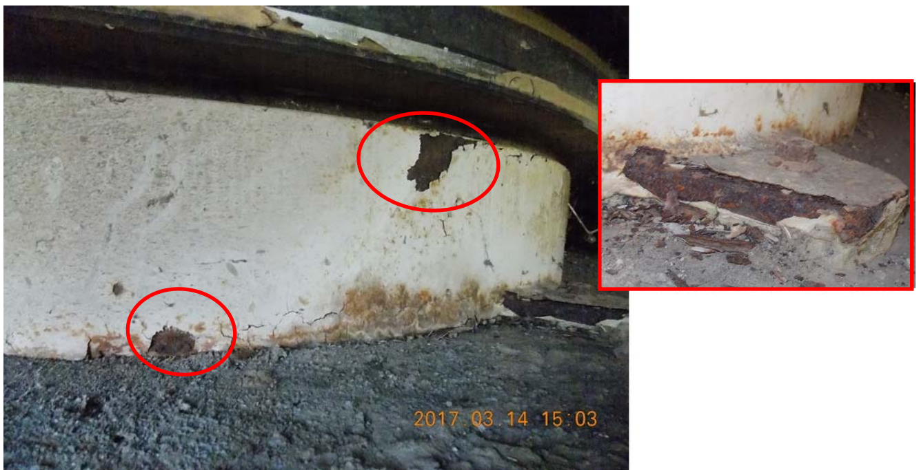
Figura 14. Oxidación y deterioro del sistema de protección contra la corrosión de apoyo sobre el acceso 1
