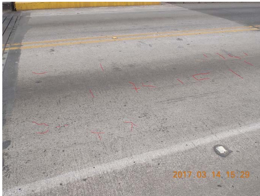
Figura 8. Patrón de agrietamiento en la losa de aproximación del acceso 2.
