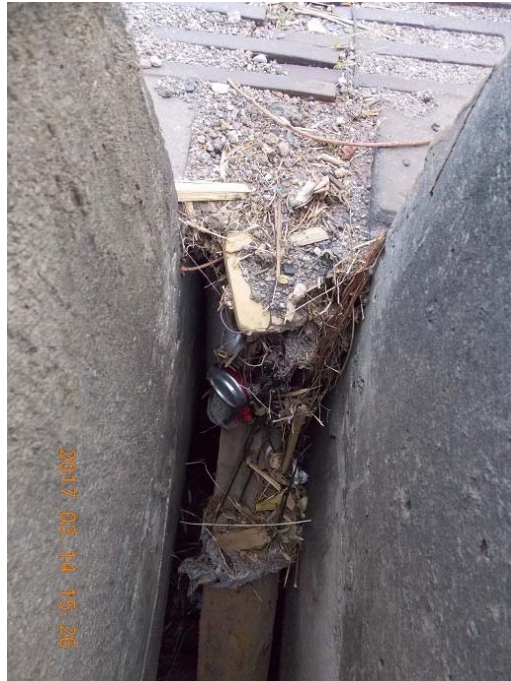
Figura 5. Obstrucción por acumulación de sedimentos y basura en el drenaje de la junta de expansión
