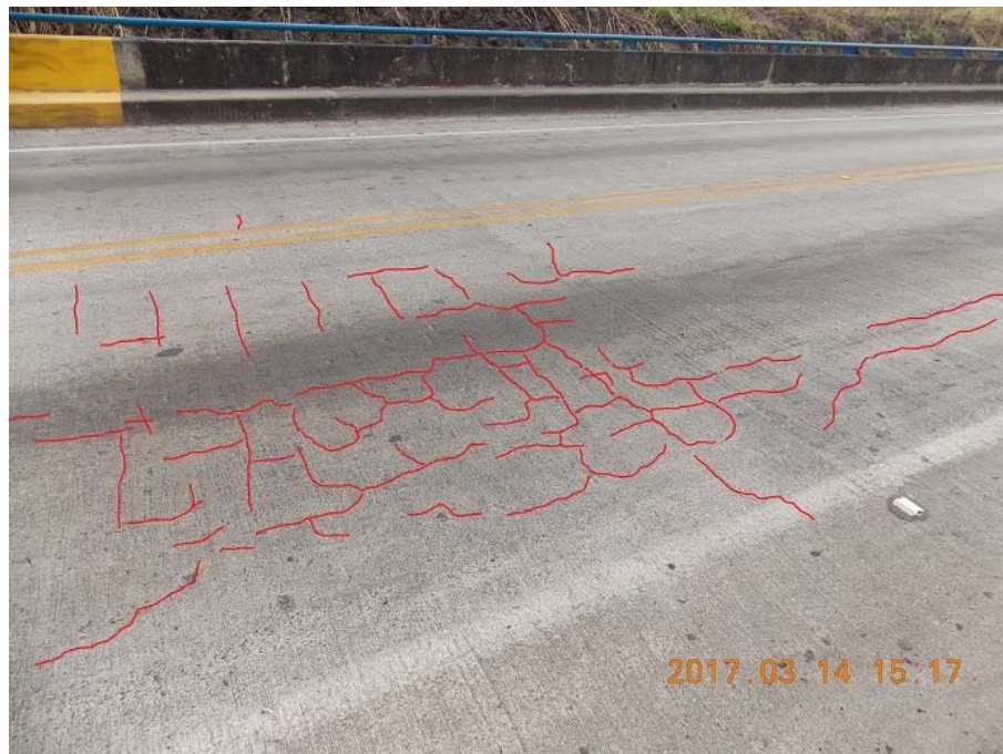
Figura 10. Agrietamiento en dos direcciones en la cercanía del acceso 1
