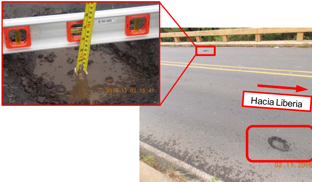
Figura 4. Superficie de rodamiento asfáltica de aproximadamente 60 mm de espesor sobre el tablero del puente, así como dos baches, uno en cada sentido de circulación.
