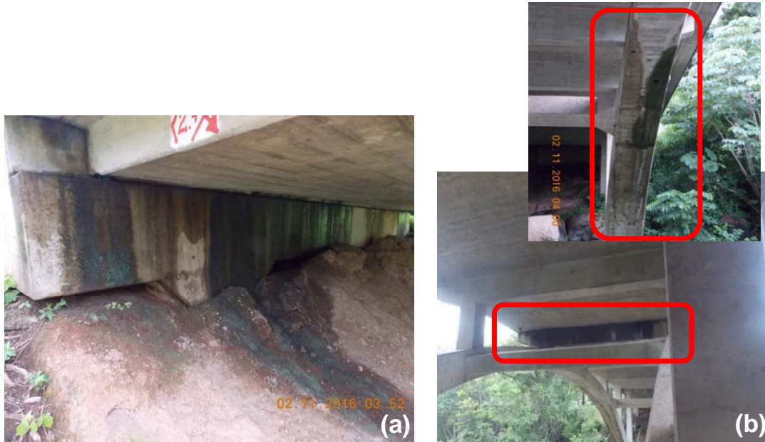
Figura 7. Filtración de agua a través de las juntas de expansión: (a) Caso de la junta en el bastión B2; (b) Caso de la junta en la columna 3 del arco.
