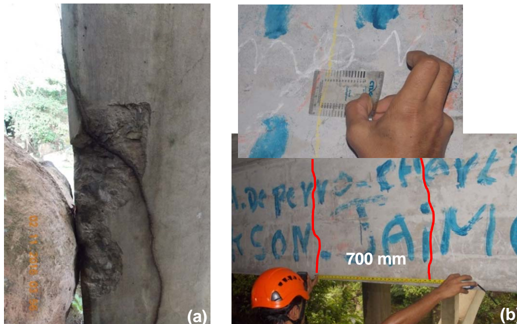
Figura 11. Pilas: (a) Pérdida de recubrimiento debido a impacto de una roca en columna noreste de pila P3; (b) Agrietamiento en vigas cabezales con un ancho de 0,2 mm y separación de 700 mm.
