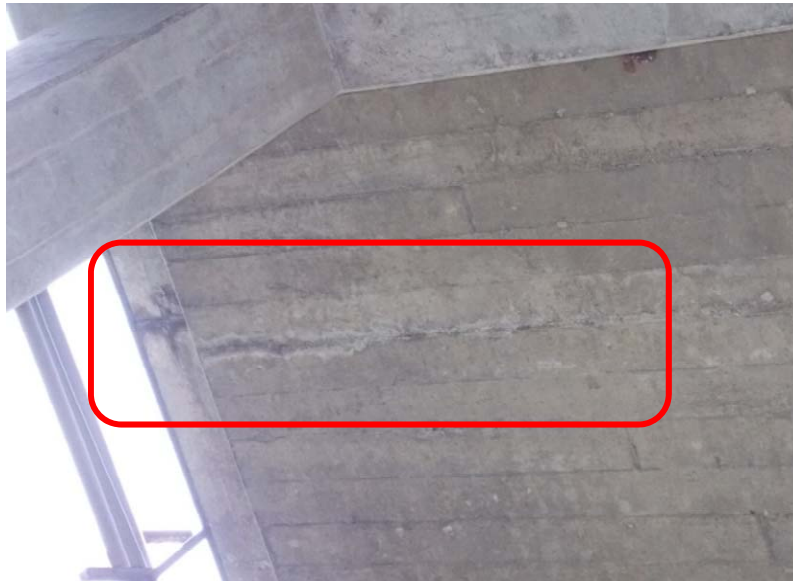
Figura 9. Losa de concreto de la superestructura 2: Agrietamiento transversal con evidencia de eflorescencia.
