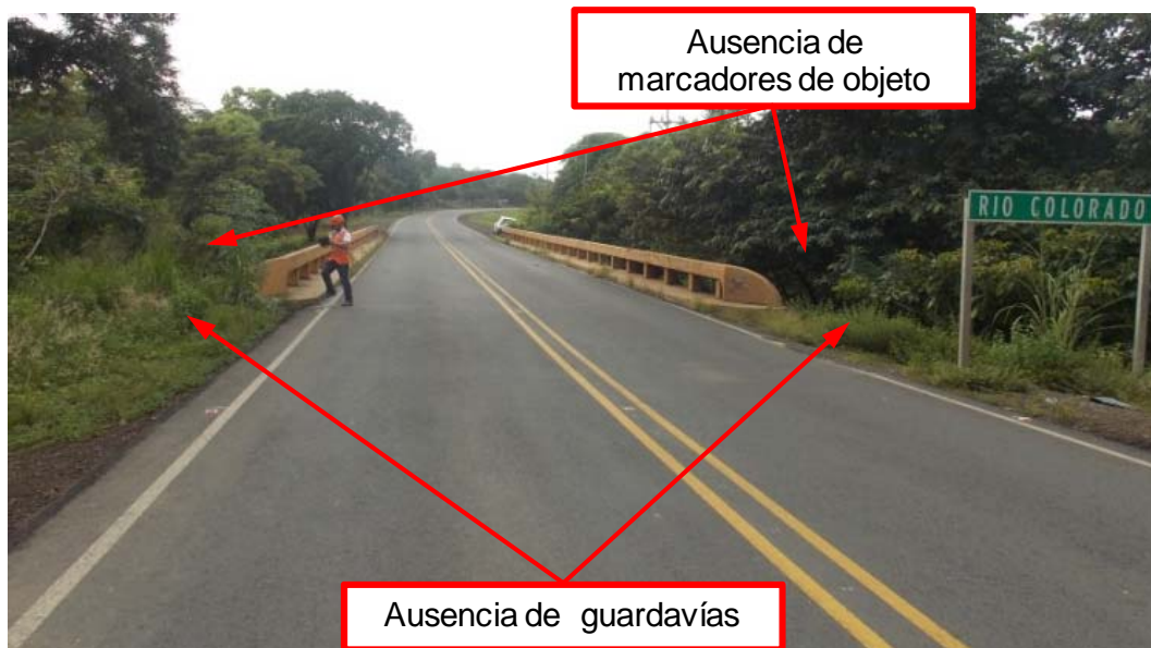
Figura 2. Ausencia de marcadores de objeto y guardavías en ambos accesos, caso del acceso 1.
