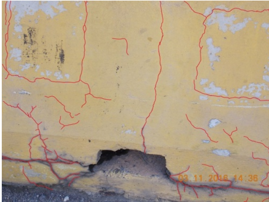
Figura 1. Patrón de agrietamiento observado en la barrera vehicular
