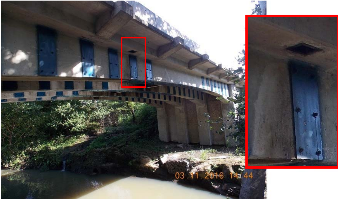
Figura 3. Ductos de drenaje sin tubos de extensión
