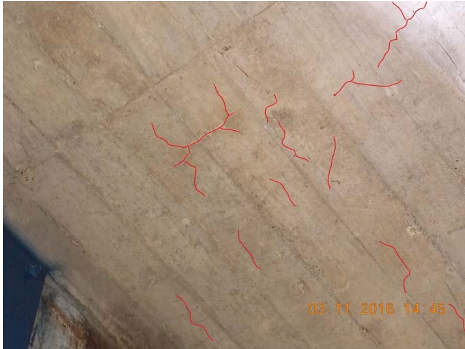
Figura 5. Patrón de agrietamiento observado en la cara inferior del tablero
