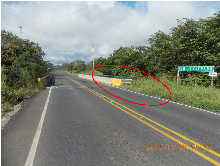
Figura 2. Ausencia de guardavías y de marcadores de objeto
