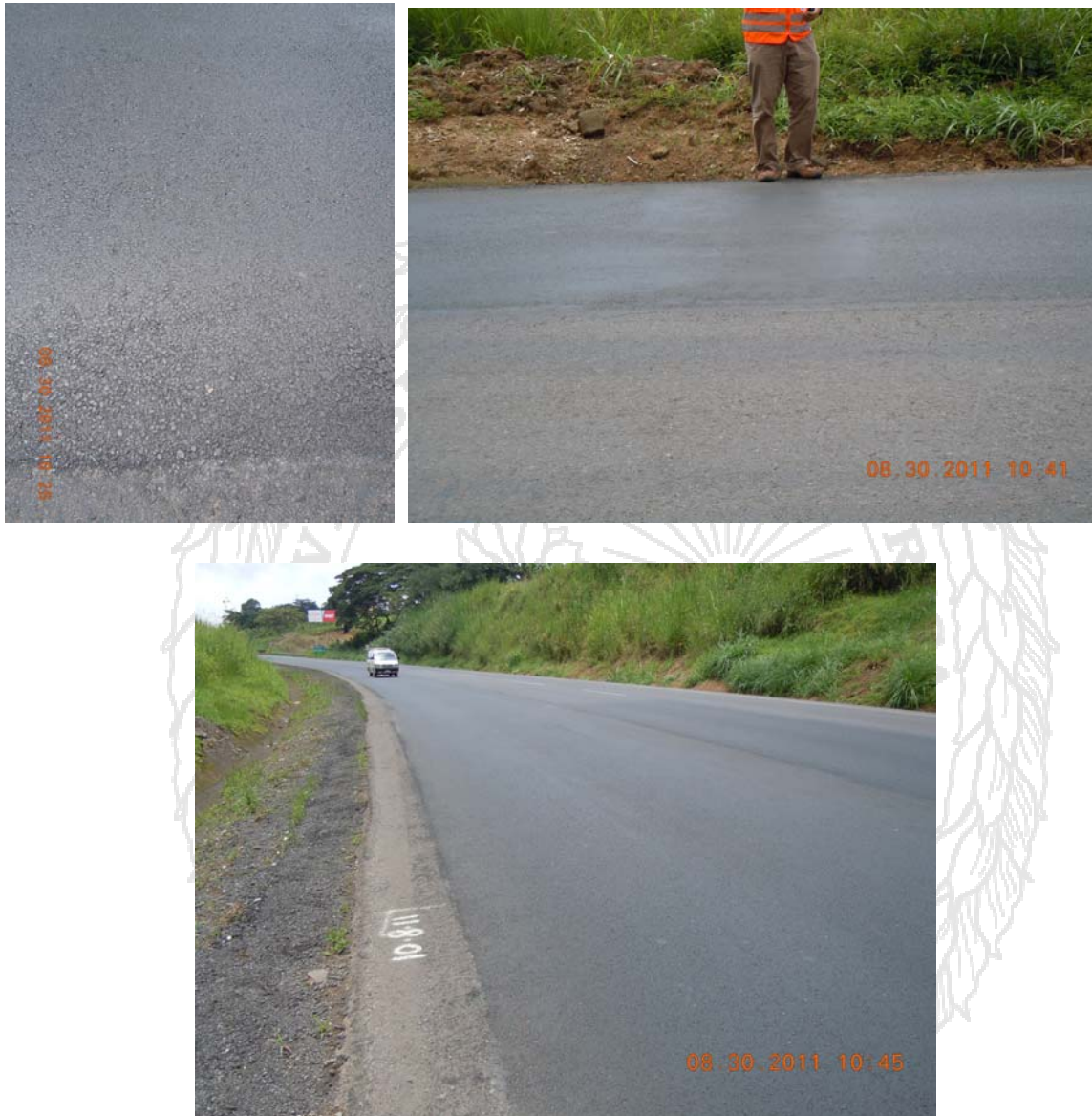
Fotografía 1. Exudación encontrada en tramos de las capas asfálticas colocadas. El caso de las fotografías corresponde a la capa asfáltica colocada el 10 de agosto del 2011. Fecha de fotografías: 30 de agosto 2011. Estacionamiento 39+500 (aproximadamente 700m antes de cruce a San Ramón) Fuente: Auditoría Técnica, LanammeUCR
