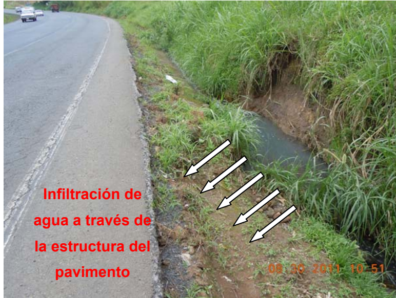
Fotografía 6. Condición de las cunetas. Fecha 30 de agosto 2011. Estacionamiento 39+400. Fuente: Auditoría Técnica, LanammeUCR
