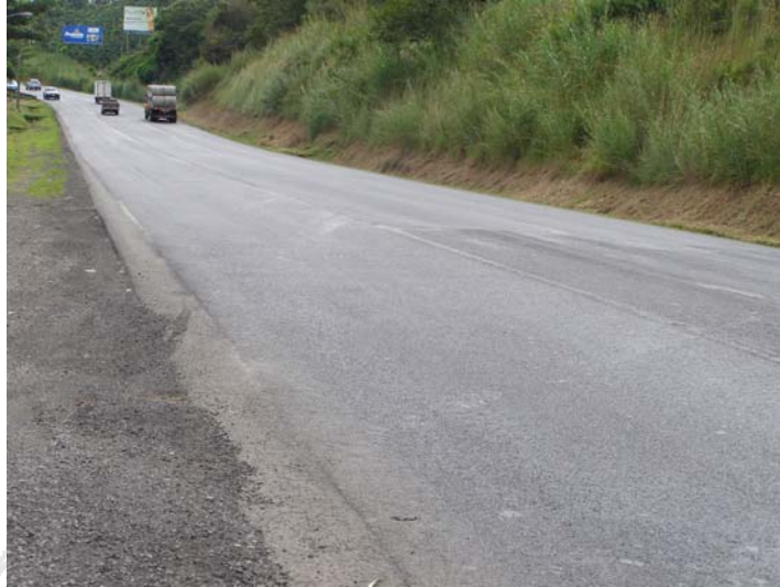
Fotografía 13. Tramos sin demarcación vial.
