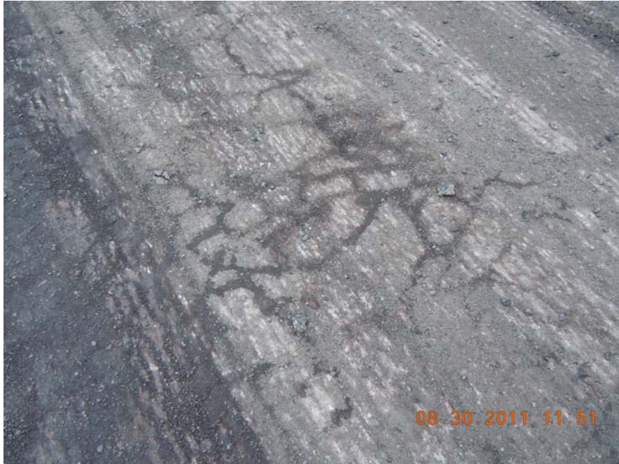
Fotografía 4. Condición de la superficie luego del perfilado sobre la cual se colocó la capa nueva. Sitio ubicado 100m hacia San José del cruce a Palmares. Fecha 30 de agosto 2011. Fuente: Auditoría Técnica, LanammeUCR
