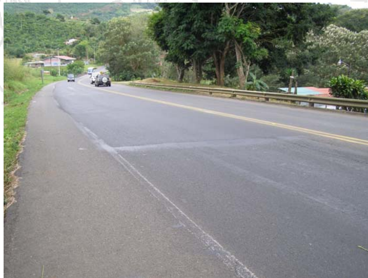
Fotografía 12. Tramos con demarcación parcial. Estacionamiento 39+300. Fechas: 3 de noviembre del 2011. Fuente: Auditoría Técnica, LanammeUCR
