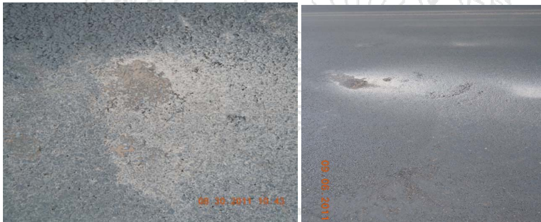
Fotografía 7. El agua asciende con finos de la base a la superficie por efecto de las cargas. Fecha 30 de agosto 2011. Estacionamiento 39+350. Fuente: Auditoría Técnica, LanammeUCR
