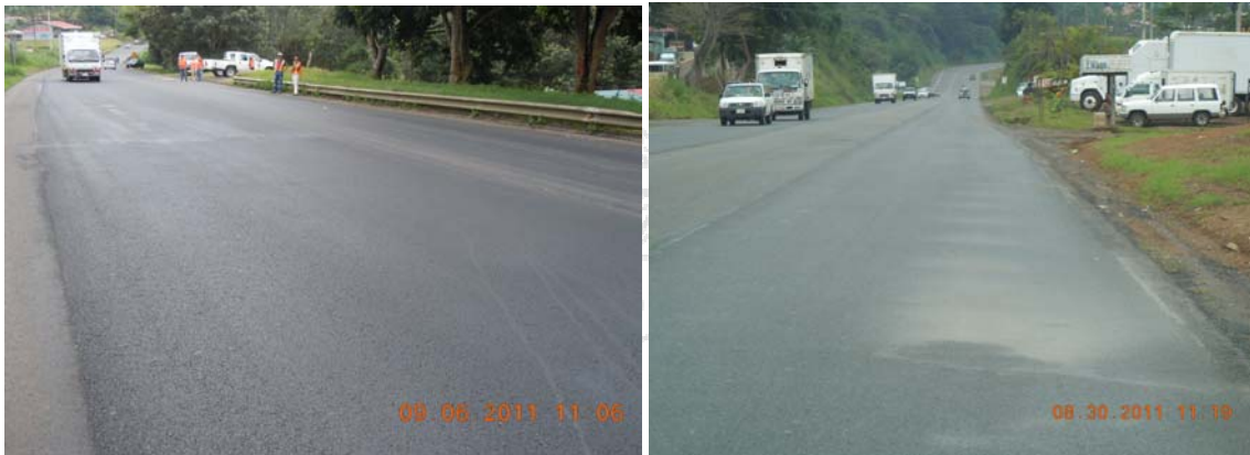
Fotografía 11. Tramos sin demarcación. Estacionamientos 39+300 y 38+000. Fechas: 6 de setiembre y 30 de agosto respectivamente. Fuente: Auditoría Técnica, LanammeUCR
