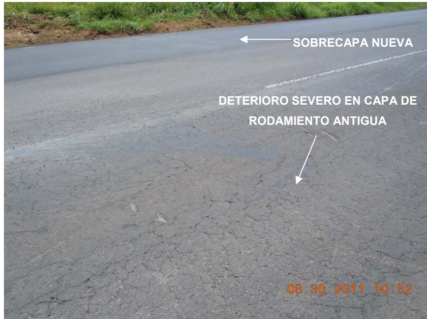
Fotografía 3. Sustrucción de capa de rodamiento aun lado. Superficie fatigada en sentido hacia San Ramón.
