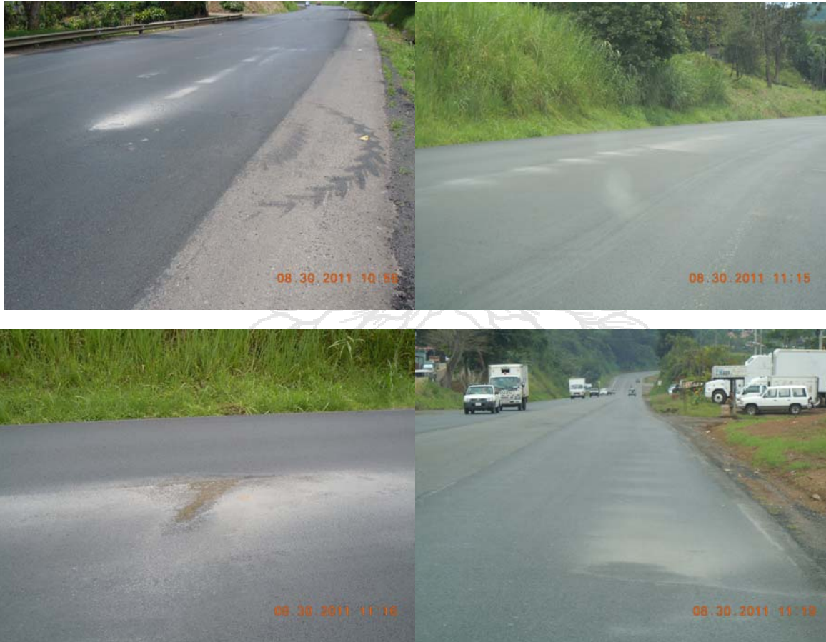
Fotografía 2. Sitios con agrietamiento y bombeo de finos y agua de la base. Fecha 30 de agosto 2011. Estacionamientos 39+300, 39+000, 38+800 y 38+000 Fuente: Auditoría Técnica, LanammeUCR
