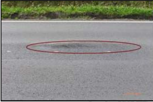
Fotografía 4. Presencia de agua en la mezcla asfáltica colocada un mes antes.
