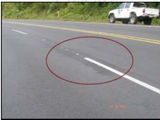
Fotografía 6. Presencia de agua en la mezcla asfáltica colocada un mes antes.
