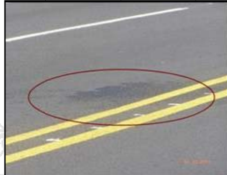
Fotografía 5. Presencia de agua en la mezcla asfáltica colocada un mes antes.
