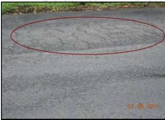
Fotografía 40. PK: 13+000, sentido hacia limón, fisuras en capa asfáltica.
