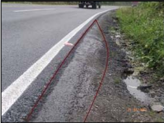
Fotografía 8. Afloramiento de agua punto más bajo del peralte.
