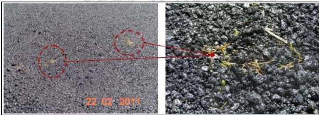
Fotografía 19. Materia vegetal en la capa asfáltica recién colocada.
