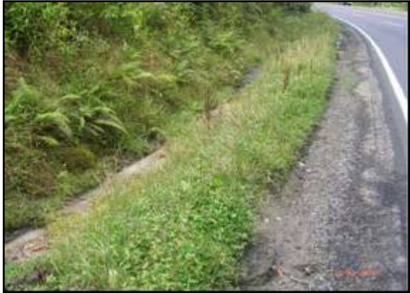
Fotografía 28: materia vegetal en la cuneta que impide el flujo del agua.
