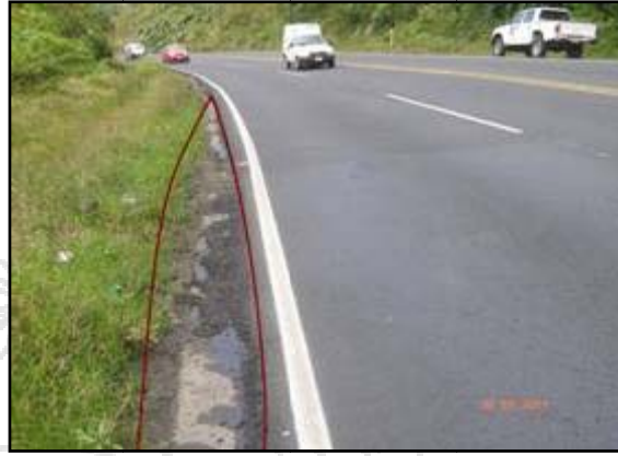
Fotografía 9. Afloramiento de agua punto más bajo del peralte.
