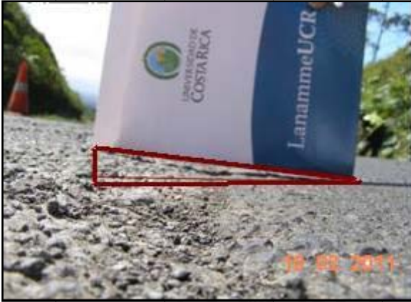
Fotografía 24. Acabado irregular durante el proceso constructivo.
