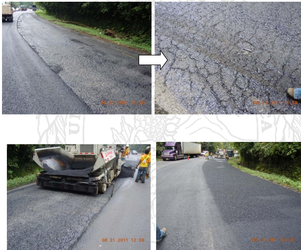
Fotografía 33. Deterioro existente antes de la colocación de la sobrecapa, 2km antes del puente sobre el Río Sucio.
