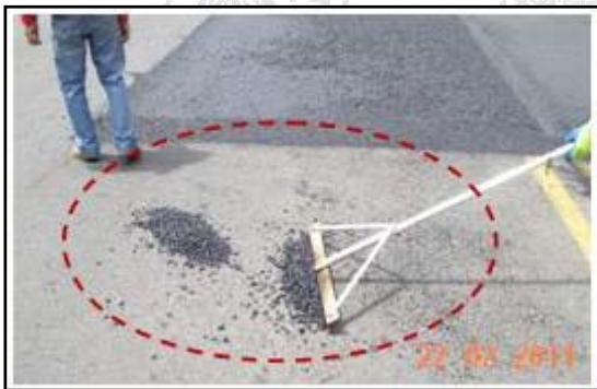
Fotografía 17. Mezcla con granulometría alterada. Esta es la que sobra luego de reparar la junta.
