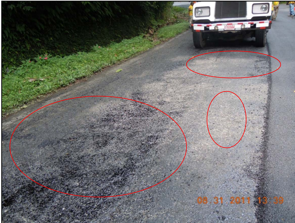
Fotografía 35: zonas sin emulsión y otras con concentraciones evidentes que dejan ver la falta de homogeneidad.
