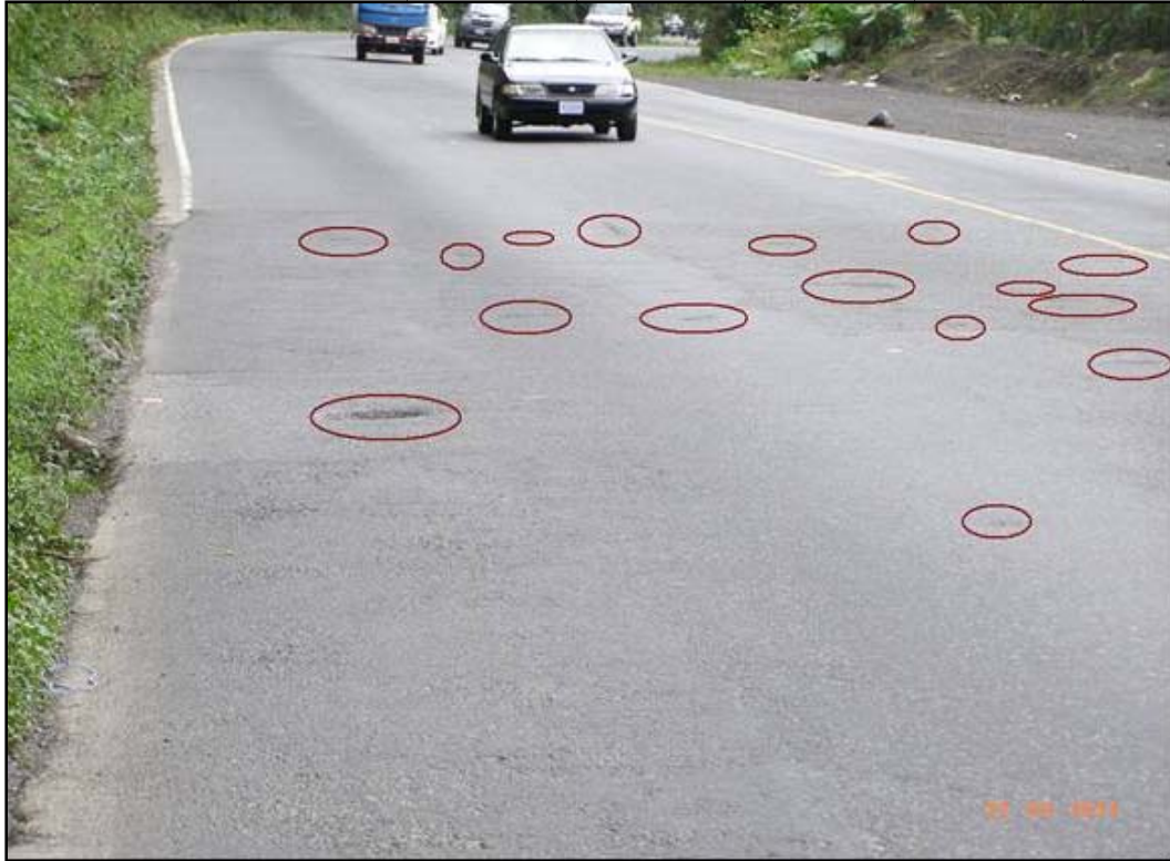
Fotografía 43. PK: 7+700, sentido Limón- San José, tramo aproximadamente de 50 mts ubicado en una curva con huecos y baches deformados, área sin intervenir.
