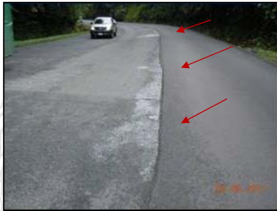
Fotografía 42. PK: 12+000, sentido hacia limón, faltó completar capa asfáltica durante varios meses y se observaba afloramiento de agua.
