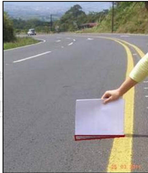
Fotografía 25. Acabado irregular del borde de la capa recién colocada.
