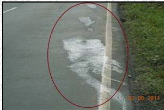
Fotografía 41. PK: 13+300, sentido hacia San José, afloramiento en capa asfáltica.
