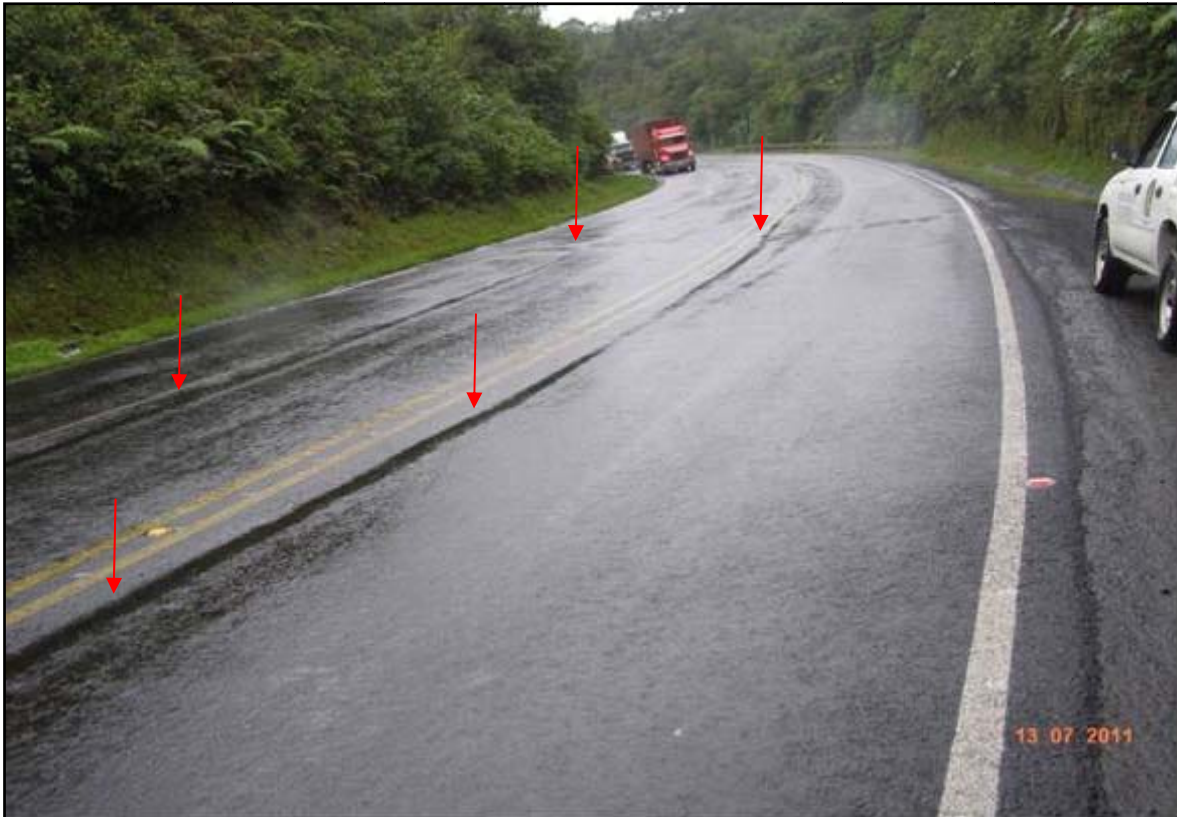
Fotografía 23. Empozamiento en juntas, evidencian una discontinuidad de peralte transversal.
