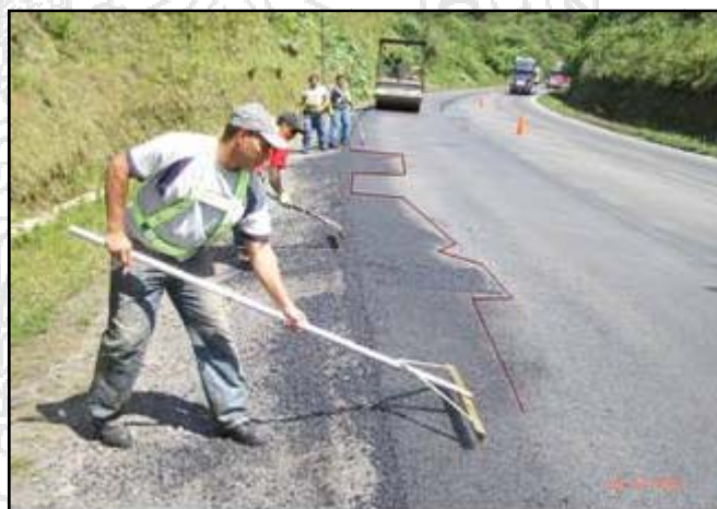
Fotografía 16. Superficie de capa asfáltica en reparación debido al problema del distribuidor de mezcla.
