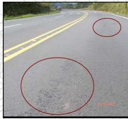
Fotografía 7. Presencia de agua en la mezcla asfáltica colocada un mes antes.
