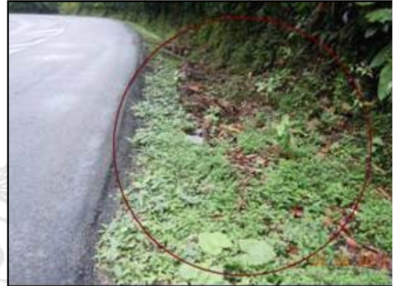
Fotografía 29: material vegetal en la cuneta que impide el flujo del agua.
