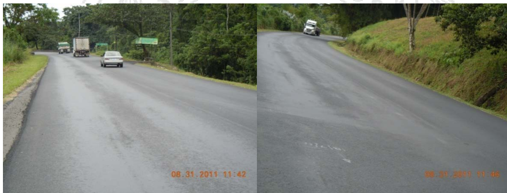
Fotografía 4. Tramo exudado, 700m hacia Limón del cruce con Ruta Nacional No.4. Fuente: Auditoría Técnica, LanammeUCR
