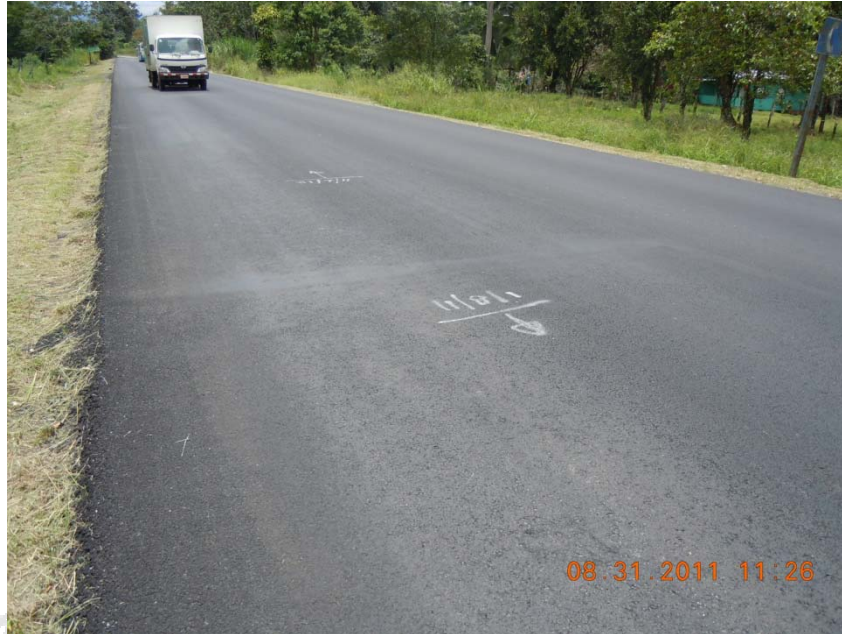
Fotografía 9. Tramos con las sobrecapas asfálticas colocadas permanecen sin demarcación. Fuente: Auditoría Técnica, LanammeUCR
