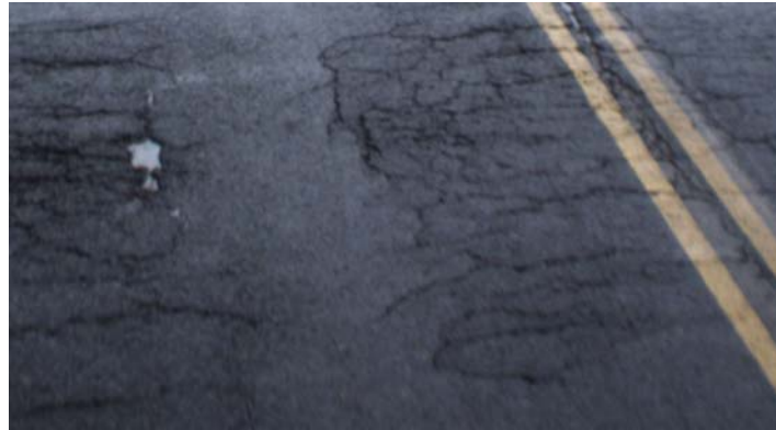
Fotografía 6. Deterioro encontrado en abril 2011 antes de la colocación de la sobrecapa, después del puente sobre el Río Corinto, sentido San José- Limón. Fuente: Unidad de la Evaluación de la Red Vial Nacional, LanammeUCR
