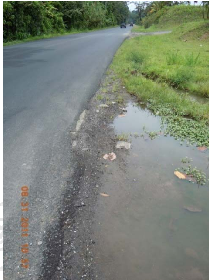
Fotografía 8. Acumulación de agua al borde de la sobrecapa colocada. Fuente: Auditoría Técnica, LanammeUCR
