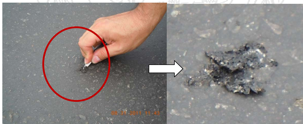
Fotografía 5. Tramo exudado, 700m hacia Limón del cruce con Ruta Nacional No.4. Fuente: Auditoría Técnica, LanammeUCR
