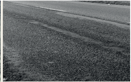
b. Desprendimiento de partículas
