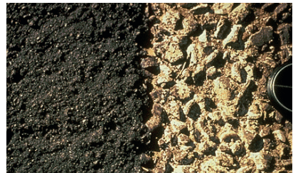
a. Pavimento oxidado
