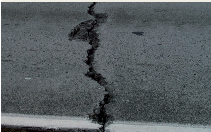
c. Agrietamiento transversal con desprendimiento de borde
