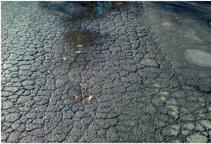
a. Agrietamiento severo
