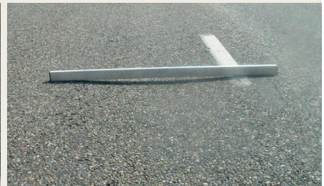
d. Ahuellamiento severo
