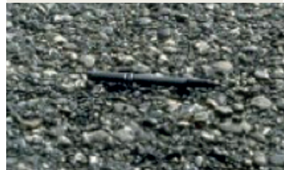
b. Desprendimiento de partículas
