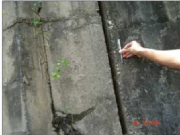
Figura A-4. Grieta vertical en la unión entre el muro cabezal y los aletones
