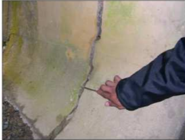
Figura A-3. Grietas en la tubería principal de una alcantarilla
