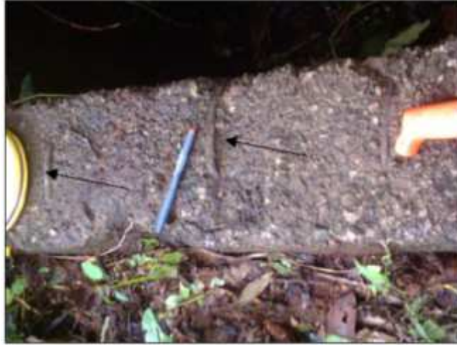
Figura A-5. Exposición del acero de refuerzo en un muro de cabezal
