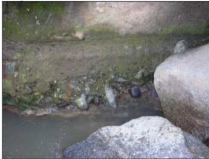
Figura A-6. Socavación del aletón de la alcantarilla
