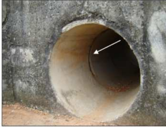
Figura A-1. Pérdida de mortero de pega en la unión de la tubería
