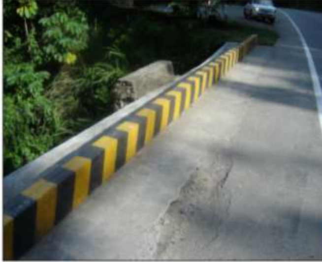
Figura A-13. Desportillamiento
