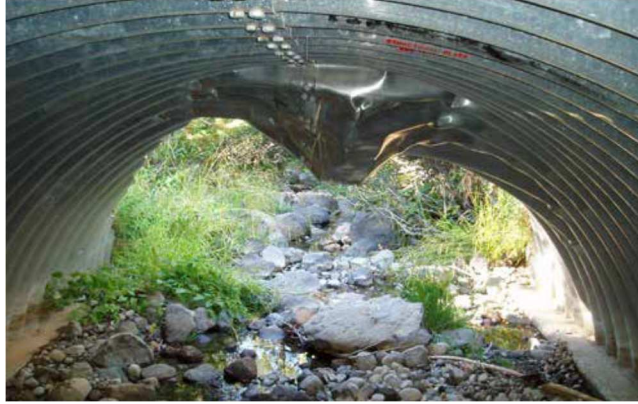
Figura A-9. Colapso de tubería metálica corrugada
