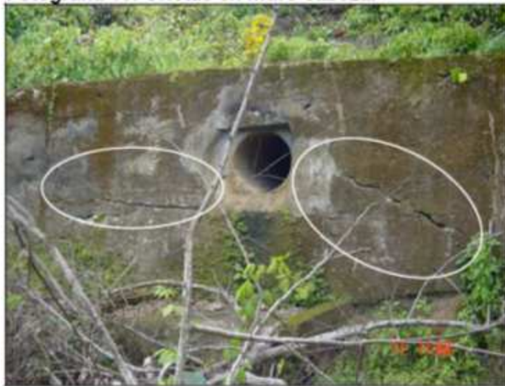
Figura A-2. Grietas en muro de cabezal
