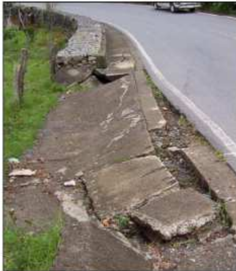
Figura A-14. Fracturamiento del revestimiento
