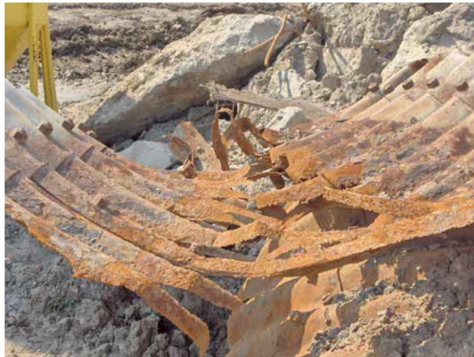
Figura A-8. Pérdida de sección de alcantarilla metálica corrugada debido a corrosión
