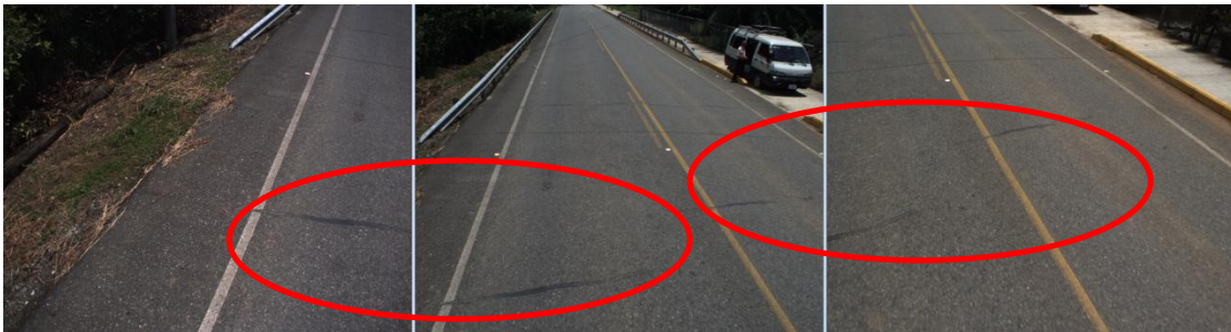
Figura 11: Grietas transversales, est. 52+070
