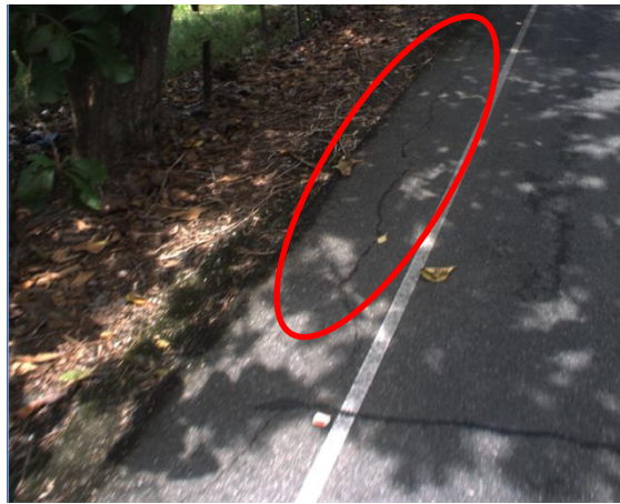
Figura 14: Grieta de borde, est. 68+760
