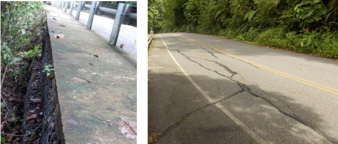
Figura 10: Muro de gaviones y agrietamiento severo en la carpeta asfáltica, est. 42+600
