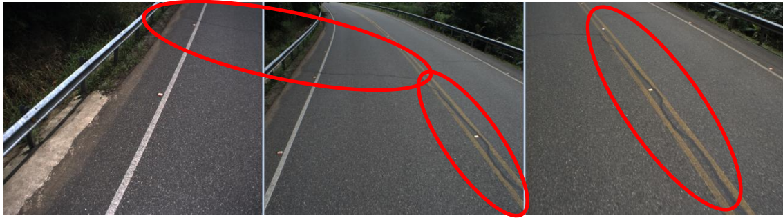
Figura 13: Grietas transversales y longitudinal, est. 60+130
