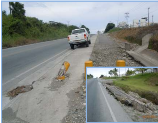
Tramo Estación 1+265 a 1+300 (17-ago-2011) Reinicia ciclovía, con socavada por erosión.
