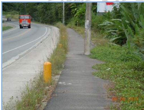
Estación 0+360 (06-jun-2011) Postes que obstruye el paso de ciclistas.
