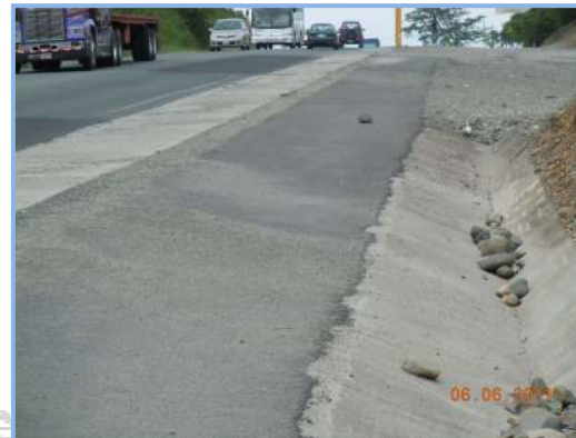
Estación 1+380 (06-jun-2011) Ciclovía sin señalización.
