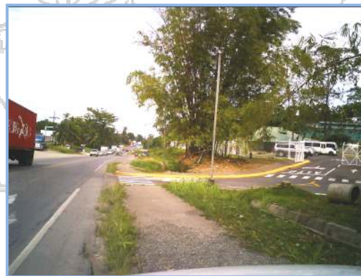
Estación 3+750 (17-ago-2011), Obras de acera con cierto grado de deterioro.
