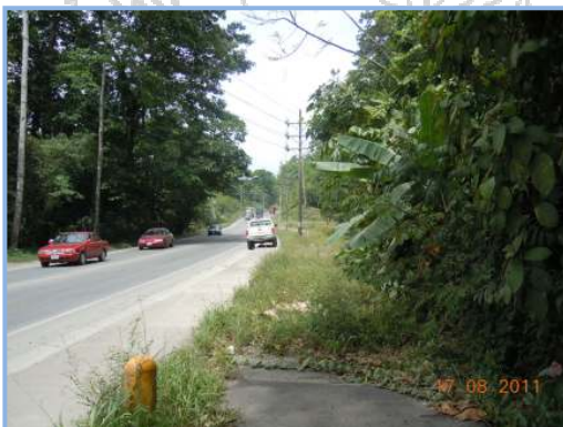
Estación 0+500 (17-ago-2011) Se interrumpen obras de ciclovia.
