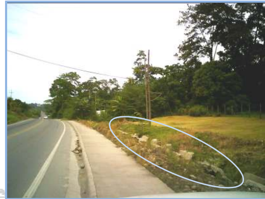
Estación 2+540 (17-ago-2011) Cuneta sin terminar con cierto grado de deterioro.
