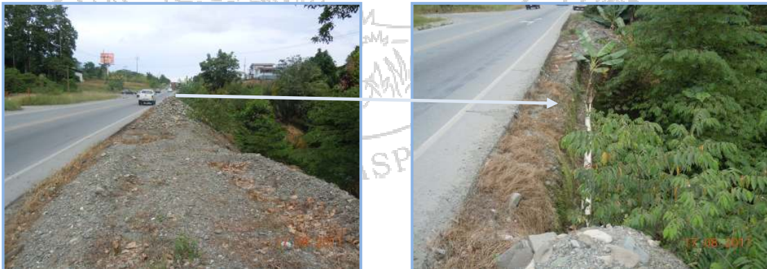
Fotografías N° 5: Estación 1+200, Falta señalización en zonas donde el peatón o ciclista deben desplazarse por la calle.
