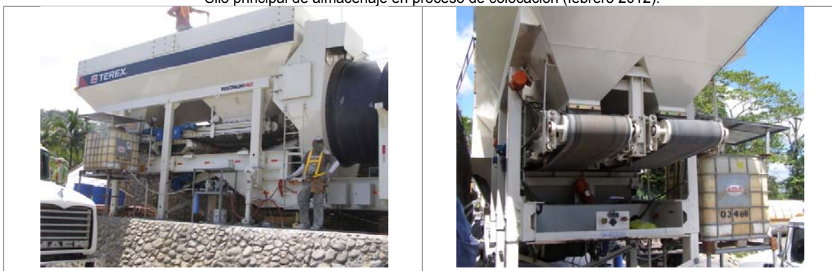
Fotografía 2 Tolvas de dosificación de agregados.
