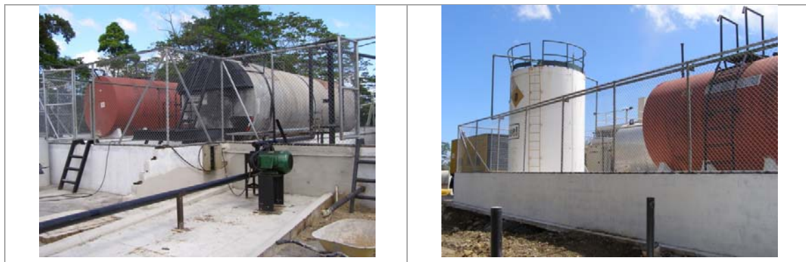
Fotografía 6 Tanques de almacenamiento de cemento asfáltico, combustibles y otros.
