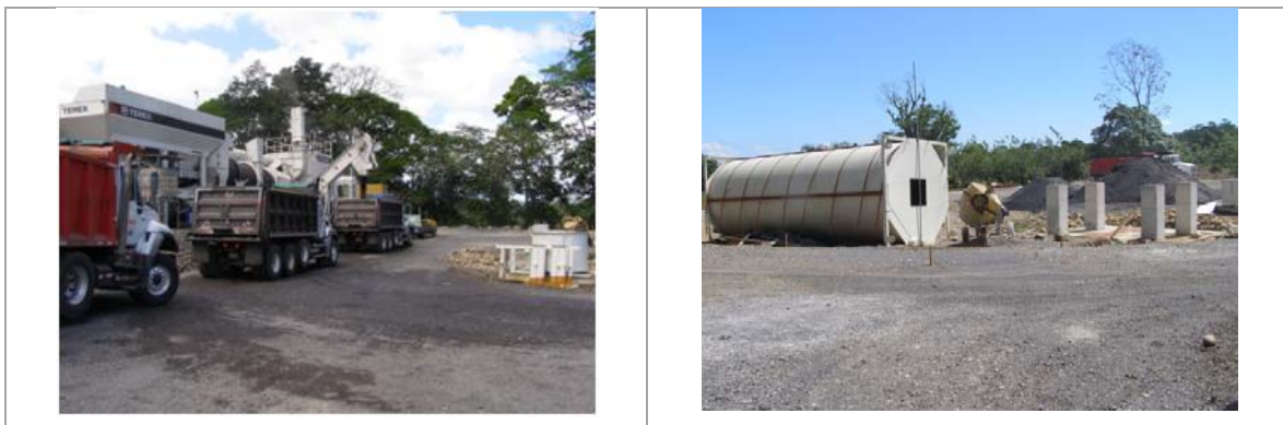
Fotografía 1 Descarga de mezcla asfáltica producida. Silo principal de almacenaje en proceso de colocación (febrero 2012).
