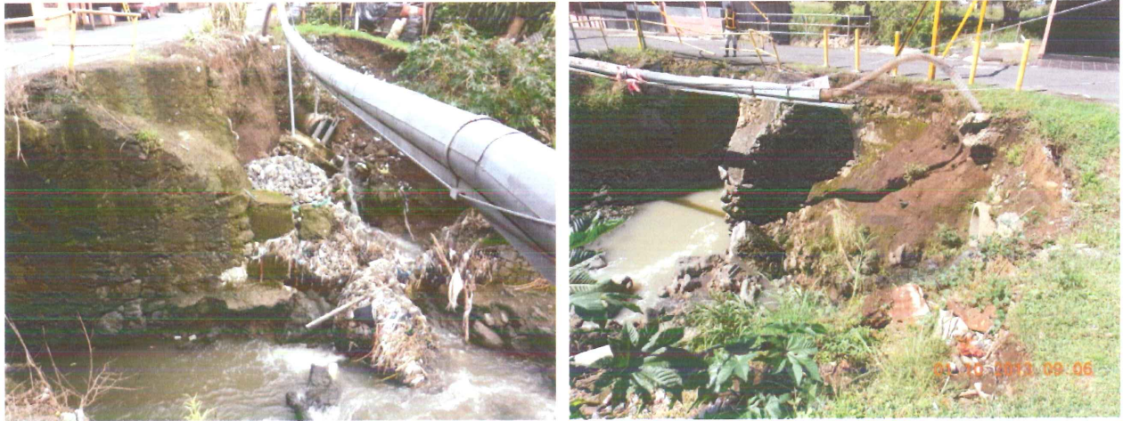
Fotos 3 y 4: Deslizamiento en relleno de aproximación Enero 2011 y Octubre 2013
