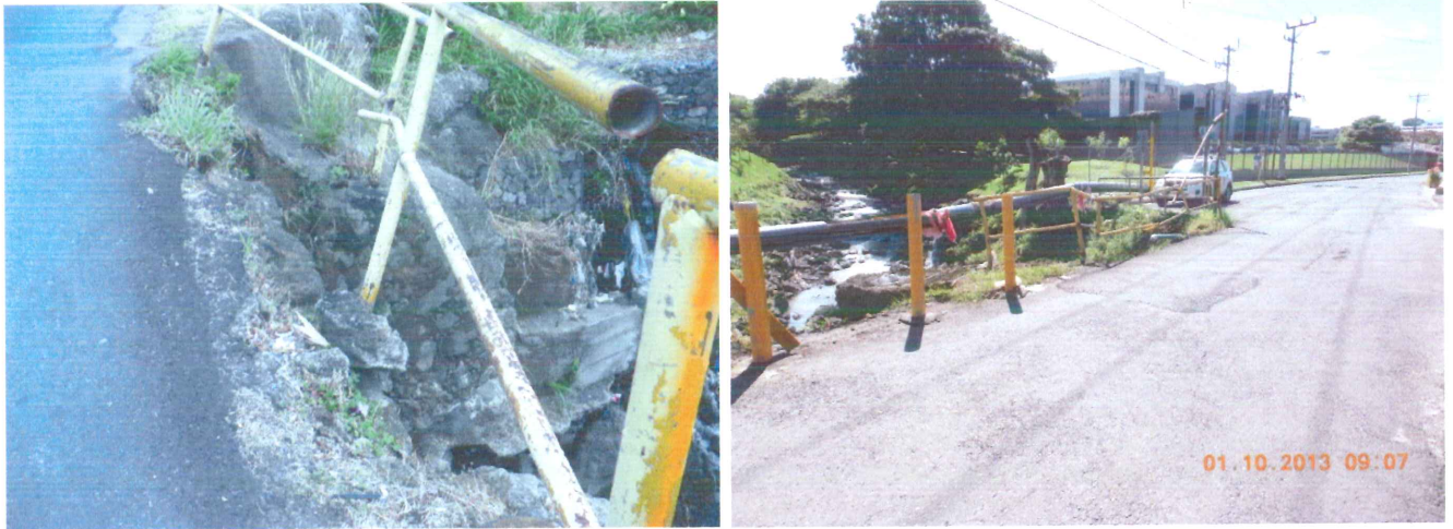
Fotos 7 y 8: Barandas en puente Cristo Rey Enero 2011 y Octubre 2013
