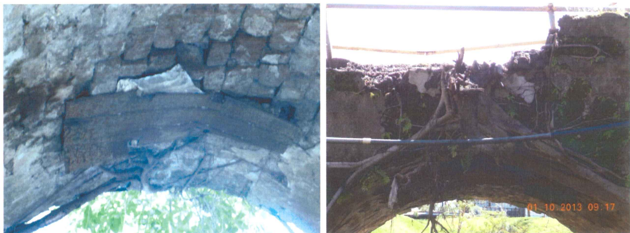
Fotos 5 y 6: Condición de la zona inferior del puente Enero 2011 y Octubre 2013
