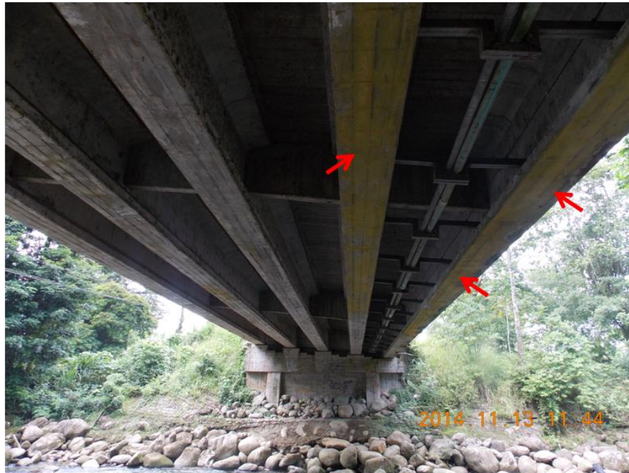
Figura 7. Manchas naranjas de gran extensión en la superficie inferior de algunos sectores de las vigas principales.
