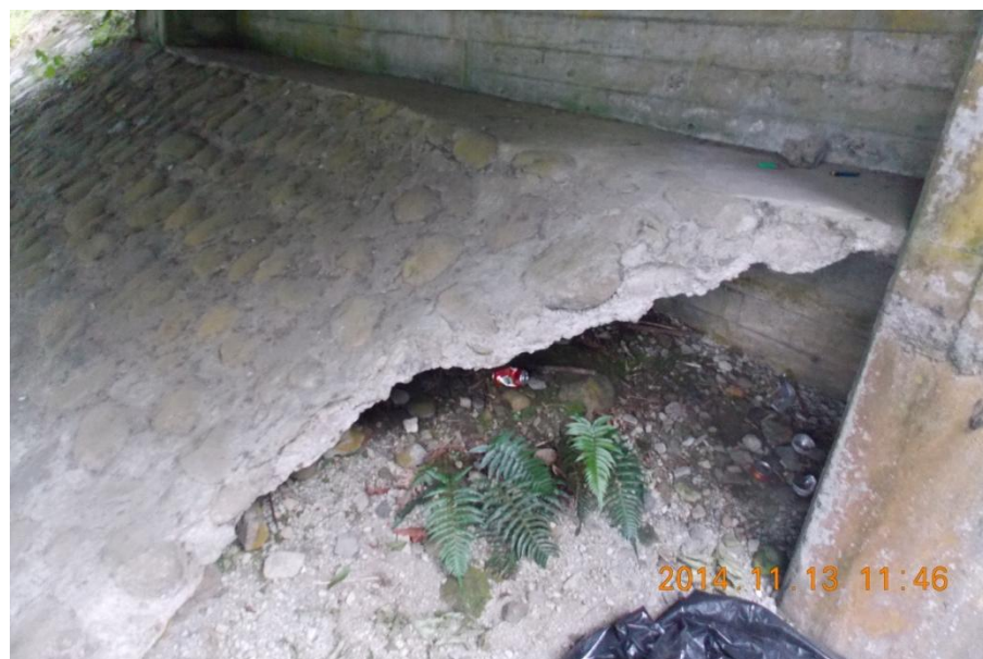
Figura 12. Fractura de la escollera en el talud frontal del bastión 1 y signos de socavación del talud.
