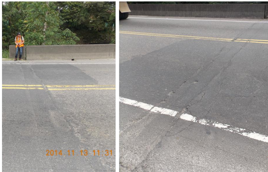
Figura 5. Obstrucción de las juntas de expansión con una sobrecapa asfáltica.
