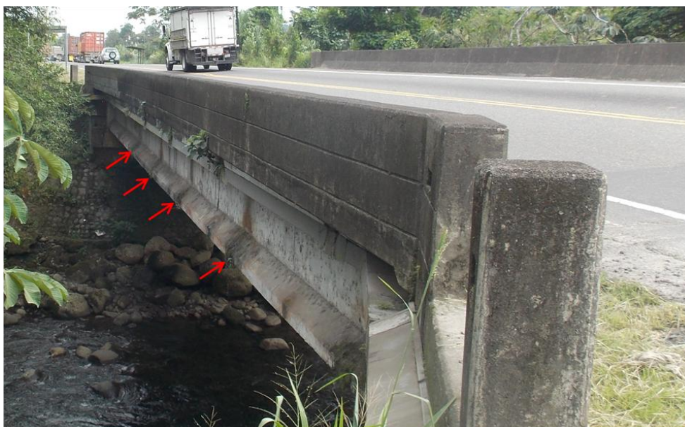
Figura 4. Manchas de humedad en las vigas exteriores provocadas por la descarga directa de agua sobre ellas.
