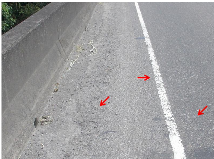
Figura 3. Demarcación horizontal en estado regular, leves desprendimientos de agregado en la carpeta asfáltica e inicio de acumulación de sedimentos en los bordillos.
