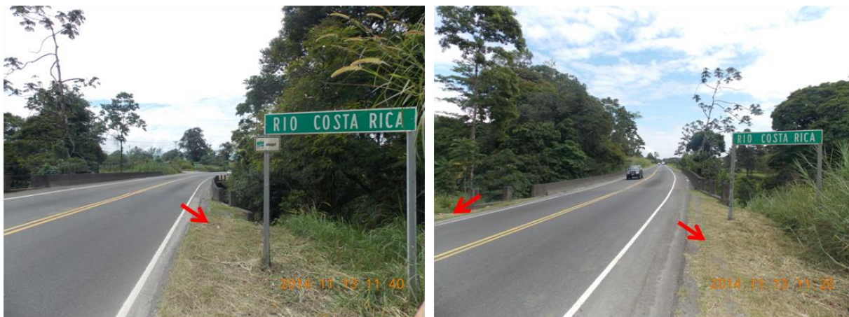
Figura 1. Ausencia de guardavías y marcadores de objetos en ambos accesos al puente.
