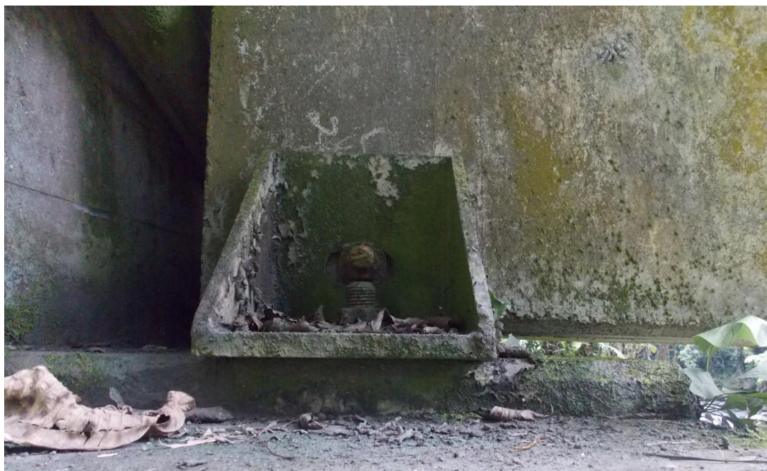
Figura 10. Deterioro del sistema de protección de pintura del mecanismo de restricción del movimiento horizontal de las vigas.
