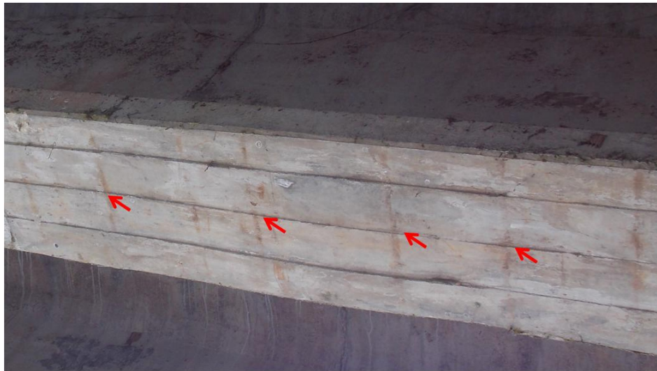
Figura 8. Franjas naranjas espaciadas aproximadamente a la misma distancia en la superficie inferior de las vigas principales.
