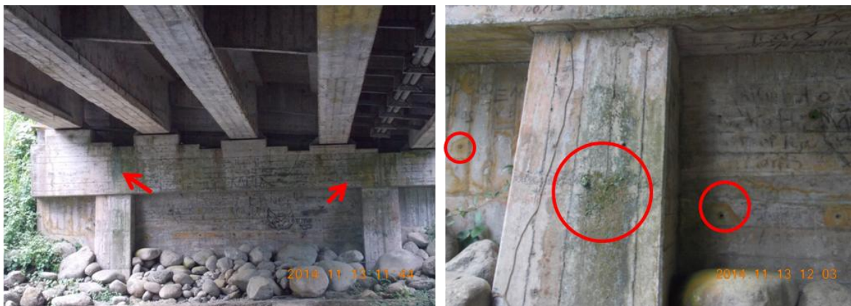
Figura 11. Manchas superficiales de color naranja en algunos sectores del bastión 2 y manchas de humedad producto del ingreso de agua a través de las juntas de expansión.
