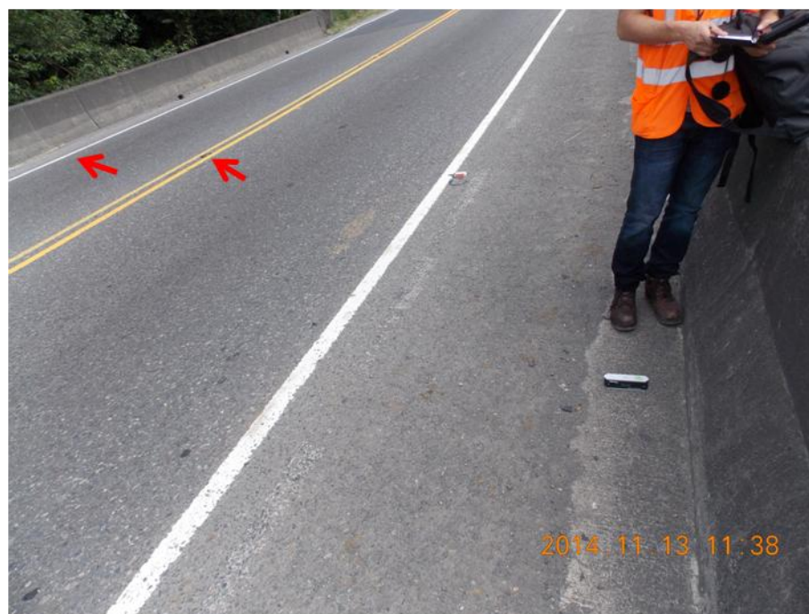
Figura 2. Ausencia de captaluces en algunas secciones del puente.
