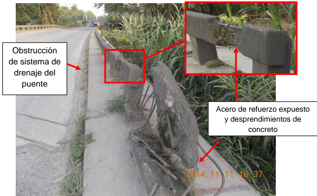
Figura 1: Daños en la barrera vehicular sur del puente, obstrucción del sistema de drenaje con sedimentos y maleza.
