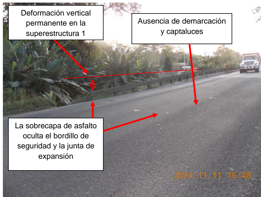
Figura 2: Deformación vertical permanente en la superestructura 1 y ausencia de señalización.
