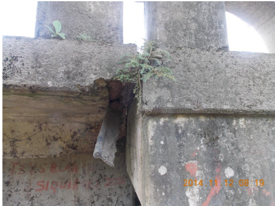
Figura 9: Sello dañando en la junta de expansión entre la superestructura 3 y el bastión 2
