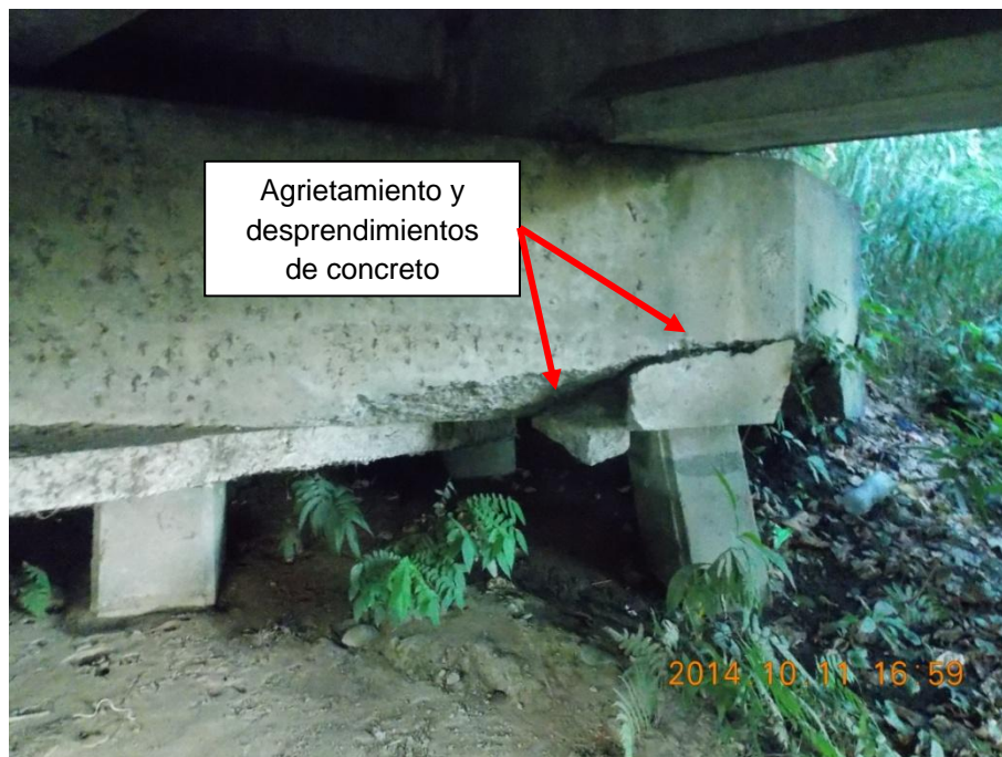
Figura 22: Detalle de desprendimientos de concreto en viga cabezal del bastión 1.
