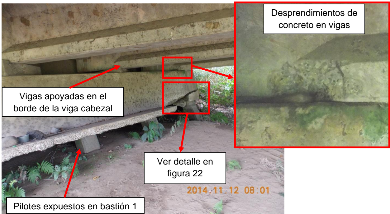
Figura 13: Daños en bastión 1 y vigas de la superestructura 1 apoyadas en el borde de la viga cabezal.
