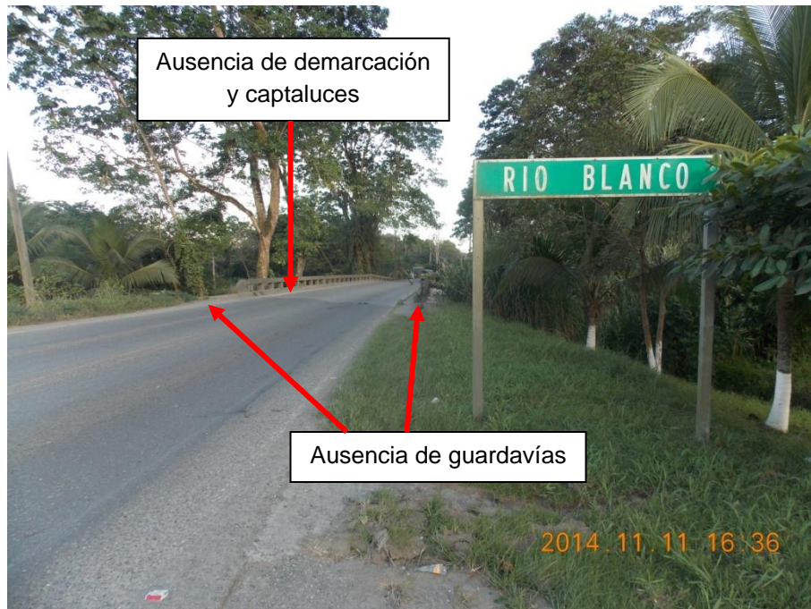
Figura 4: Ausencia de guardavías en acceso- oeste, rótulo del puente y ausencia de demarcación horizontal y captaluces.
