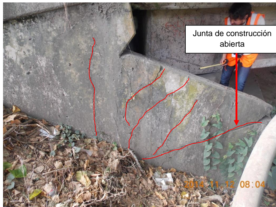
Figura 18: Agrietamiento por cortante en aletones del bastión 1.
