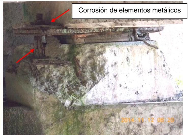
(b) Pérdida de sección por corrosión de placas y pernos en pila 2
