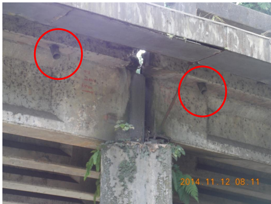
Figura 6: Ductos de drenaje sin tubos de extensión y manchas de humedad en extremos de las vigas (típico).
