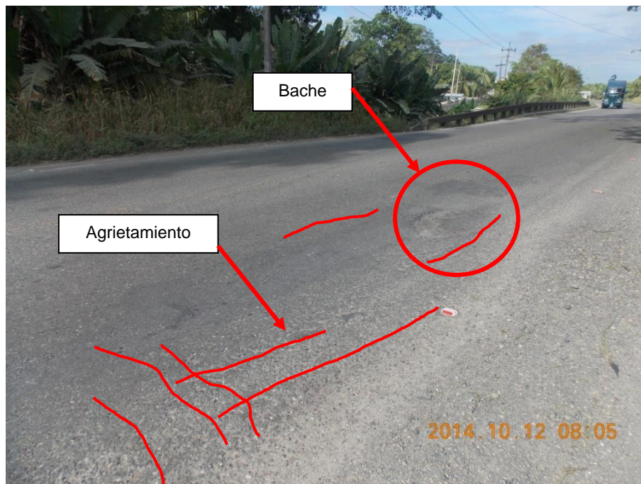
Figura 10: Daños en acceso este al puente.
