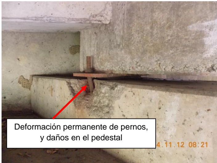
(a) Perno deformado y corroído en bastión 2
