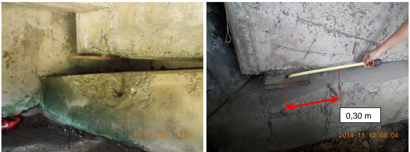
(a) Apoyo desprendido del pedestal
