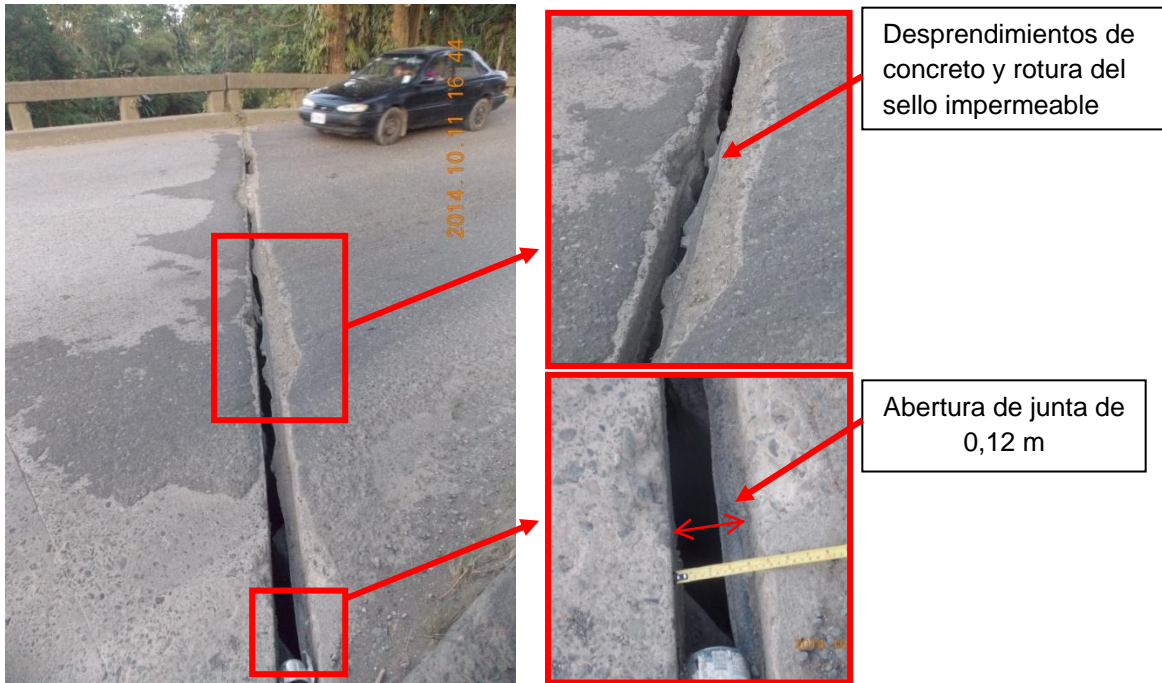
Figura 7: Daños en la junta de expansión entre las superestructuras 1 y 2
