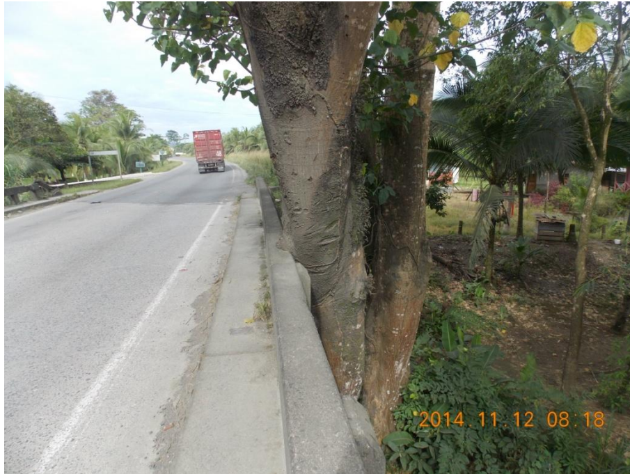
Figura 3: Árbol en contacto con la barrera del puente en la superestructura 3.
