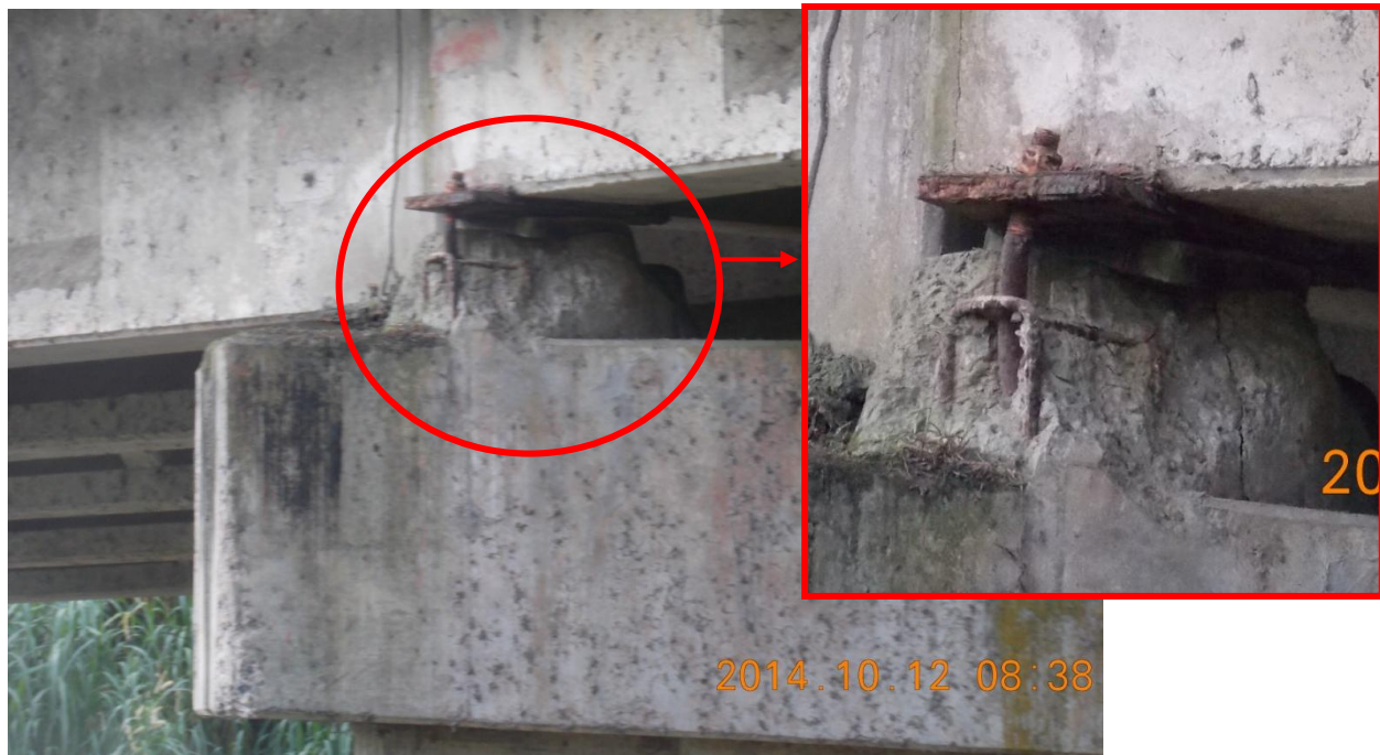
Figura 16: Reducción en la longitud de asiento en pilas debido a desprendimientos de concreto en los pedestales de los apoyos.
