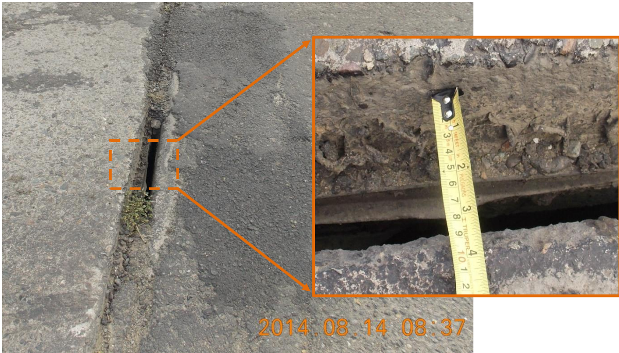
Figura 7: Junta en bastión 1 obstruida y con faltante. Abertura de unos 9 cm.
