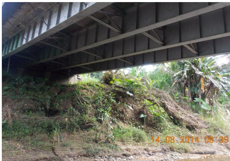
Figura 23: Ausencia de protección del talud en el Bastión 1.
