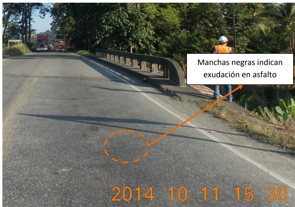
Figura 8: Exudación en el asfalto, acceso 1.
