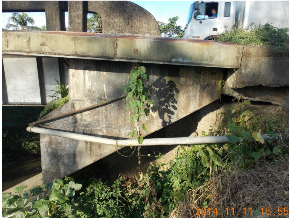
Figura 19: Socavación en aletones del bastión 2.
