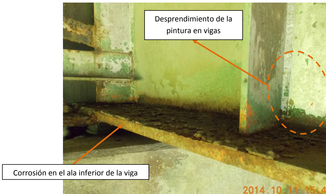
Figura 14: Corrosión en el ala inferior de las vigas principales cerca al apoyo del bastión 1.
