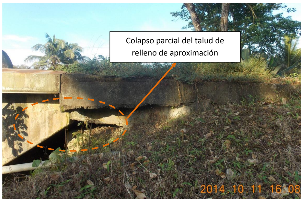
Figura 10: Colapso parcial en talud natural en el acceso 2 por socavación.
