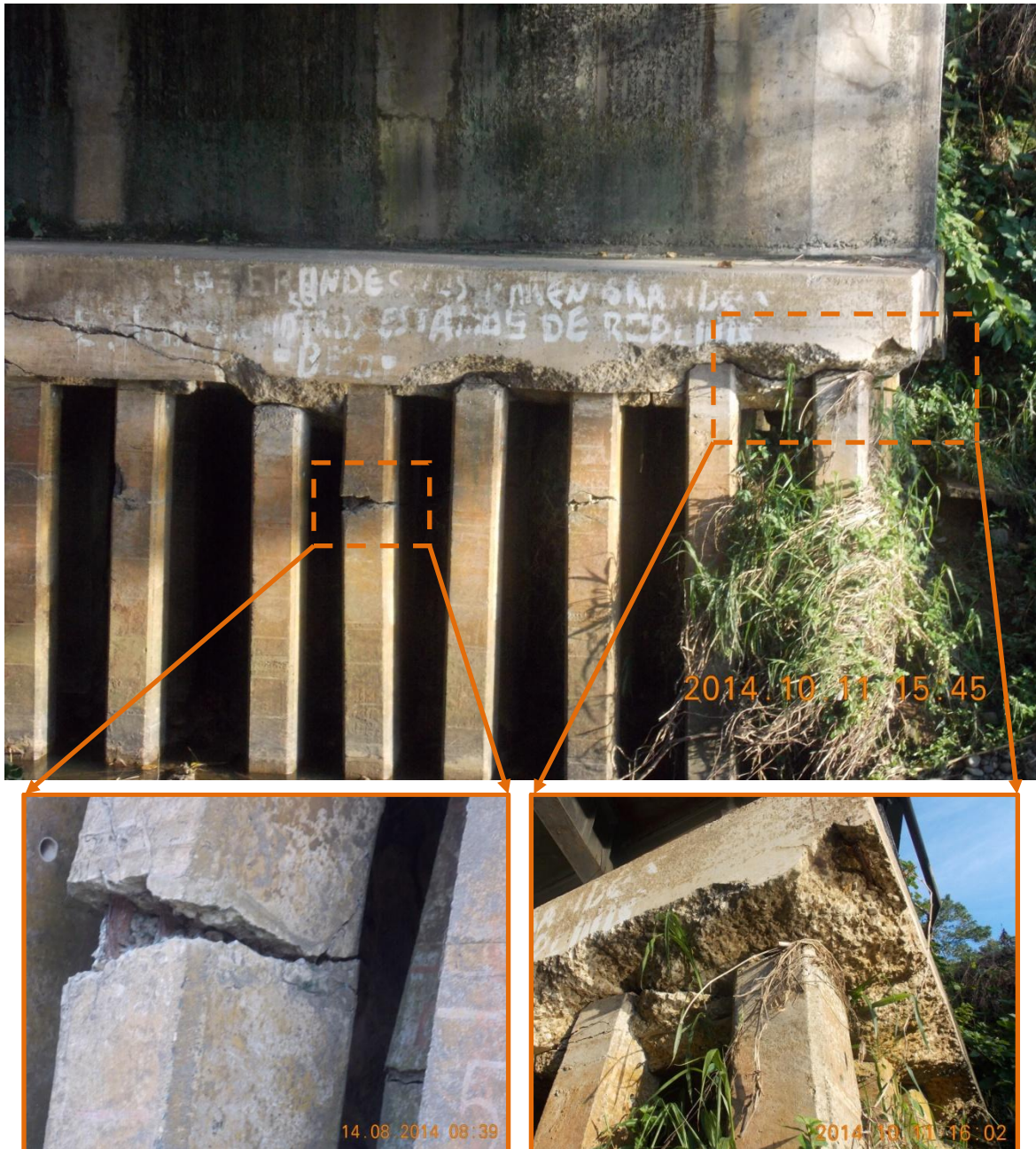
Figura 25: Daños en pilotes y cabezal de pilotes debido a rotación.
