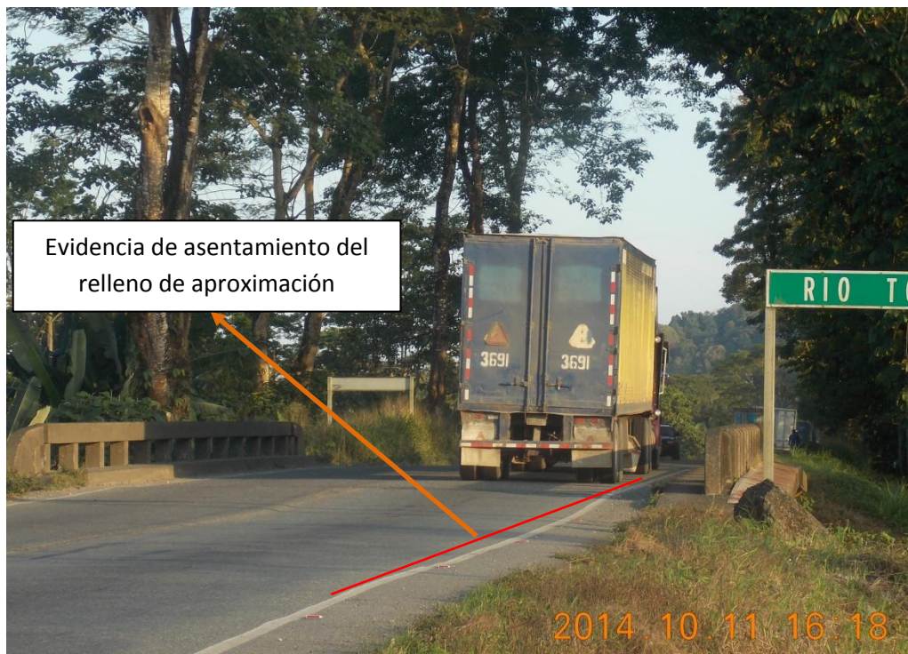
Figura 9: Asentamientos en el acceso 1 evidentes por desplazamiento vertical.
