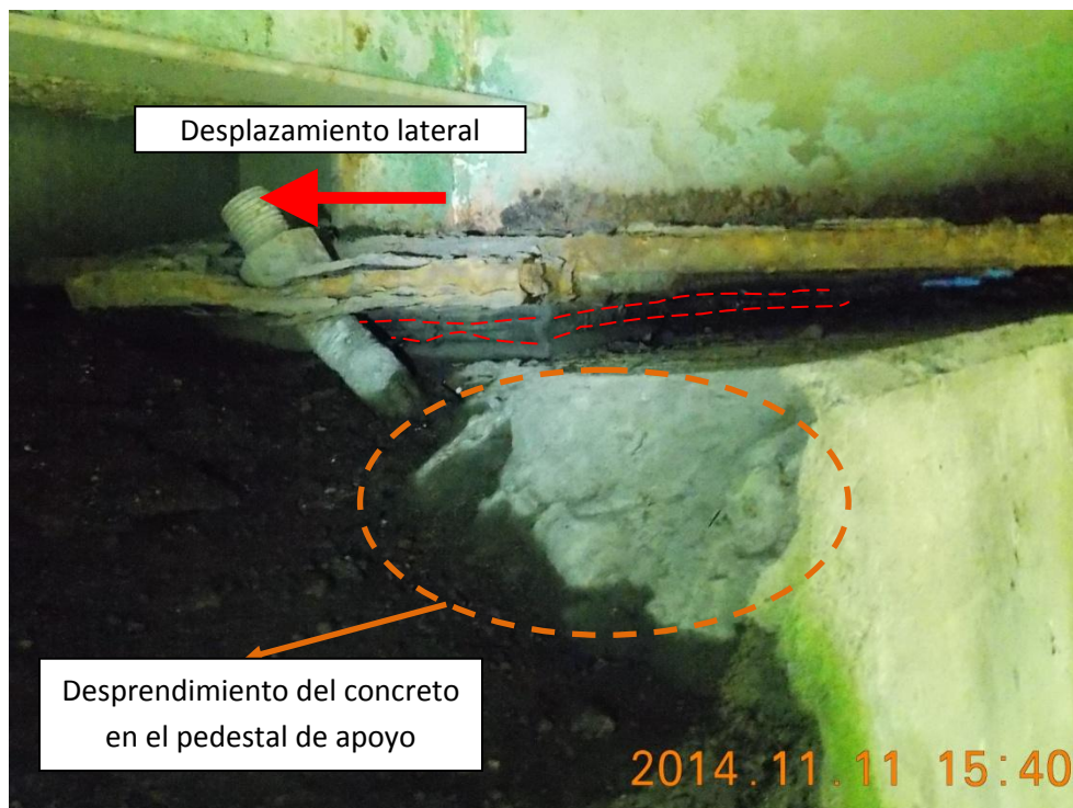
Figura 18: Desplazamientos transversales y longitudinales evidentes por deformación del perno y desprendimiento en pedestal del apoyo. Grietas horizontales en neopreno. Bastión 1.
