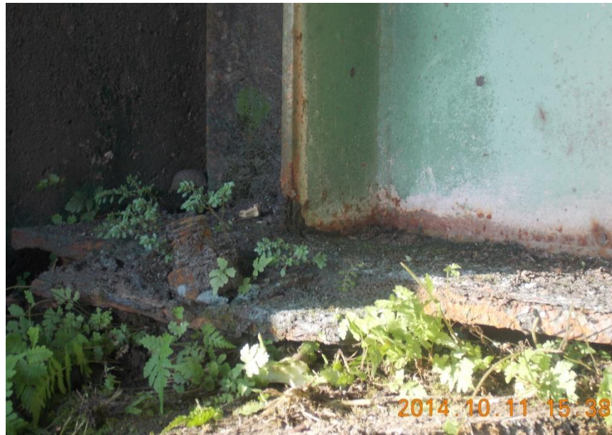
Figura 17: Corrosión, sedimentos y vegetación en apoyo bastión 1.
