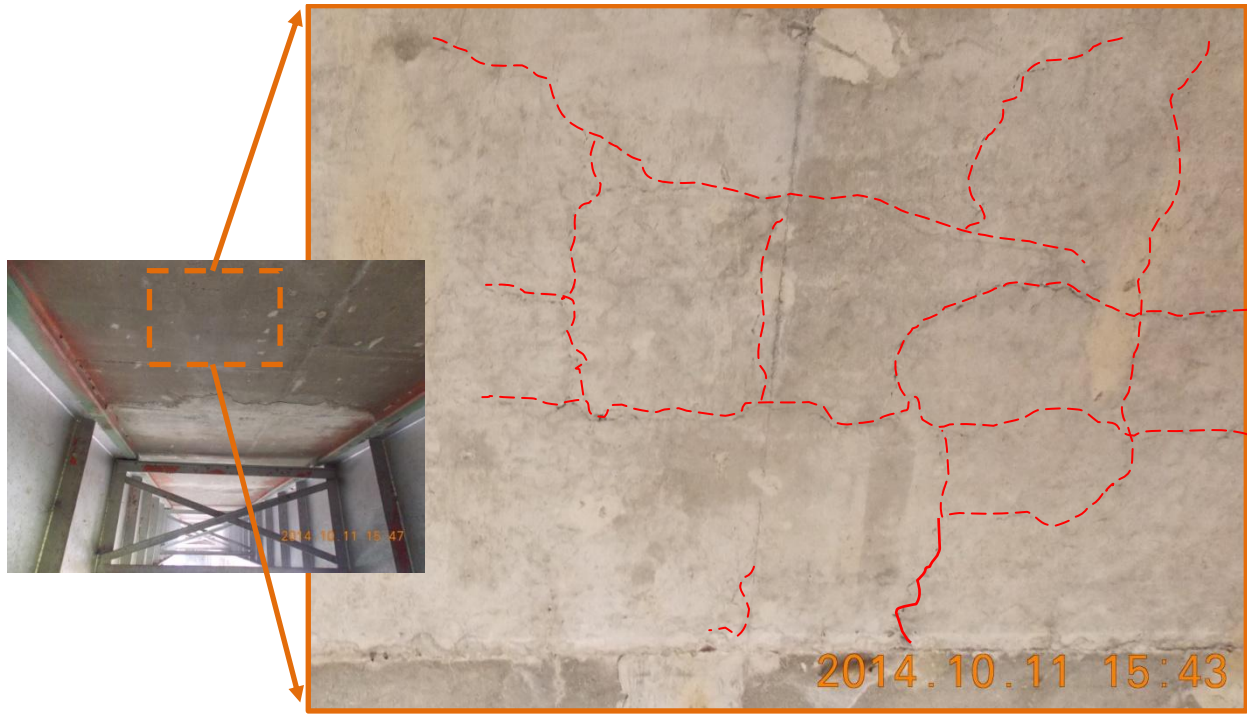
Figura 13: Agrietamiento en dos direcciones de la cara inferior de la losa de concreto.
