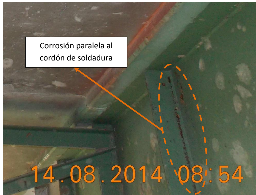
Figura 15: Corrosión en la zona de afectación térmica, paralela al cordón de soldadura de la viga principal.
