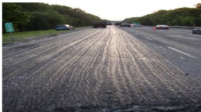
Figura 10. Riego de liga no uniforme producto de inadecuado funcionamiento y orientación de ángulo de boquillas.
