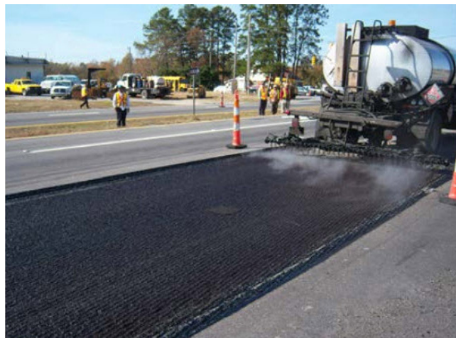
Figura 4. Aplicación uniforme de riego de liga Fuente: Departamento de Transporte de California, 2009.
