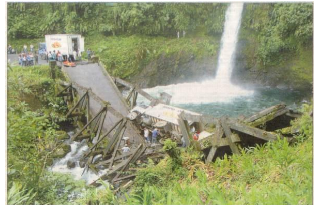
Figura 13.- Puente original de madera sobre el río La Paz Grande colapsado por el paso de vehículos pesados (fotografía del periódico The Tico Times , 2003).
