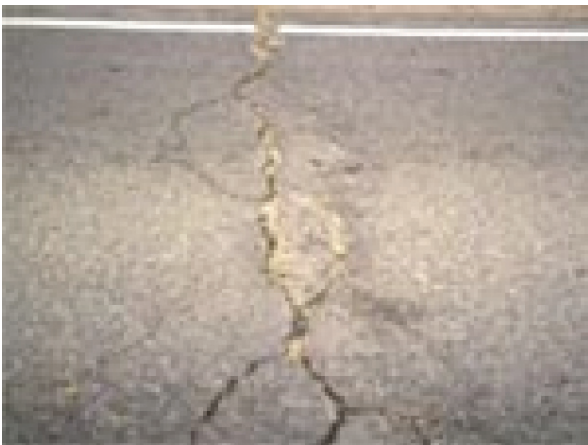
4c. Agrietamiento transversal con desprendimiento de borde
