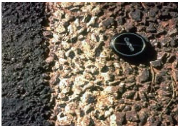
3a. Pavimento oxidado
