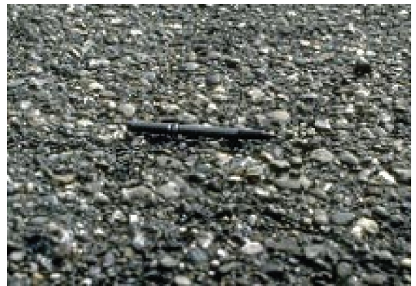
3b. Desprendimiento de partículas
