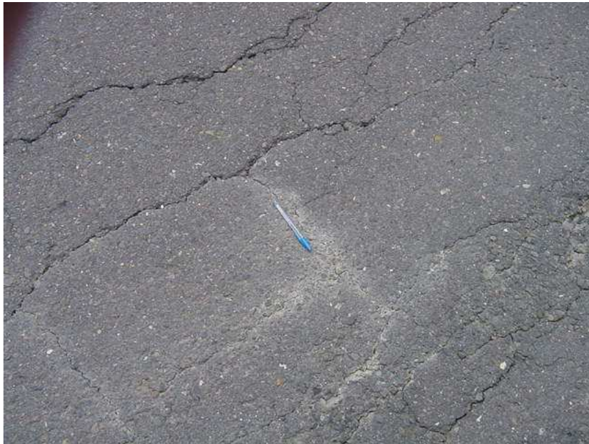
Figura N°4: Grietas longitudinales y agrietamiento por fatiga.
