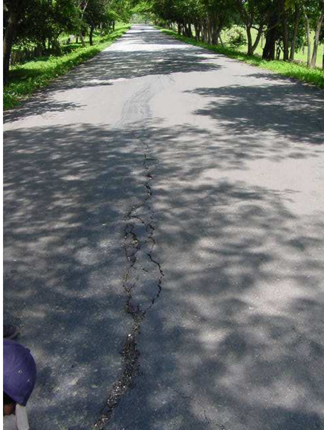
Figura N°1: Sección típica de tramos analizados (relleno) con presencia de grietas longitudinales.
