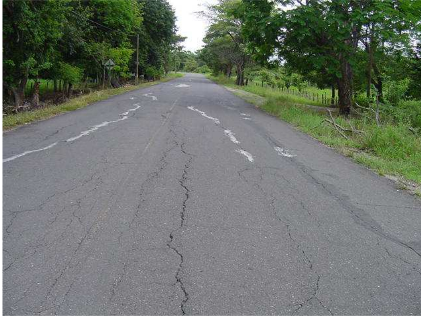
Figura N°3: Sección típica de tramos analizados (relleno) con presencia de grietas longitudinales y agrietamiento por fatiga.
