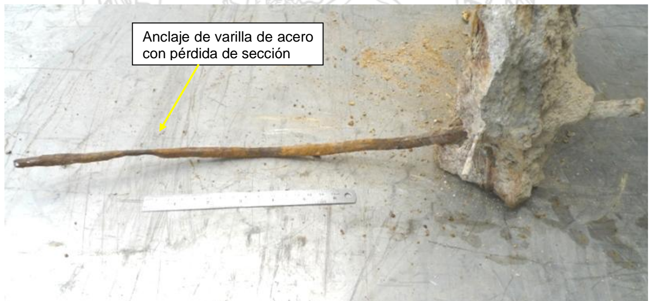
Figura 33. Pérdida de sección observada en una varilla de acero No. 4, la cual estuvo dentro de la matriz de suelo y la roca del talud en el km 38+600, RN-27. A esta misma varilla se le realizaron análisis detallados que se presentan más adelante en este informe.
