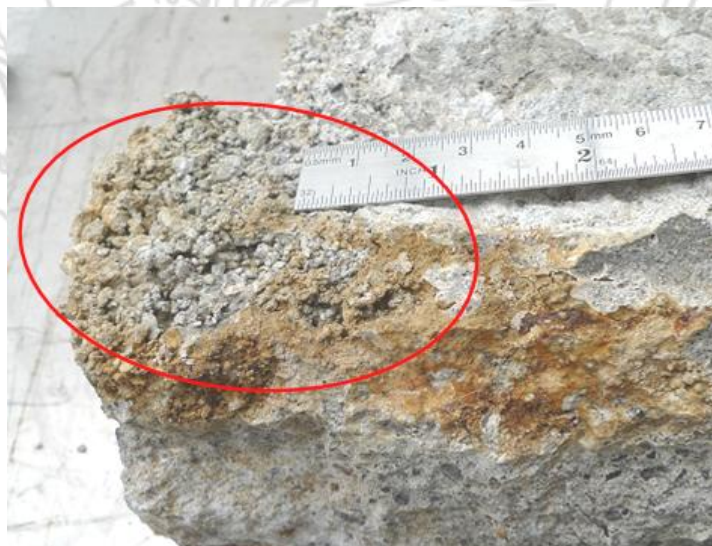
Figura 20. Pérdida de la matriz cementante en el concreto (zona enmarcada en rojo).
