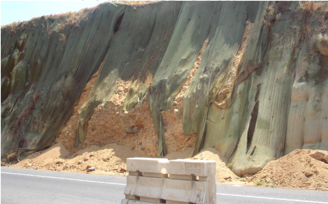
Figura 50. Deterioro en el manto para control de erosión del talud LI en el km 38+600. Se observa gran cantidad de suelo y detritos al pie del talud, producto de la erosión superficial.
