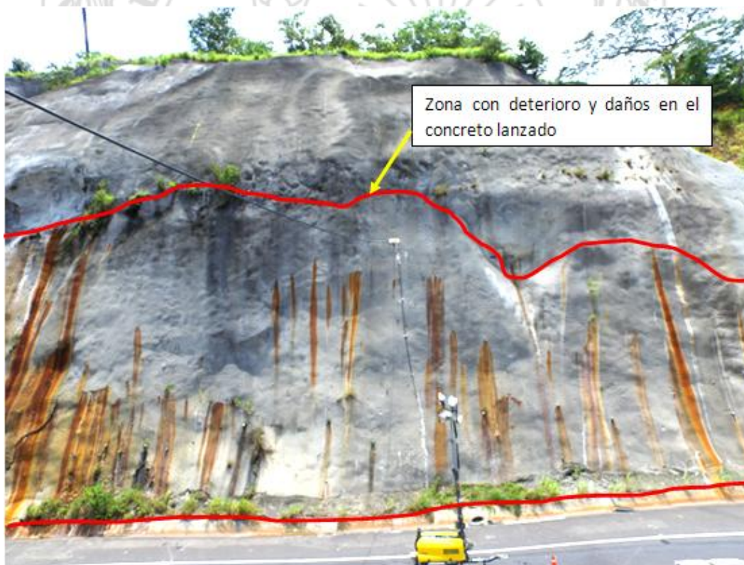
Figura 48. Talud del tramo 38+500 – 38+550 con evidencia de presentar DAR. Presenta además condiciones geotécnicas similares a las del talud del km 38+600, agrietamiento y daños con potencial de provocar la caída de materiales.
