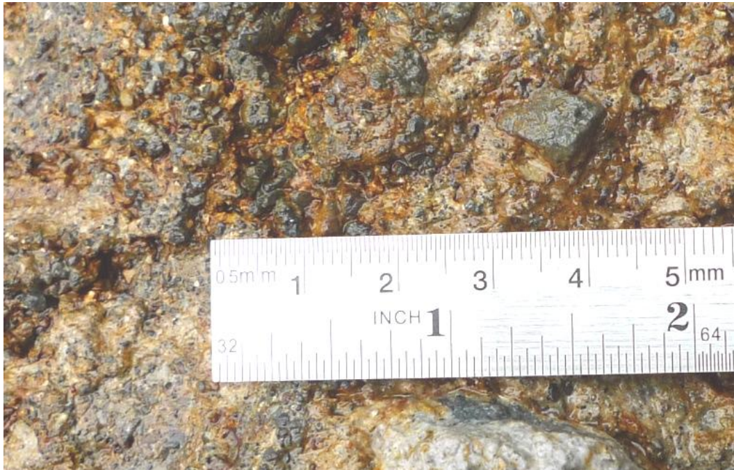
Figura 25. Deterioro en la superficie del concreto que estuvo en contacto con el drenaje ácido, la superficie fue lavada para remover los restos de suelo. Se observa la pérdida de matriz cementante y de agregado fino.
