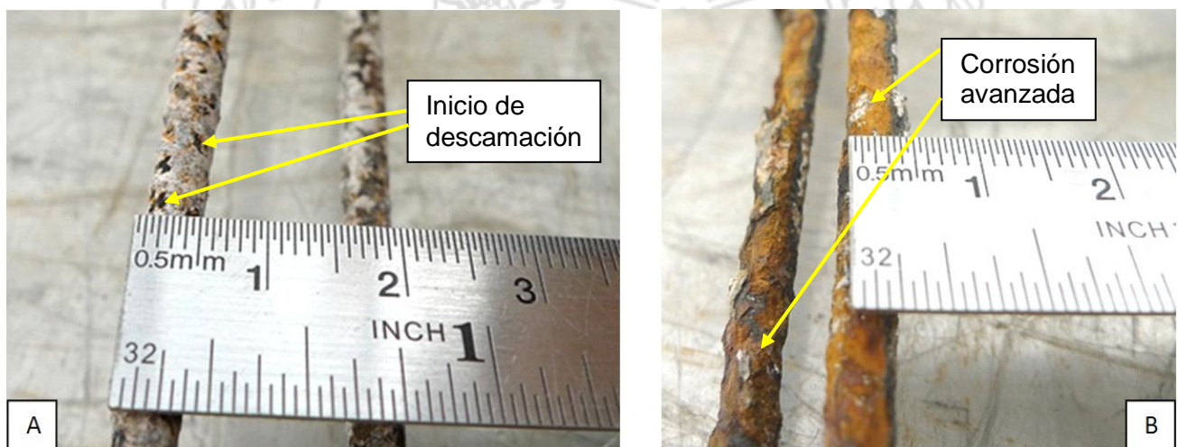
Figura 37. A) Acero afectado por la corrosión con evidencia de iniciar el proceso de descamación. B) Varillas de la malla electrosoldada con grado avanzado de corrosión, incluso presentan pérdida de sección.
