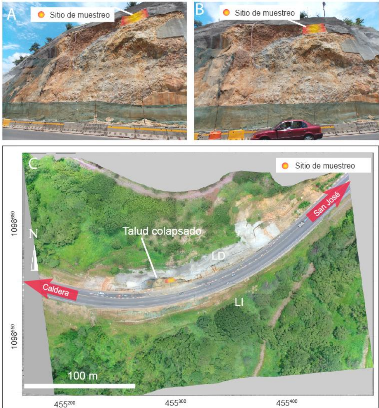
Figura 14. Sitio de donde fueron obtenidas las muestras de concreto lanzado con malla electrosoldada, las cuales fueron objeto de descripciones y análisis para valorar su afectación por DAR.
