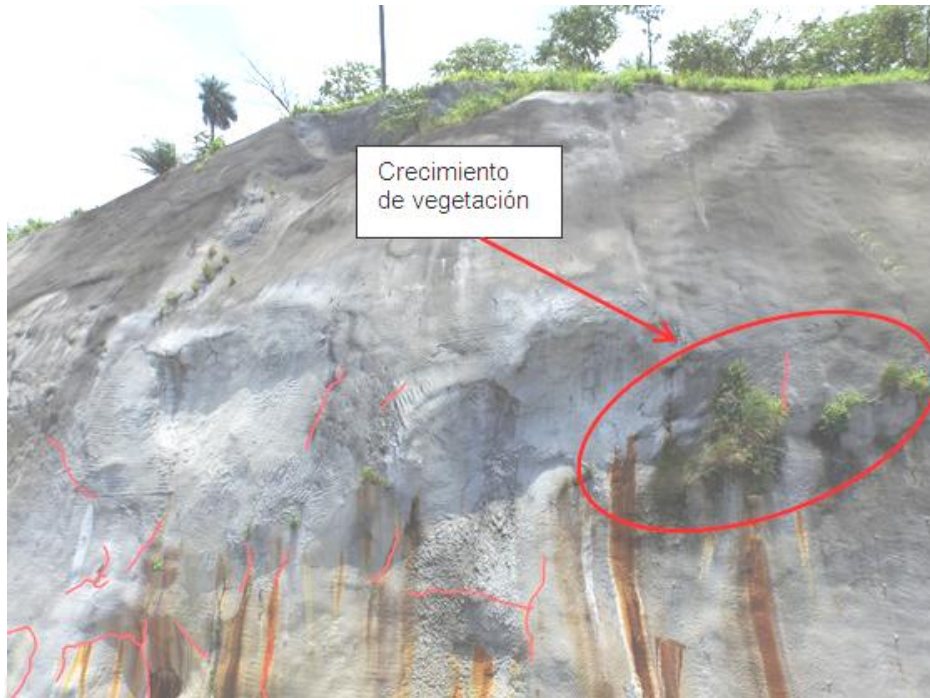
Figura 11. Agrietamiento (resaltado con rojo) y crecimiento de vegetación, talud LD, km 38+600.
