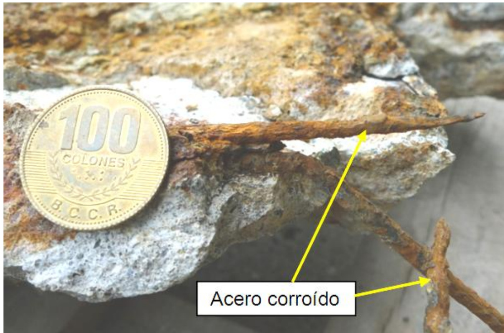
Figura 30. Deterioro por corrosión observado en las varillas de acero, muestras del concreto del km 38+600.
