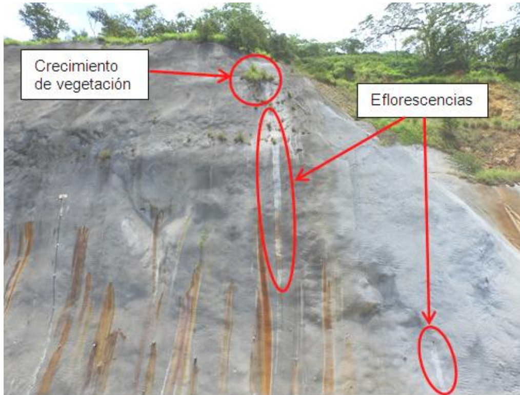
Figura 13. Vegetación y eflorescencias observadas en el talud del km 38+600.
