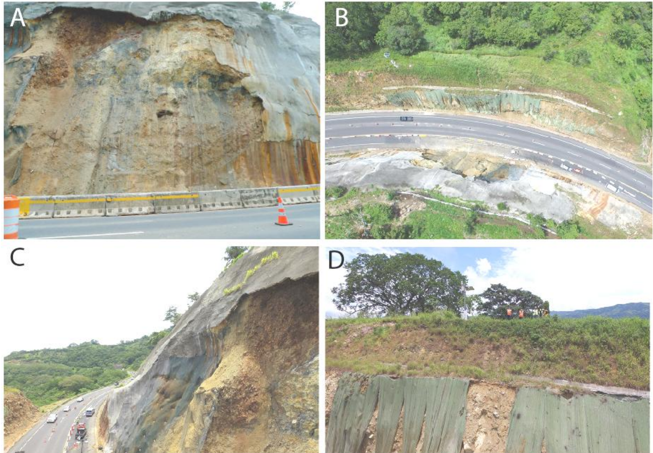
Figura 6. Se muestran los materiales que afloran en los taludes LD y LI del km 38+600. A) En la parte inferior las rocas y la matriz se encuentran silicificadas y hay partes que aun están cubiertas por el concreto lanzado. B), C) y D) La sección media y superior corresponde con una brecha donde los bloques están en una matriz arcillosa rica en azufre, sulfatos y cristales de yeso y no está silicificada.
