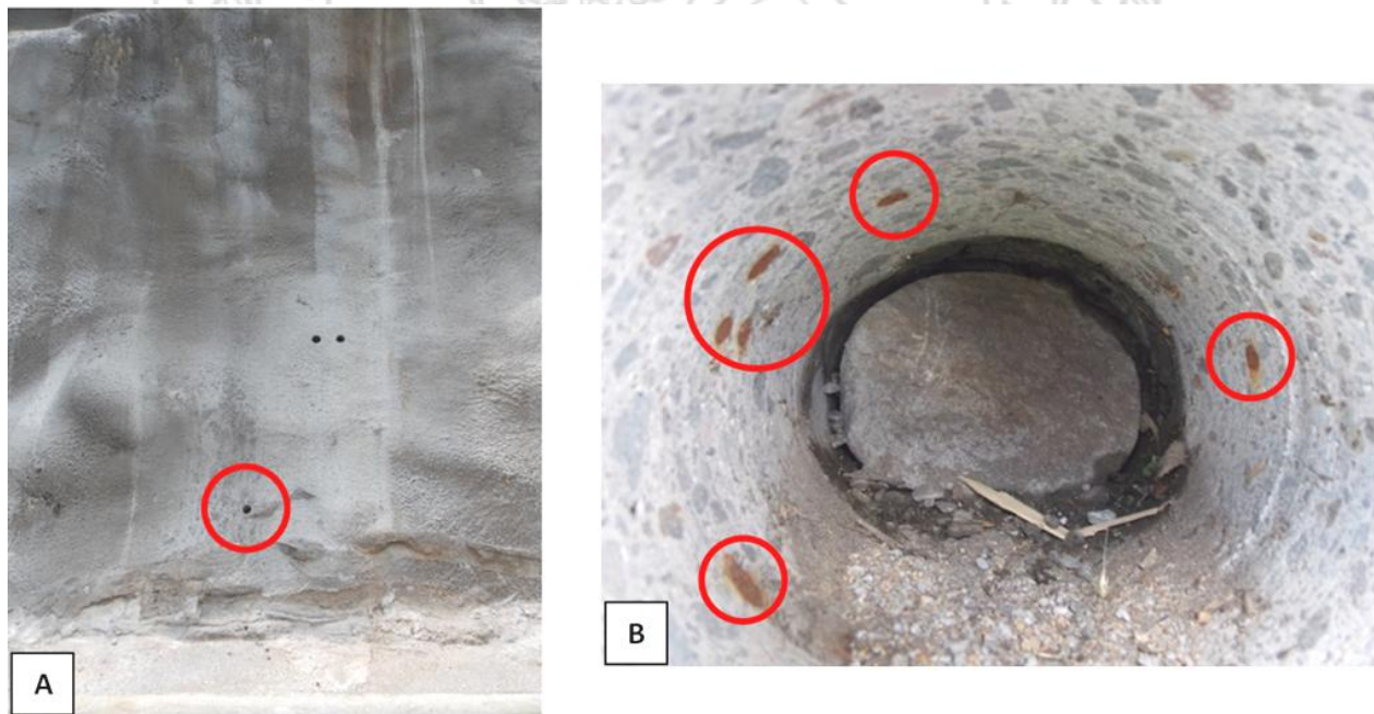
Figura 66. Sitio de extracción del núcleo No.19., km 46+470. A) Vista general del talud y del punto de la extracción. B) Interior de la perforación, se detalla el corte de las varillas que fueron extraídas como parte del núcleo de concreto.
