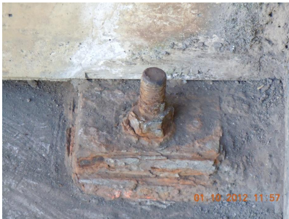
Figura 20: Corrosión avanzada en los apoyos de las vigas
