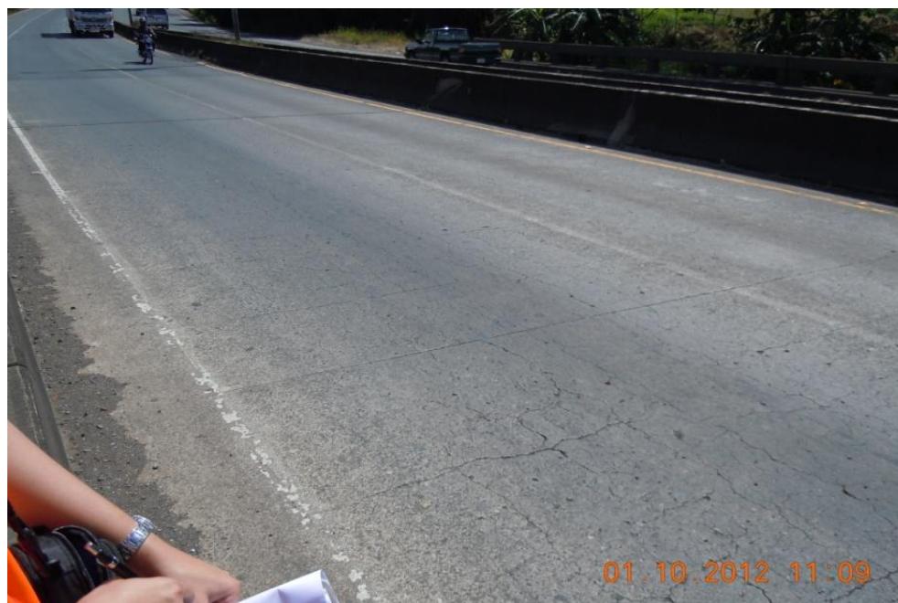
Figura 14: Agrietamiento en dos direcciones en la losa del puente
