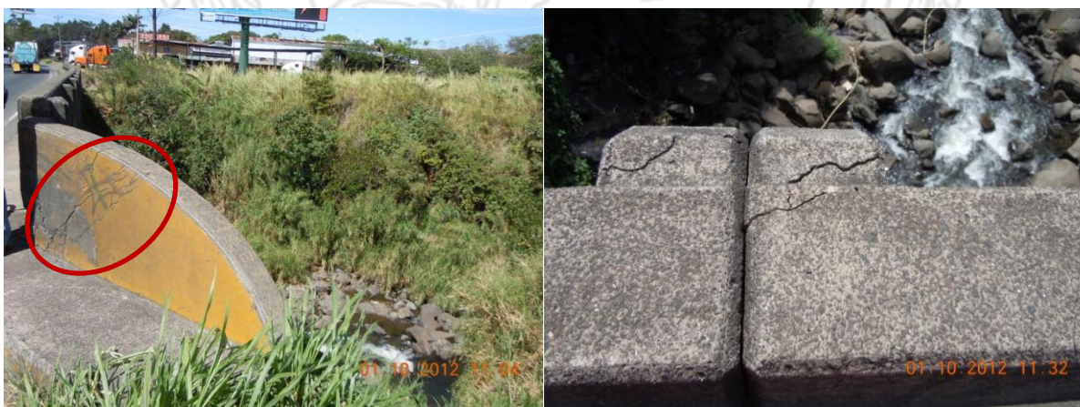
Figura 5: Agrietamiento en la baranda de concreto del puente
