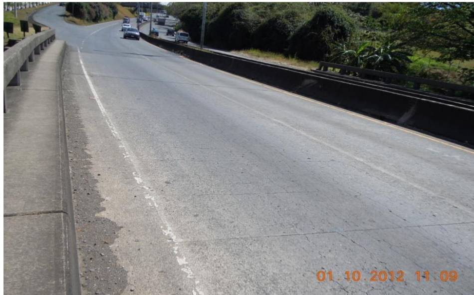
Figura 8: Demarcación vial deteriorada
