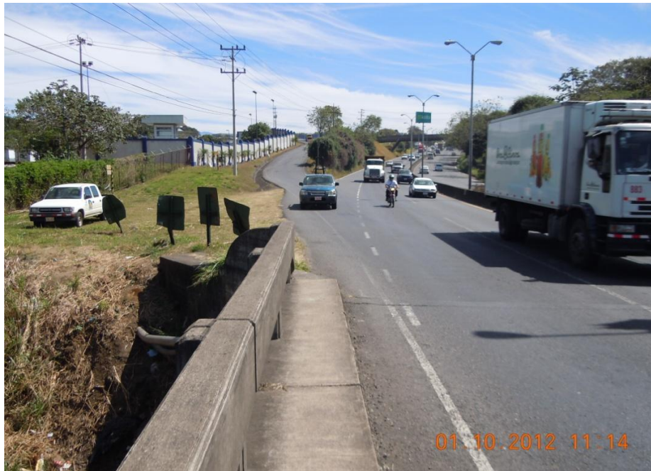
Figura 10: Falta de drenajes en acceso Este sentido San José – Alajuela
