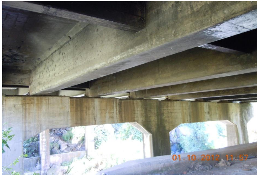
Figura 12: Marcas por filtración de agua a través de las juntas de expansión entre superestructuras
