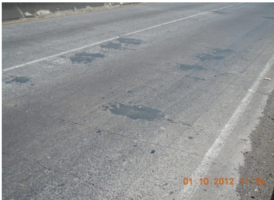
Figura 16: Agujeros de la losa cubiertos con mezcla asfáltica
