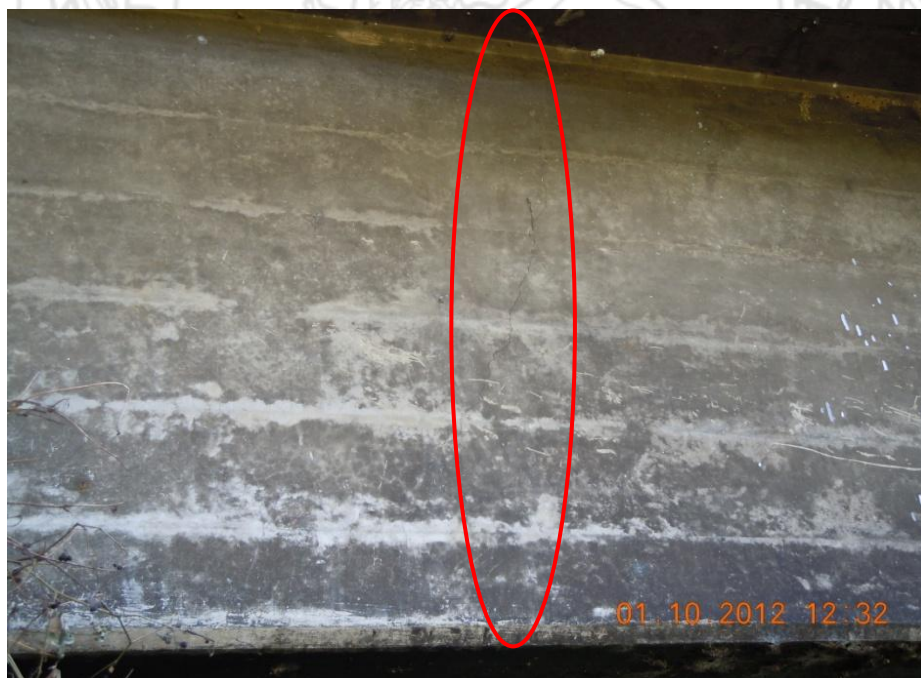
Figura 17: Agrietamiento en una dirección en las vigas de concreto (centro del tramo)
