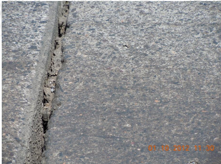
Figura 13: Deterioro del material de sello de las juntas
