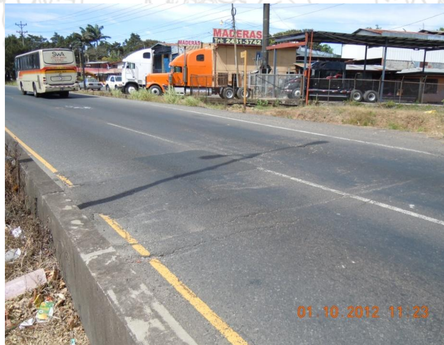
Figura 11: Baches, agrietamiento y surcos en la carpeta asfáltica de los accesos (acceso Oeste)
