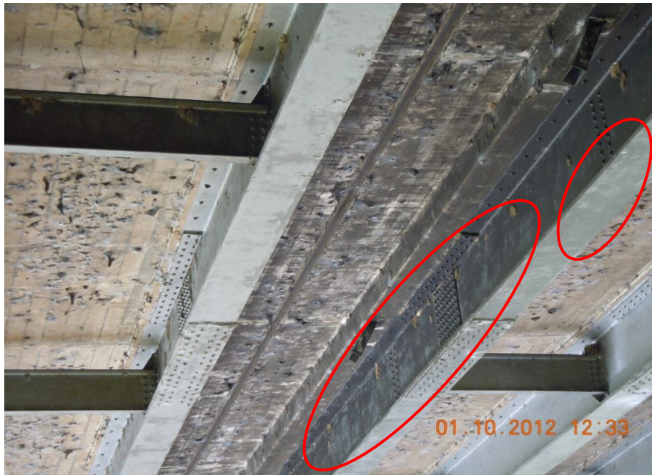
Figura 18: Decoloración del sistema de protección de las vigas de acero
