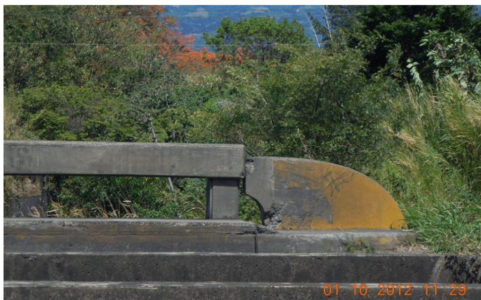
Figura 6: Diferencia de nivel existente en la baranda de concreto (acceso Este, sentido San José - Alajuela)
