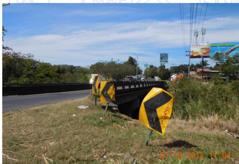
Figura 7: Ausencia de guardavías en el acceso Este sentido San José - Alajuela
