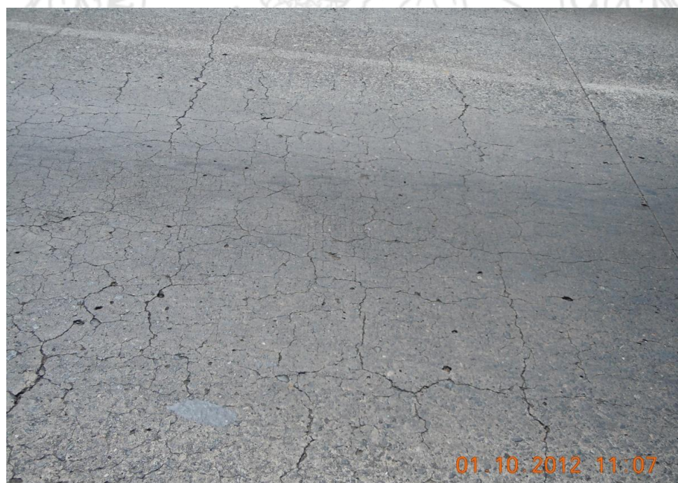
Figura 15: Detalle del agrietamiento en dos direcciones en la losa del puente
