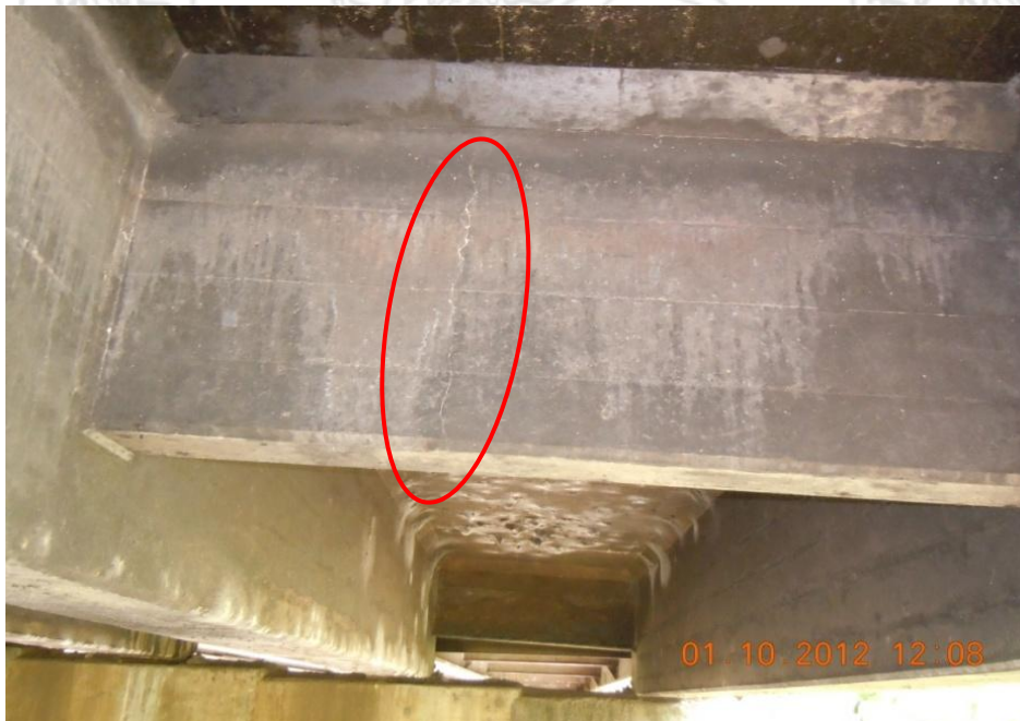
Figura 19: Agrietamiento en una dirección generalizado en vigas diafragma
