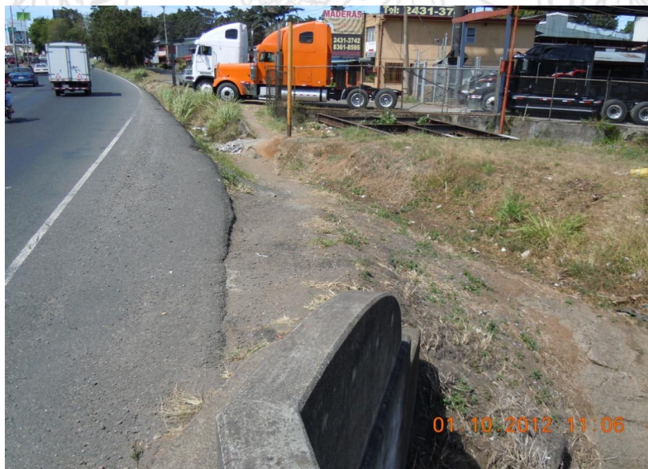
Figura 9: Falta de drenajes en acceso Oeste sentido San José – Alajuela
