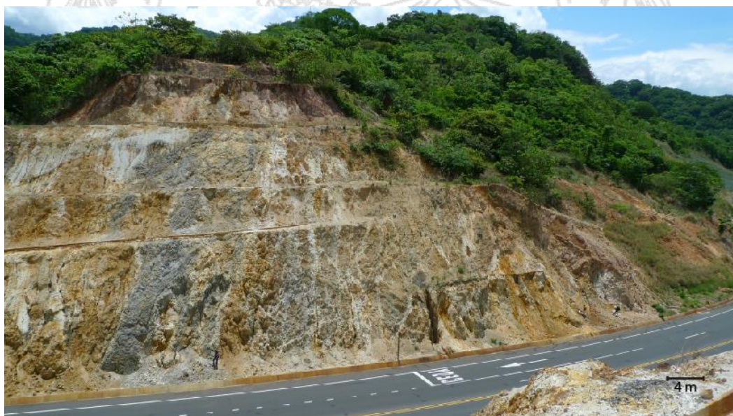
Figura 9. Talud en el kilómetro 48+000 de la Ruta 27 San José-Caldera. Se observan las fracturas y diferentes tonalidades de las rocas alteradas. La parte de color gris corresponde con una zona de alteración críptica, ya que parece estar sana a simple vista pero en realidad está muy alterada y presenta cristales de pirita.
