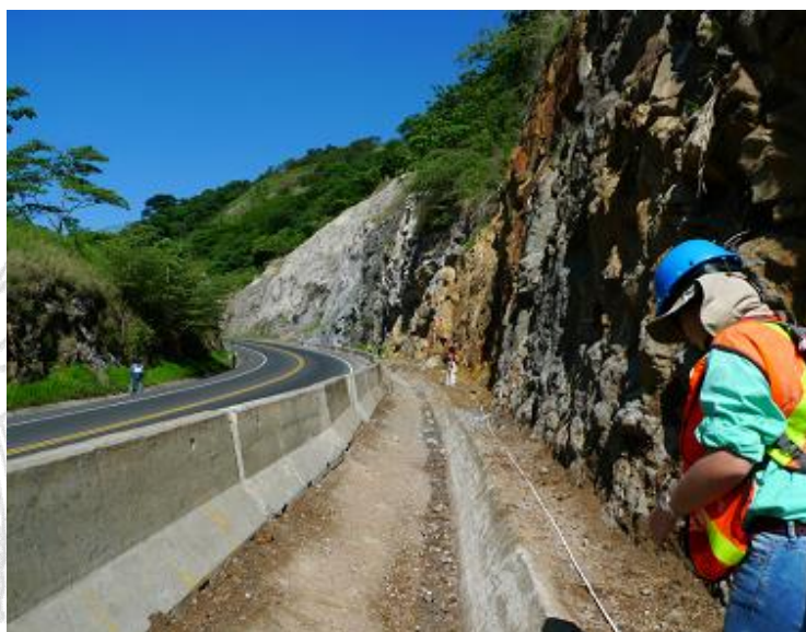
Figura 8. Vista del talud de roca lado derecho, muestreado para determinar el pH en una pasta de roca en el estacionamiento 45+600. Nótese las coloraciones rojizas en las rocas del talud. Al fondo se observa el talud rocoso cubierto por concreto lanzado.
