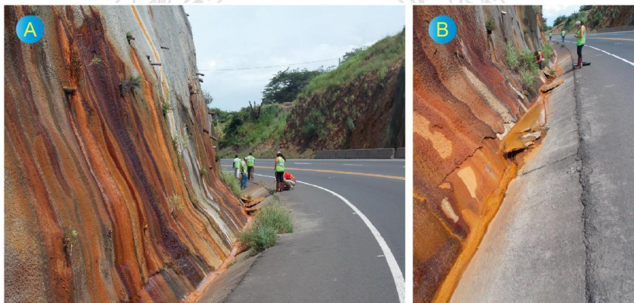
Figura 13. A.) Pared de concreto lanzado con tonalidades naranjas generadas por óxidos de hierro y manganeso. B.) Cunetas colapsadas por flujos de agua ácida, además se observa la parte inferior del talud resquebrajada. Ambas imágenes corresponden al estacionamiento Kilómetro 37+700.
