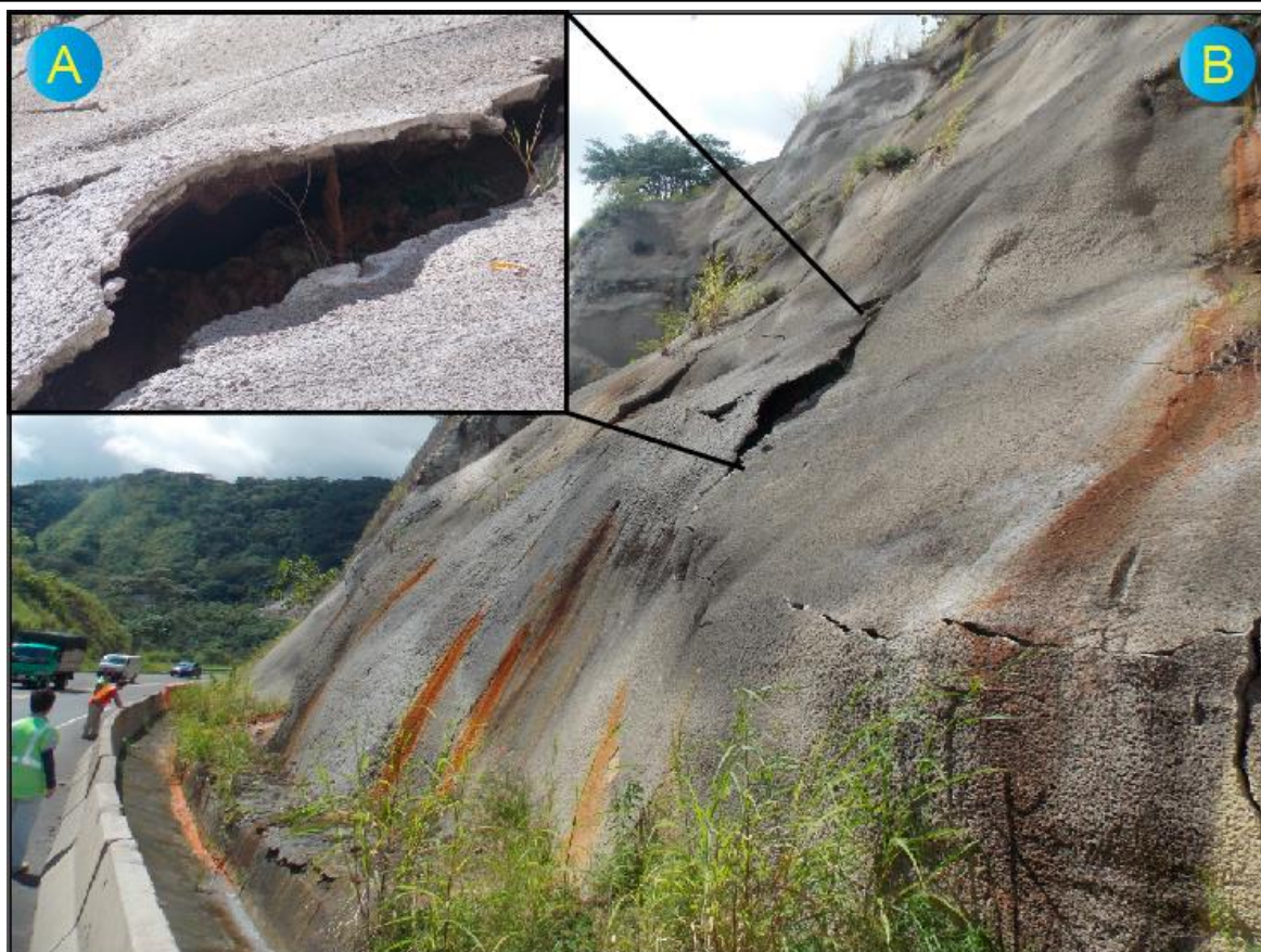
Figura 14. A.) Exposición de acero corroído por fracturas en el concreto lanzado. B) Se observan patinas de óxidos de hierro sobre el concreto lanzado, están asociadas con las salidas de agua de los drenajes y las fracturas. En la cuneta también se puede apreciar la presencia de este tipo de coloraciones. Estas fotografías corresponden con el estacionamiento del Kilómetro 45+800.
