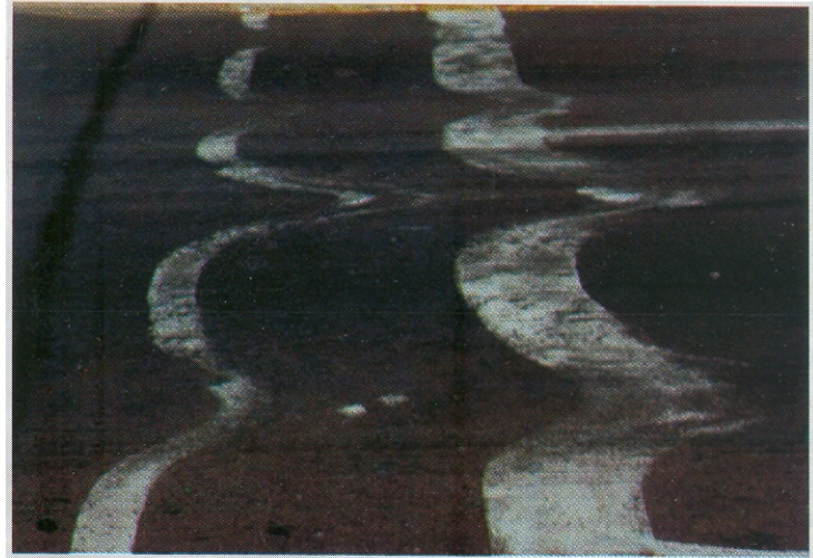
Figura 2: Corrugación provocada por flujo plástico en la capa asfáltica.
