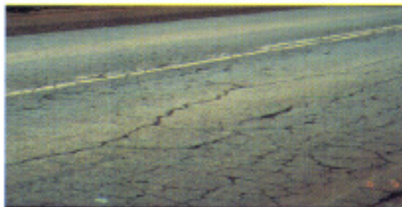
Figura No. 2: Agrietamiento por cargas repetidas (fatiga).
