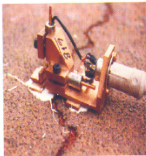
Figura No. 5: Dispositivo de medición de actividad de grieta.
