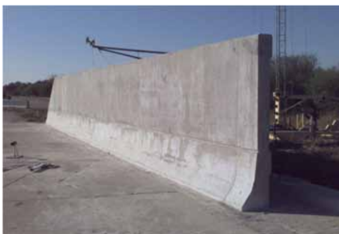
Figura 8. Ejemplo de una baranda tipo TL-5 Fuente: (3)
