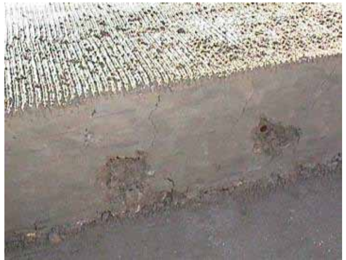
Figura 1. Agrietamiento por Contracción Plástica Fuente: Federal Highway Administration, U.S. Department of Transportation
