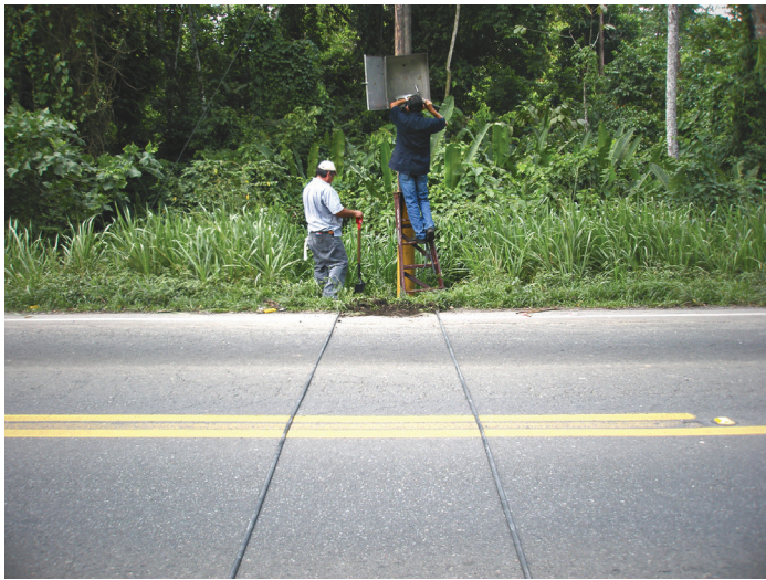
Figura 2. Instalación de contadores neumáticos.
