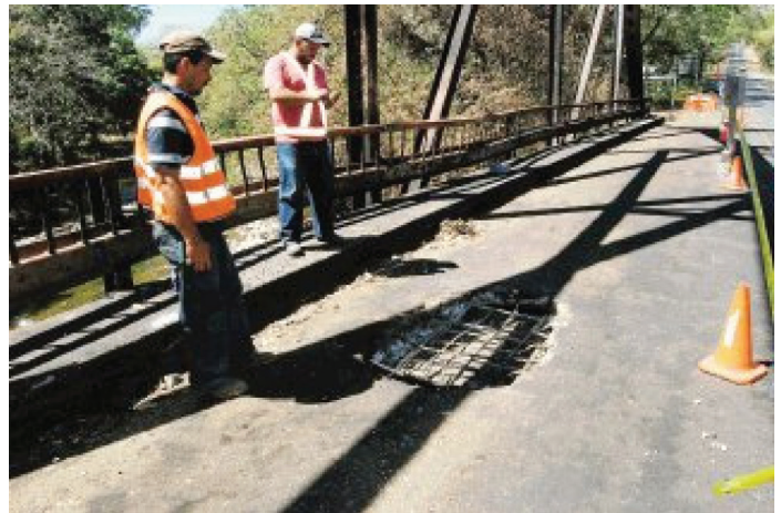
Figura 5. Huevo en la losa del puente sobre el Rio Lagarto - Ruta Nacional 1
