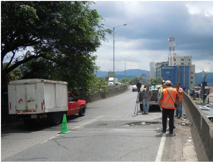
Figura 3. Huevo en la losa del paso a desnivel sobre la rotonda de la Hispanidad - Ruta Nacional 39
