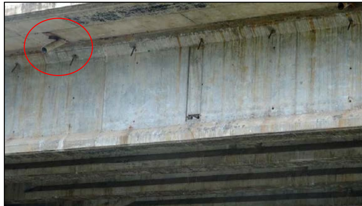
Figura 9. Acero de refuerzo que sobresale de la viga exterior y longitud insuficiente de los tubos de desagüe. Puente sobre el Río Sandillal. Fecha: 16 de julio 2015
