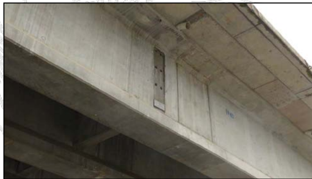
Figura 14. No se ha completado el anclaje con placas del acero de refuerzo de las vigas diafragma a la viga exterior del puente . Puente sobre el Río Toro. Fecha: 16 de julio 2015
