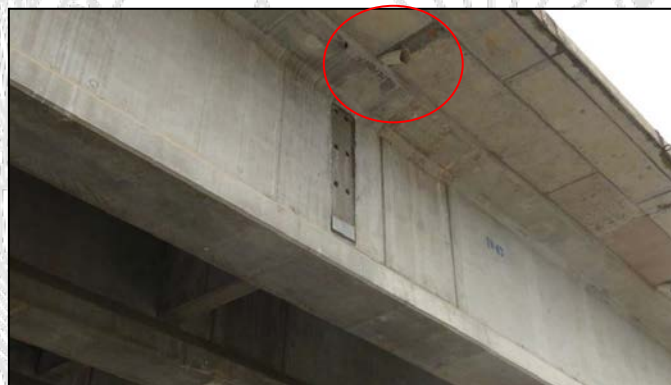
Figura 10. Longitud insuficiente de los tubos de desagüe. Puente sobre el Río Toro. Fecha: 16 de julio 2015
