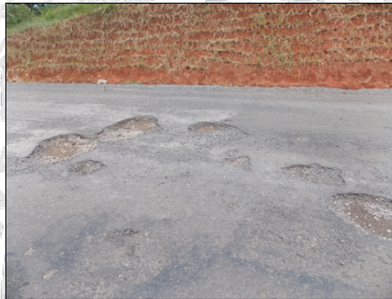
Figura 3. Deterioro en la base granular. Fecha: 10 de junio de 2015.
