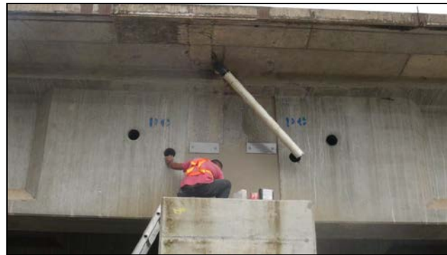
Figura 15. Protección de la placa de anclaje de las vigas diafragma y acabado de la superficie. Puente sobre el Río Toro. Fecha: 16 de julio 2015
