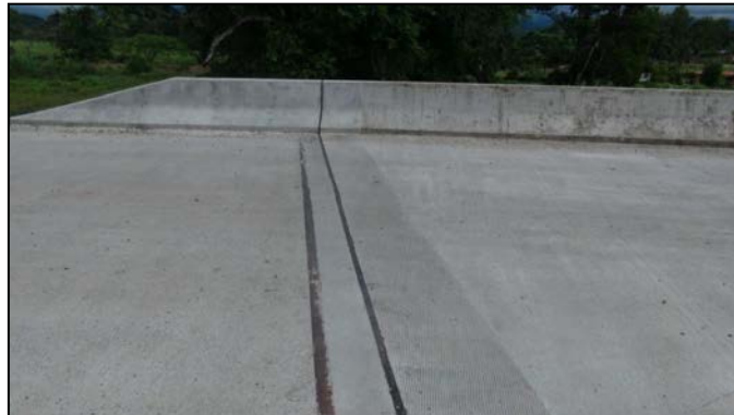
Figura 13. Faltaba colocar el sello de la junta de expansión. Puente sobre la Quebrada Pericos. Fecha: 16 de julio 2015
