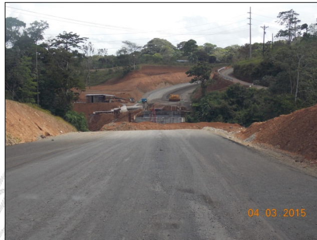
Figura 17. Construcción del puente sobre el río Cuarto. Estación 10+700. Fecha: 04 de marzo de 2015.
