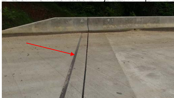
Figura 12. Falta colocar el sello de hule en ambas juntas de expansión. Puente sobre el Río Caño Negro. Fecha: 16 de julio 2015
