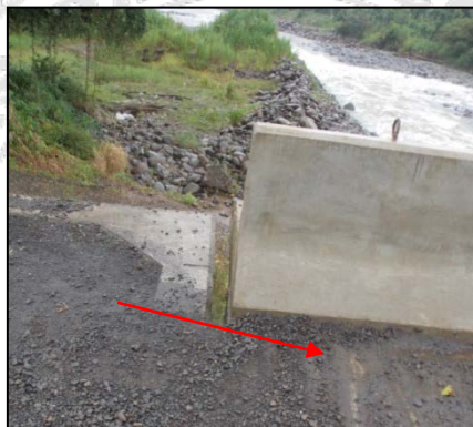
Figura 11. Juntas de expansión sin sello que impida el ingreso de sedimentos y descarga de agua sobre apoyos y la viga cabezal del bastión del puente sobre el Río Toro. Fecha: 10 de diciembre 2014
