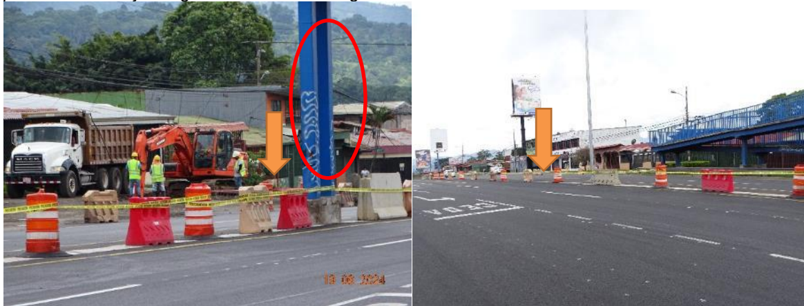
Figura 49. Cinta plástica usada en la mediana de la vía principal en el acceso sureste del paso elevado, presencia de objeto rígido. Fecha: 19 de agosto de 2024
