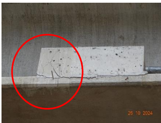
Figura 10. Bloque de concreto agrietado cercano a zona de postensión viga10, vano 4.
