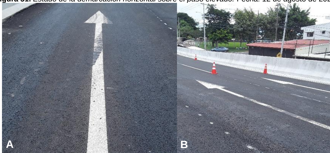
Figura 51. Estado de la demarcación horizontal sobre el paso elevado. Fecha: 12 de agosto de 2024
