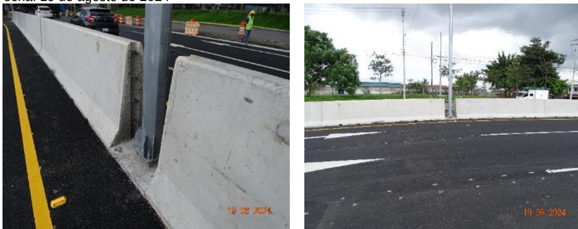
Figura 47 Discontinuidad de barreras medianeras por ausencia de placas de conexión en luminarias. Fecha: 19 de agosto de 2024
