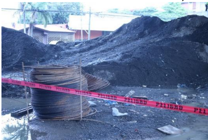
Figura 24. Condición de rollos torones observada en sitio. Fecha: 27 de junio de 2024.
