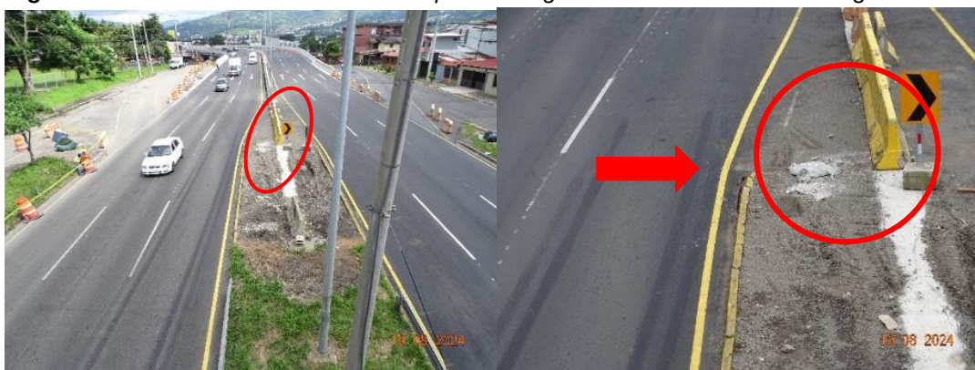
Figura 44. Obstáculo en transición abrupta al margen de la vía. Fecha 19 de agosto de 2024
