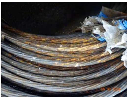
Figura 23. Oxidación en rollos de torones por emplear en el proceso de reparación de vigas del proyecto. Fecha: 06 de junio de 2024
