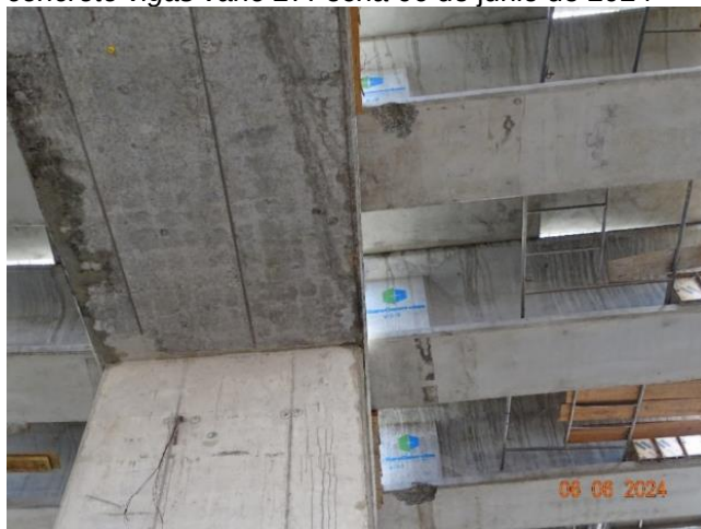
Figura 12. Daños en el concreto vigas vano 2. Fecha 06 de junio de 2024
