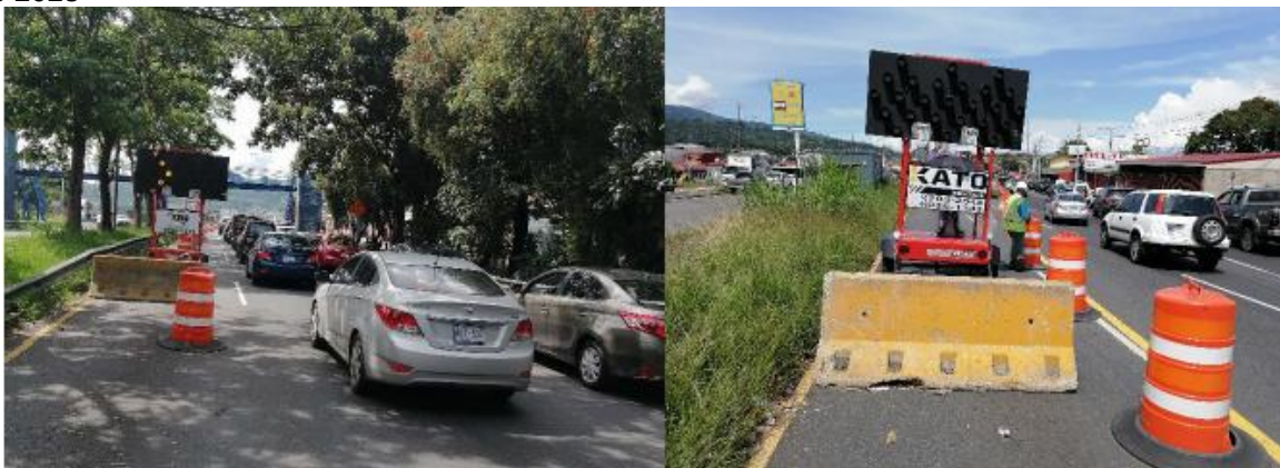
Figura 35. Ejemplos de transiciones no adecuadas en estrangulamiento de la vía. Fecha: 10 de octubre de 2023
