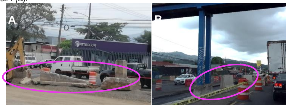
Figura 29 Obstáculos de concreto al margen de las vías de tránsito 24 de abril de 2024 (A) y el 17 de julio de 2024 (B).
