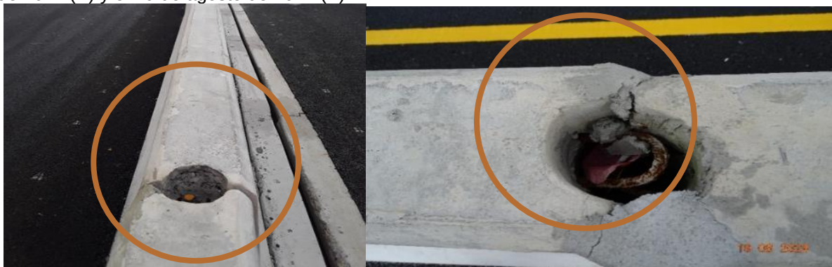
Figura 45. Empalme de barreras de concreto sin finalizar. Fecha: Fotografías tomadas el 12 de agosto de 2024 (A) y el 19 de agosto de 2024 (B).
