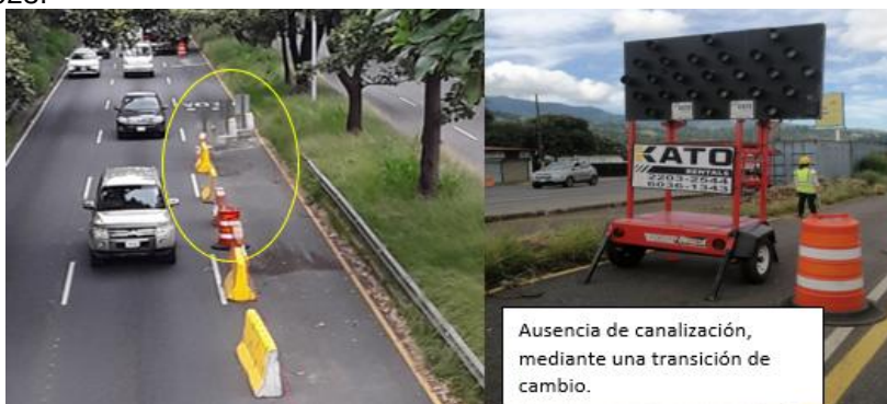
Figura 36 Ejemplos de transiciones no adecuadas en zonas de trabajo temporal. Fecha: 22 de noviembre de 2023.
