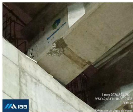
FOTOGRAFÍA 1. SEGUIMIENTO A LA CORRECCIÓN DE DEFECTOS.
