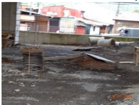
Figura 26. Condición de rollos torones observada en sitio. Fecha: 22 de julio de 2024
