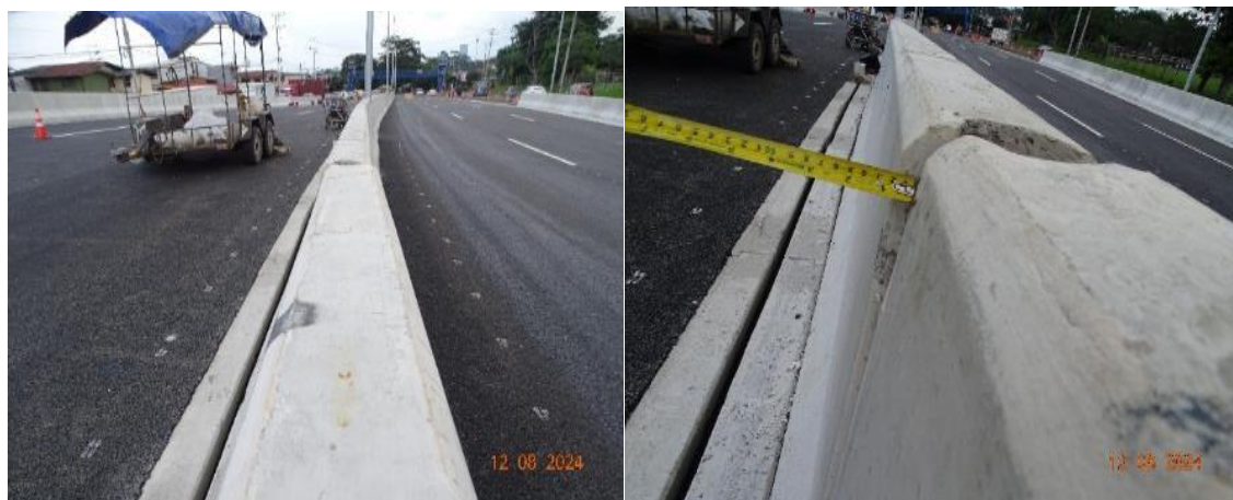
Figura 46. Barreras desalineadas y con escalonamiento. Fecha 12 de agosto de 2024
