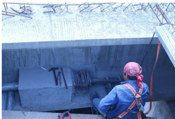
Figura 6. Demolición de bloque de concreto producto de falla después de aplicar tensado, viga vano 4. Fecha: 18 de junio de 2024
