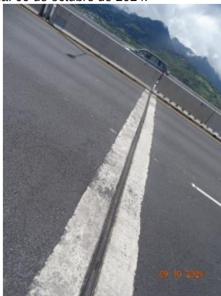
Figura 19. Condición de junta de expansión Bastión 2 sentido San Pedro-Pavas, diferencias de nivel de hasta dos centímetros. Fecha: 09 de octubre de 2024.
