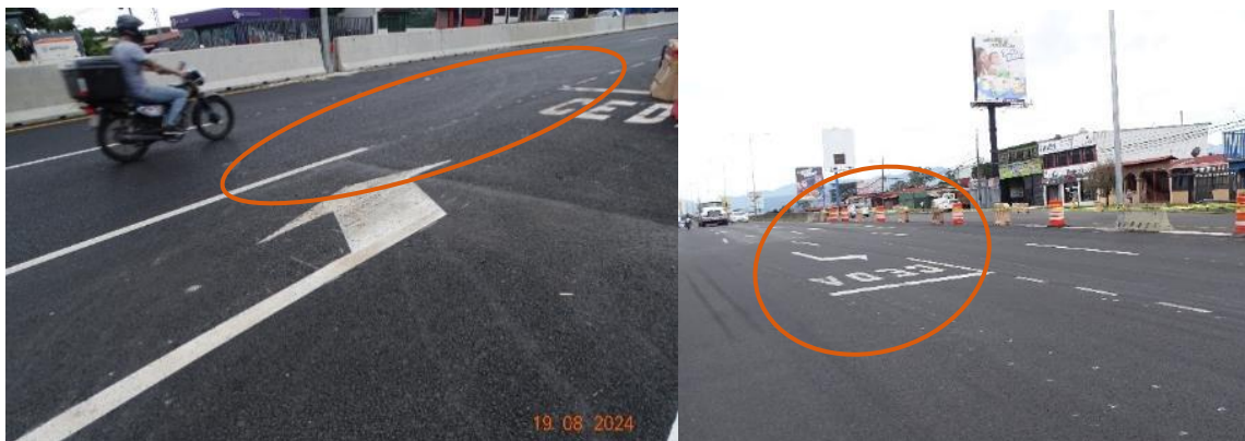
Figura 52. Incongruencia en demarcación de “CEDA”
