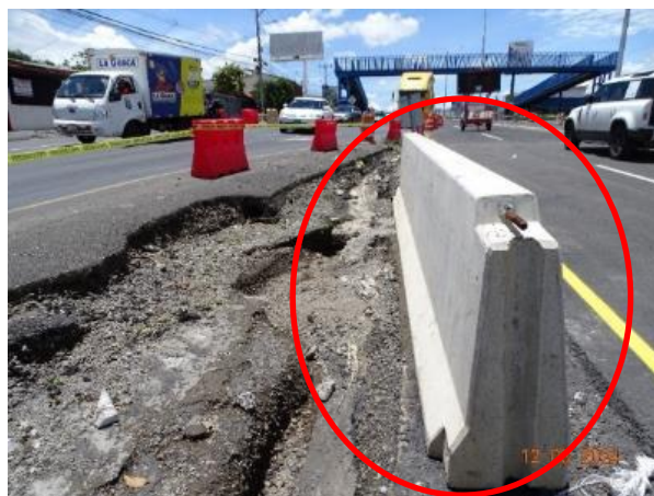
Figura 43. Barrera rígida sin ningún tipo de continuidad, desniveles al costado de la vía. cercanos a los carriles que serán apertura dos al tránsito. Fecha 12 de agosto de 2024
