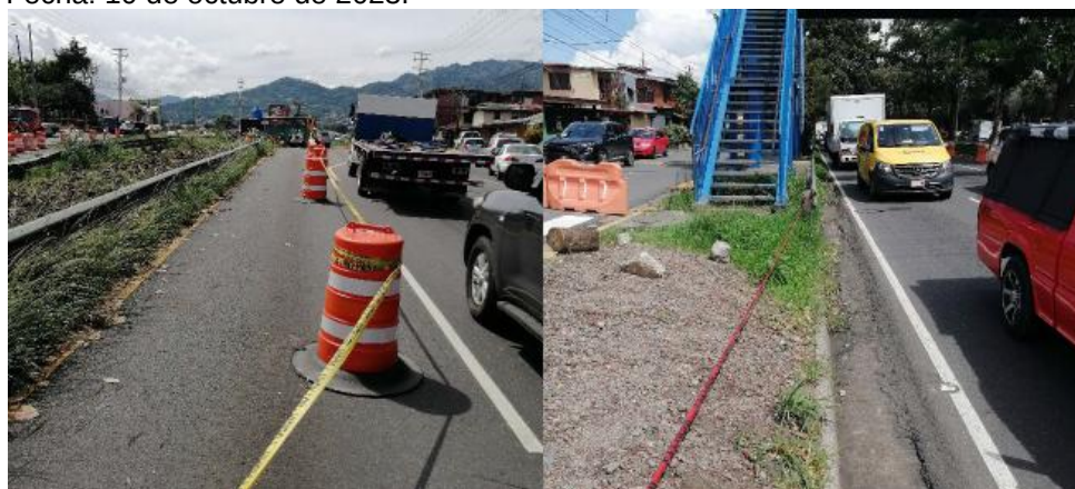
Figura 30 Uso de dispositivos no normados como elementos de canalización en las zonas de control temporal. Fecha: 10 de octubre de 2023.
