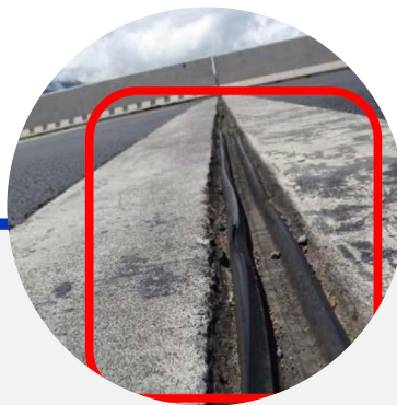
Prácticas constructivas: Abertura y daño del material elastomérico de la junta de expansión
