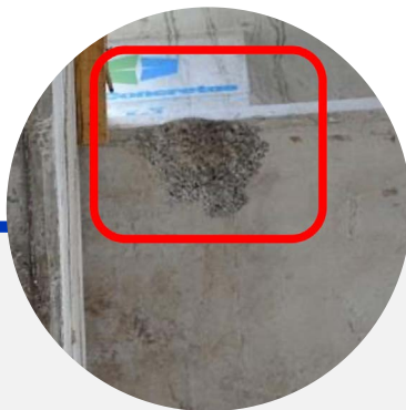
Prácticas constructivas: Daño identificado en sección inferior de ala de la viga 5 del vano 2
