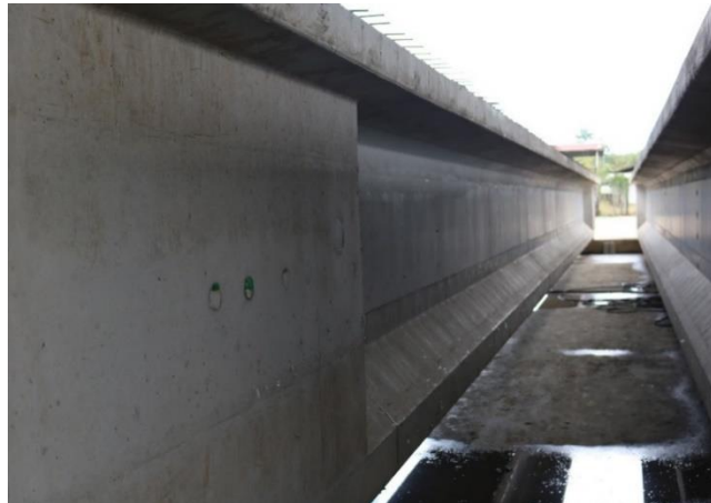
Figura 33. Vigas sin el curado necesario, Fecha: 8 de noviembre de 2023. Fuente LanammeUCR
