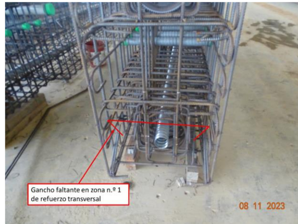
Figura 25. Ganchos faltantes en zona n°1 de refuerzo transversal en viga de superestructura n°4. Fuente: LanammeUCR (2023).
