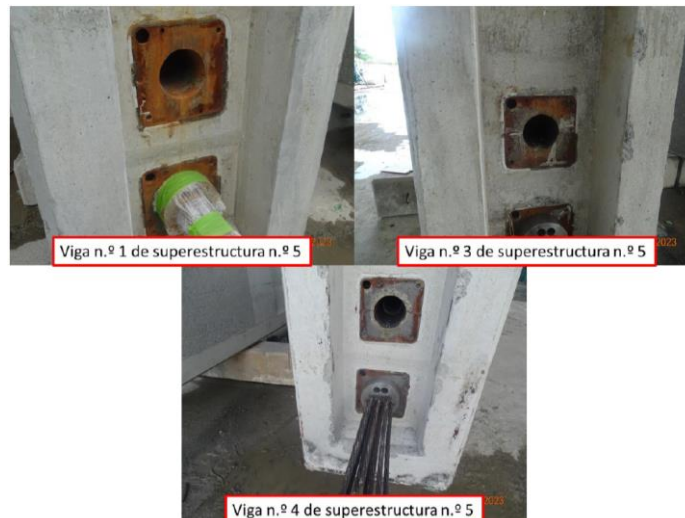
Figura 37. Placas y cables con corrosión evidente. Fecha 8 de noviembre de 2023. Fuente: LanammeUCR
