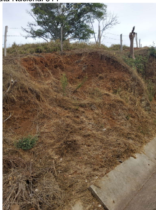
(b) evidencias de erosión y con cunetas, estación 2+826
