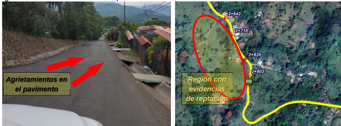
(a) agrietamientos longitudinales y hundimientos observados, estación 2+903
