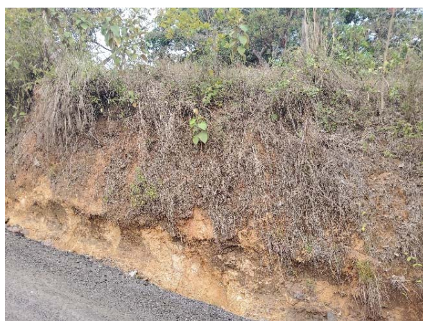
Figura 2. Condición de taludes inspeccionados en la Ruta Nacional 314
