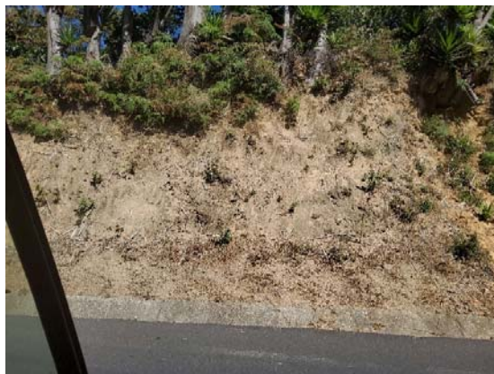
(b) erosión en la cara del talud y presencia de cunetas en la base del talud, estación 5+979
