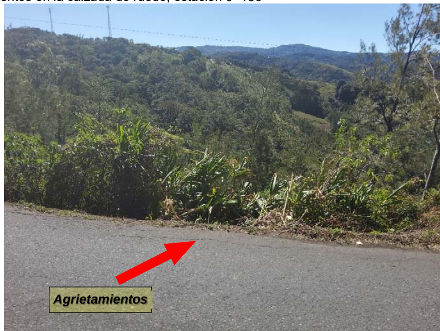
Figura 3. Condición de taludes de relleno inspeccionados sin la presencia de cunetas y con agrietamientos en la calzada de ruedo, estación 0+186
