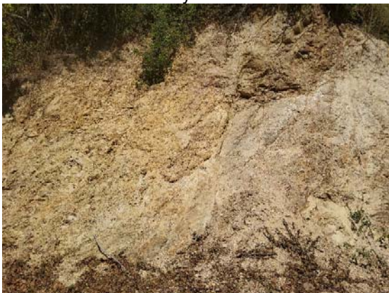
(a) evidencias de erosión en la cara del talud, estación 7+602
