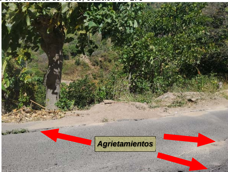
Figura 3. Condición de taludes de relleno inspeccionados sin la presencia de cunetas y con agrietamientos en la calzada de ruedo, estación 11+276
