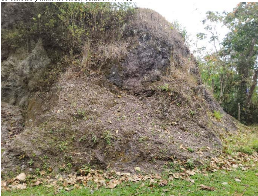
Figura 2. Condición observada en uno de los taludes inspeccionados: erosión en la cara del talud, falta de cunetas y material caído, estación 17+760
