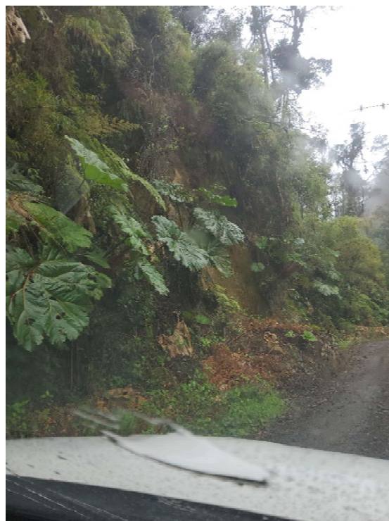
b) falta de cunetas y material caído, estación 12+098
