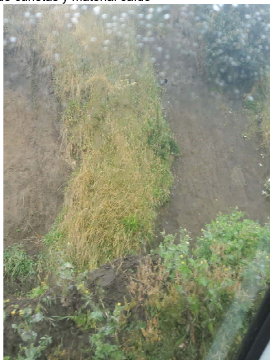
a) evidencias de erosión en la cara del talud, estación 1+412
