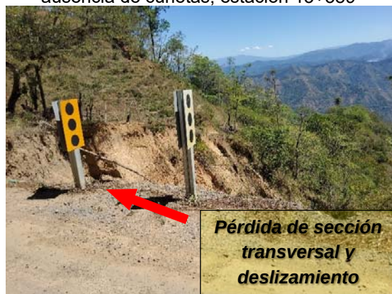
(d) ausencia de cunetas y evidencias de deslizamiento, estación 18+009
