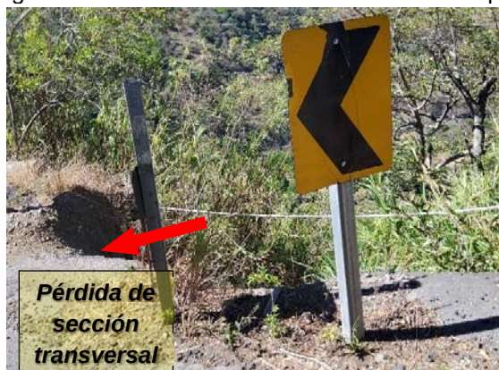
(a) pérdida de sección, ausencia de cunetas y evidencias de deslizamiento, estación 3+791
