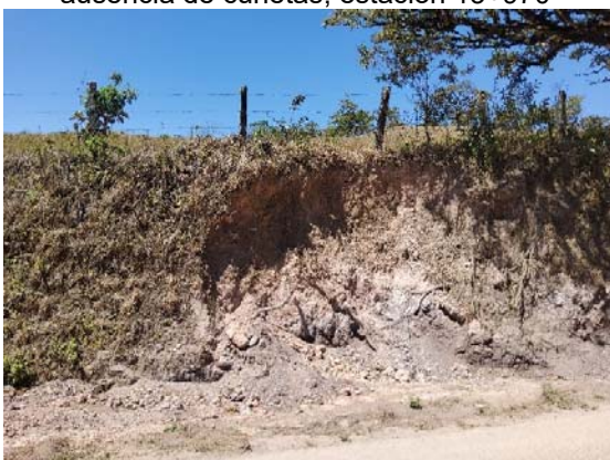
(e) evidencias de erosión en la cara del talud y ausencia de cunetas, estación 18+617
