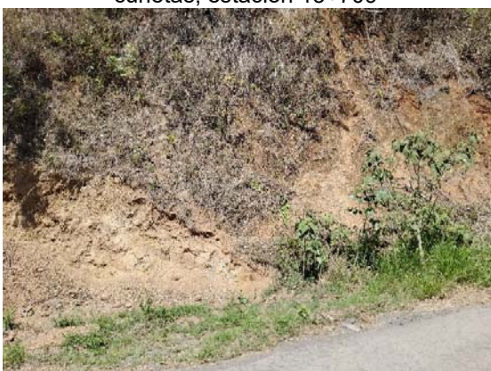
(c) evidencias de erosión en la cara del talud y ausencia de cunetas, estación 13+970
