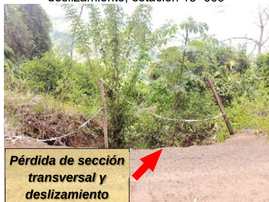
(f) pérdida de sección de la carretera y evidencias de deslizamiento, estación 31+347
