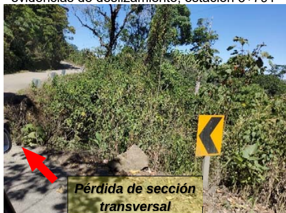
(c) pérdida de sección de la carretera y ausencia de cunetas, estación 16+971
