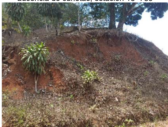
(f) evidencias de erosión en la cara del talud y ausencia de cunetas, estación 29+302
