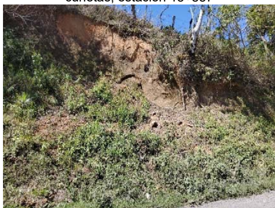
(d) evidencias de erosión en la cara del talud y ausencia de cunetas, estación 15+789
