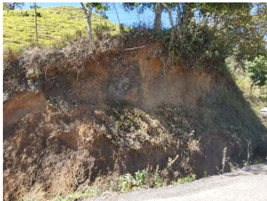
(b) evidencias de erosión en la cara del talud, deslizamiento de material y ausencia de cunetas, estación 13+857
