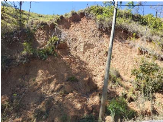
(a) evidencias de erosión en la cara del talud, deslizamiento de material y ausencia de cunetas, estación 13+709
