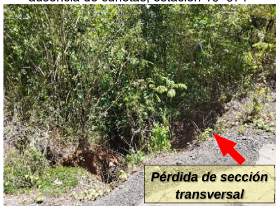
(e) pérdida de sección de la carretera y ausencia de cunetas, estación 23+081
