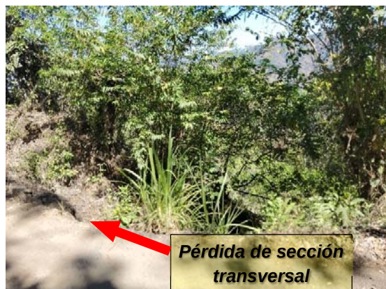
(b) pérdida de sección de la carretera y ausencia de cunetas, estación 13+389
