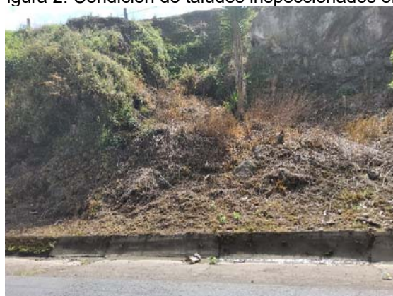
(a) evidencias de erosión en la cara del talud y presencia de cunetas, estación 11+669
