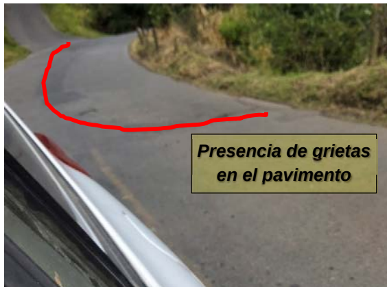
(b) formación de corona y agrietamientos observados en la superficie de rueda por falla del talud, estación 14+259
