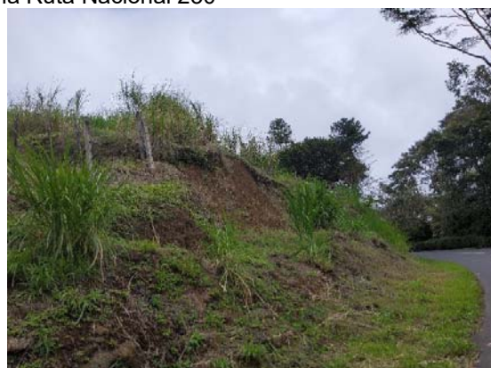
(b) evidencias de erosión, material caído y falta de cunetas, estación 29+364
