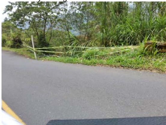
(a) ligera pérdida de la sección transversal de la superficie de rueda por deslizamiento en el talud de relleno, estación 31+285
