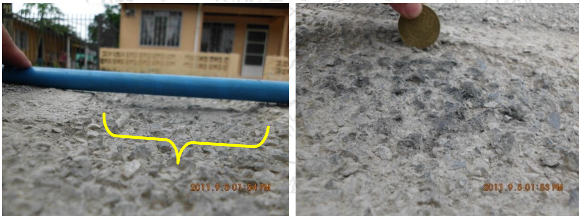
Figura 24: Desprendimiento de agregados de tratamiento superficial. Fuente: LanammeUCR, 2011.
