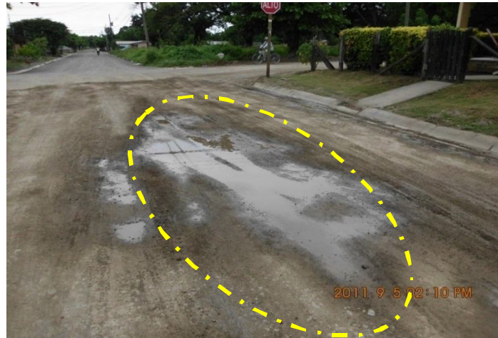
Figura 26: Empozamientos en zonas de aplicación de base estabilizada. Fuente: LanammeUCR, 2011.
