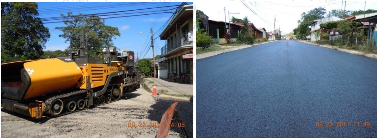
Figura 31: Equipo utilizado y acabado de los trabajos de colocación de mezcla Fuente: LanammeUCR, 2011.
