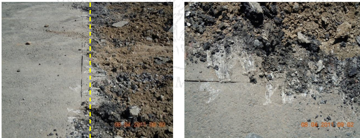
Figura 15: Corte inadecuado de los sitios de bacheo Fuente: LanammeUCR, 2011.
