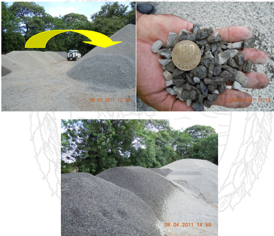
Figura 13: Materiales a utilizar en tratamientos superficiales mostraban presencia de impurezas y exceso de polvo tanto en acopio como al llegar al proyecto.
