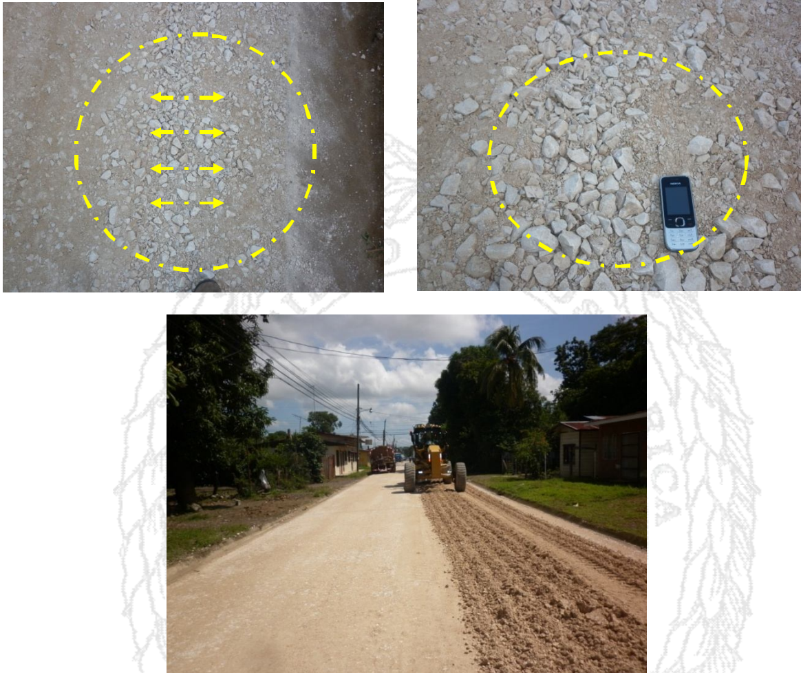
Figura 5: Problemas de segregación y falta de compactación. Reparación de tramo con sustitución de material. Fuente: LanammeUCR, 2011.
