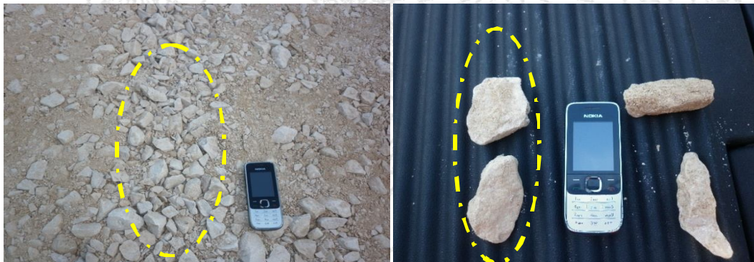
Figura 4: Material calizo utilizado como base granular, presencia de sobre tamaños puede generar problemas de compactación. Fuente: LanammeUCR, 2011.
