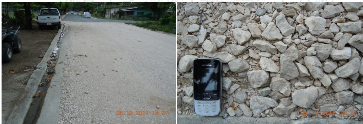
Figura 20: Regiones con inadecuado proceso de compactación y sobretamaño en el material de base granular.
