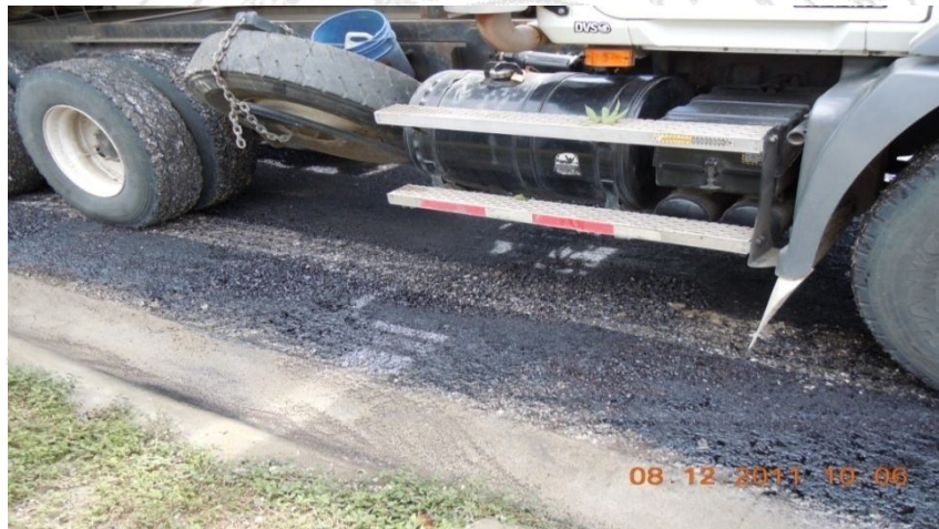
Figura 21: Tránsito sobre zonas con ligante asfáltico fresco. Fuente: LanammeUCR, 2011.
