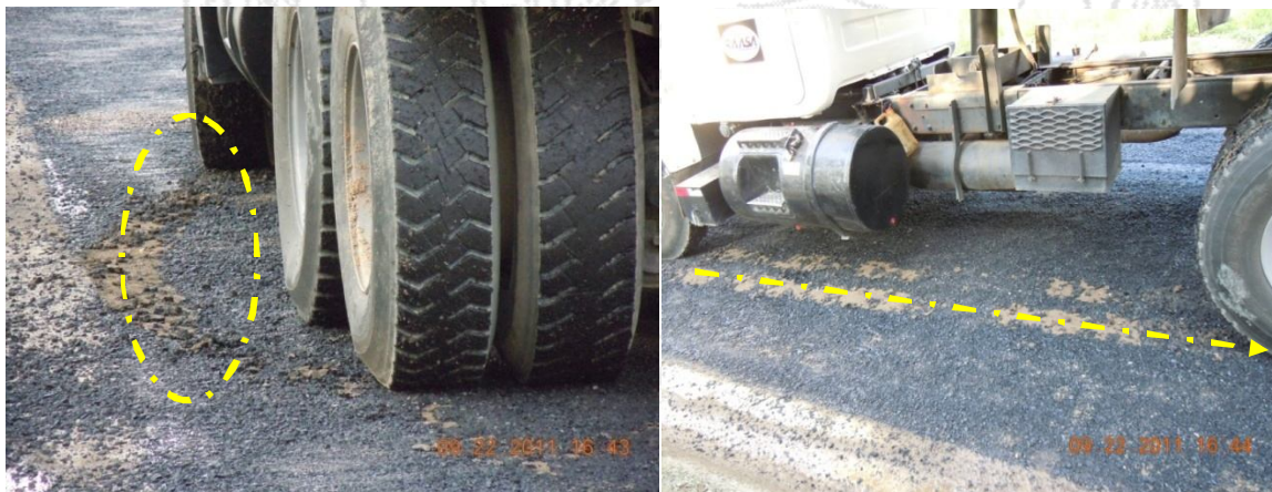
Figura 33: Inadecuado tránsito de la maquinaria sobre las obras frescas, daños puntuales. Fuente: LanammeUCR, 2011.
