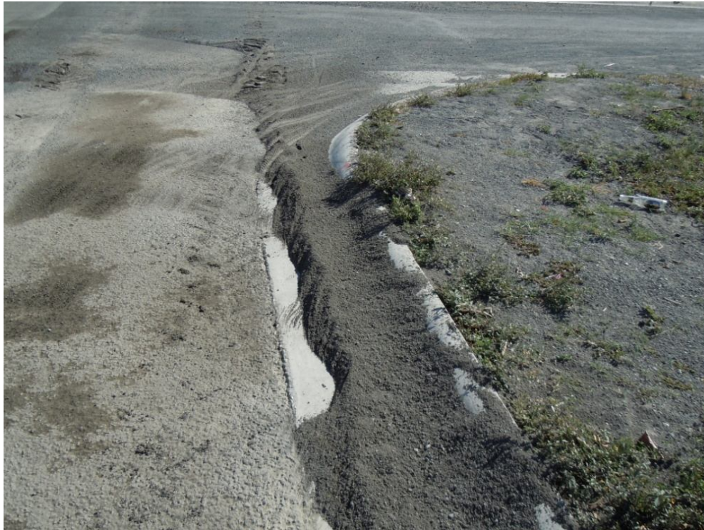
Figura 48: Material barrido sin recoger en cordones de caño. Fuente: LanammeUCR, 2011.
