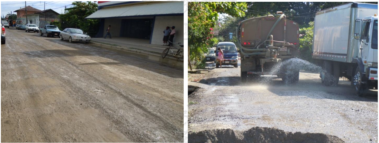
Figura 42: Deformaciones y empozamientos en material de base expuesto; labores de mantenimiento de base expuesta.
