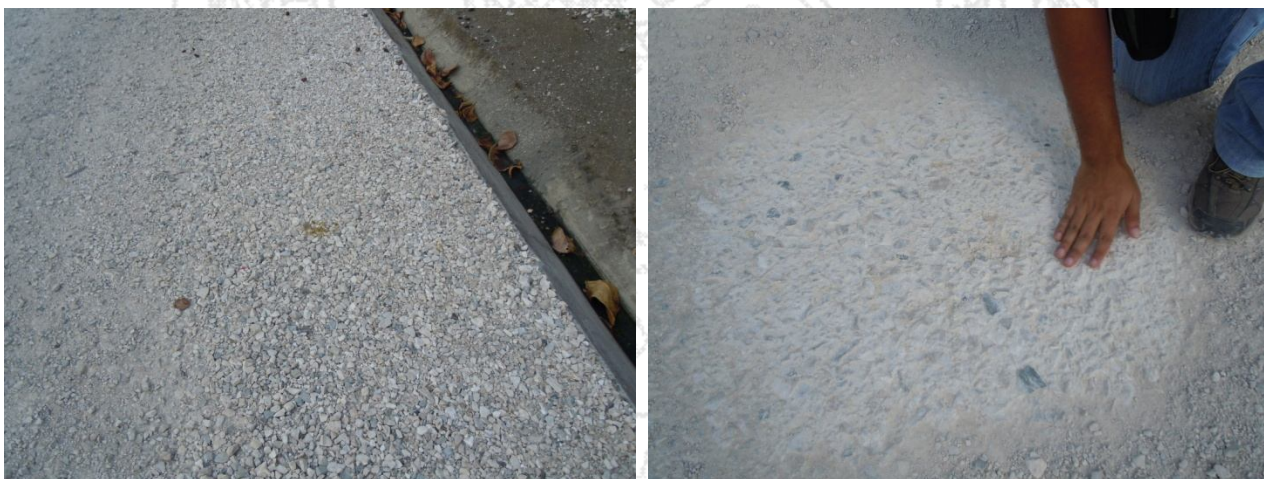
Figura 40: Material suelto en las orillas a ser retirado, estado de la base granular en apariencia en óptimas condiciones de compactación y adherencia. Fuente: LanammeUCR, 2011.
