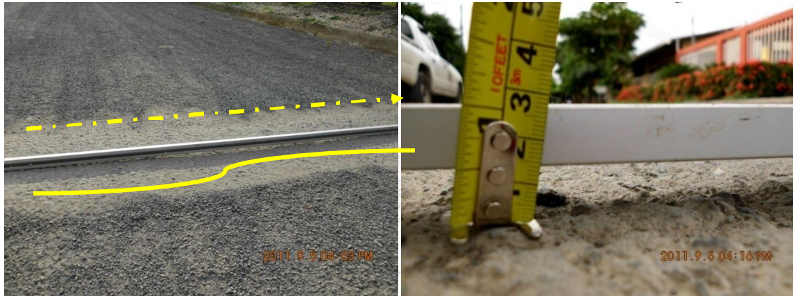
Figura 23: Ahuellamientos encontrados en algunos puntos del sector sur. Fuente: LanammeUCR, 2011.
