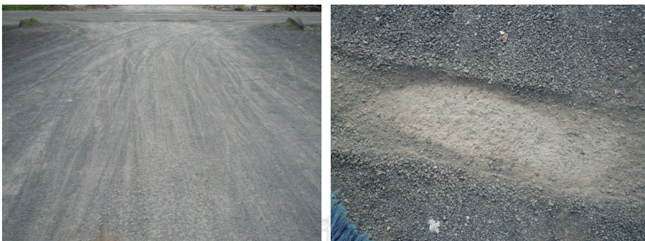
Figura 39: Exceso de material suelto reduce fricción de frenado. Fuente: LanammeUCR, 2011.
