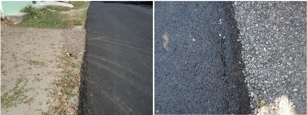
Figura 45: Ausencia de estructuras de manejo de agua favorece la introducción de agua y el desprendimiento de bordes.
