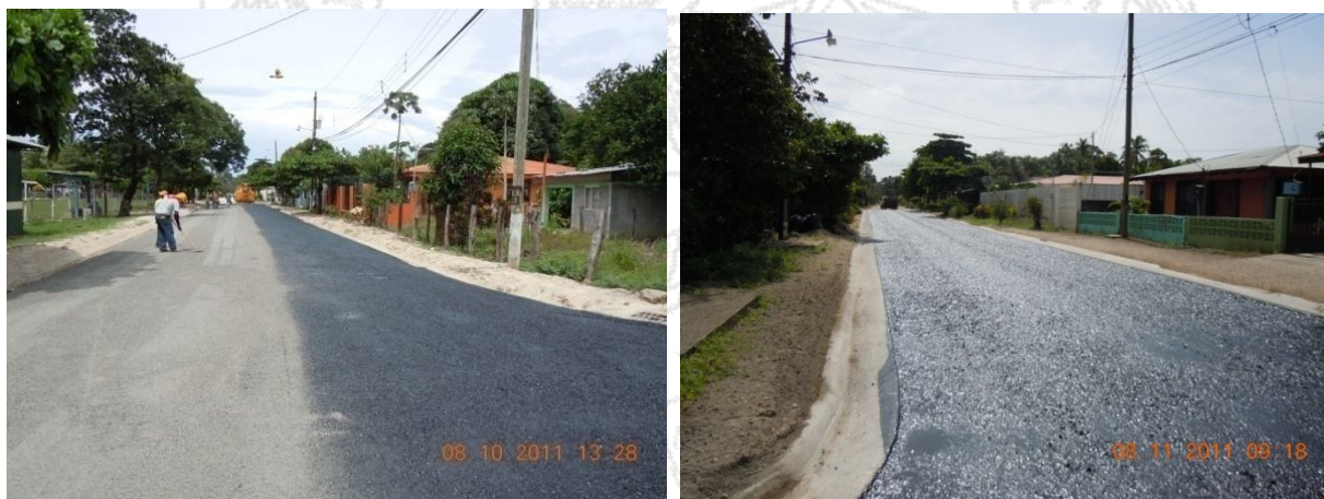
Figura 18: Tramos con riego de emulsión expuestos durante mucho tiempo, se propicia la pérdida de adherencia del agregado.
