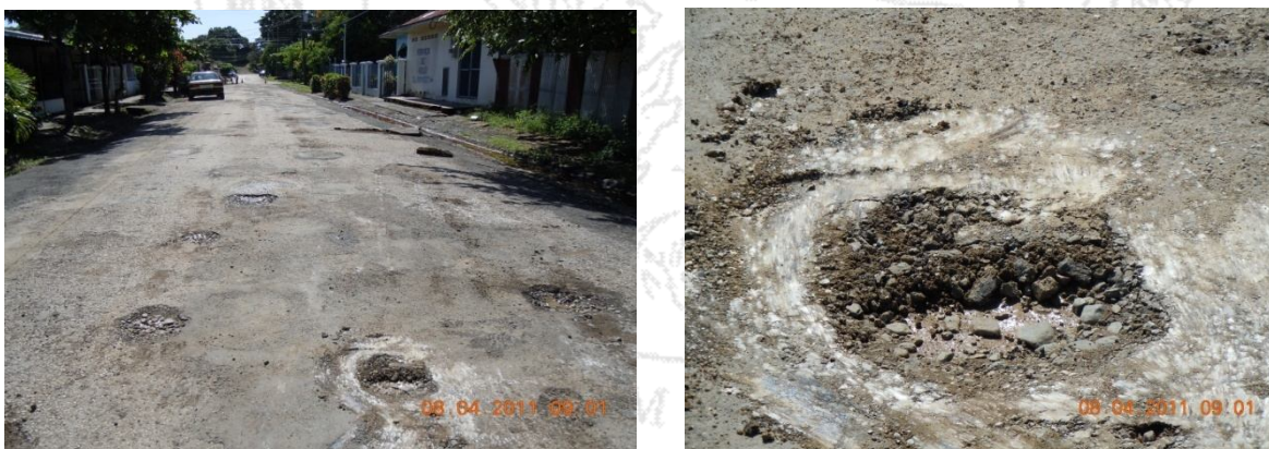
Figura 17: Condición de avenida en sector norte, se recomienda reconstrucción en base a resultados de evaluación de condición Fuente: LanammeUCR, 2011.
