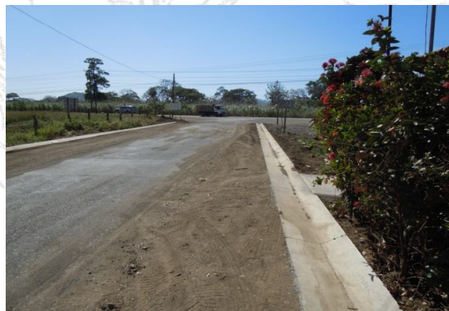
Figura 50: Condición actual de intersección favorece los empozamientos.
