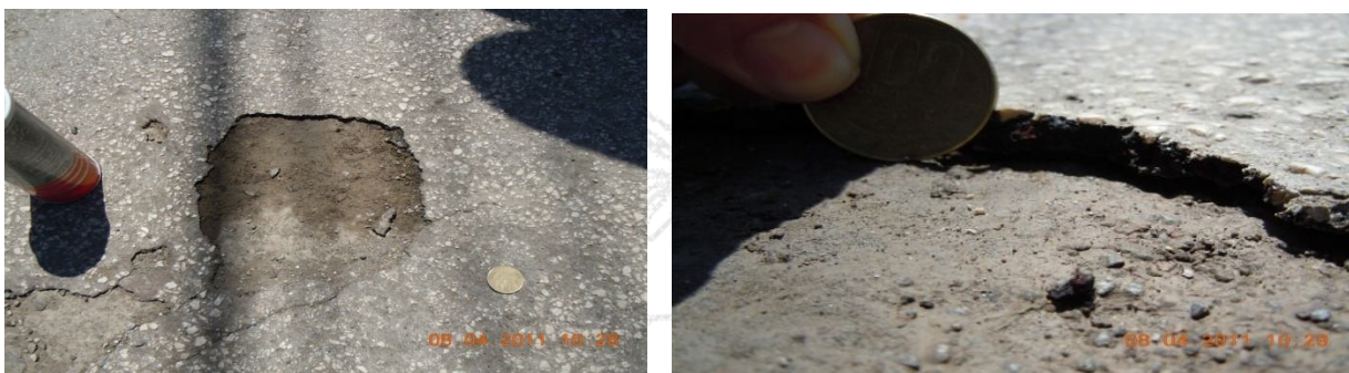
Figura 16: Condición de zonas a recarpetear. Fuente: LanammeUCR, 2011.
