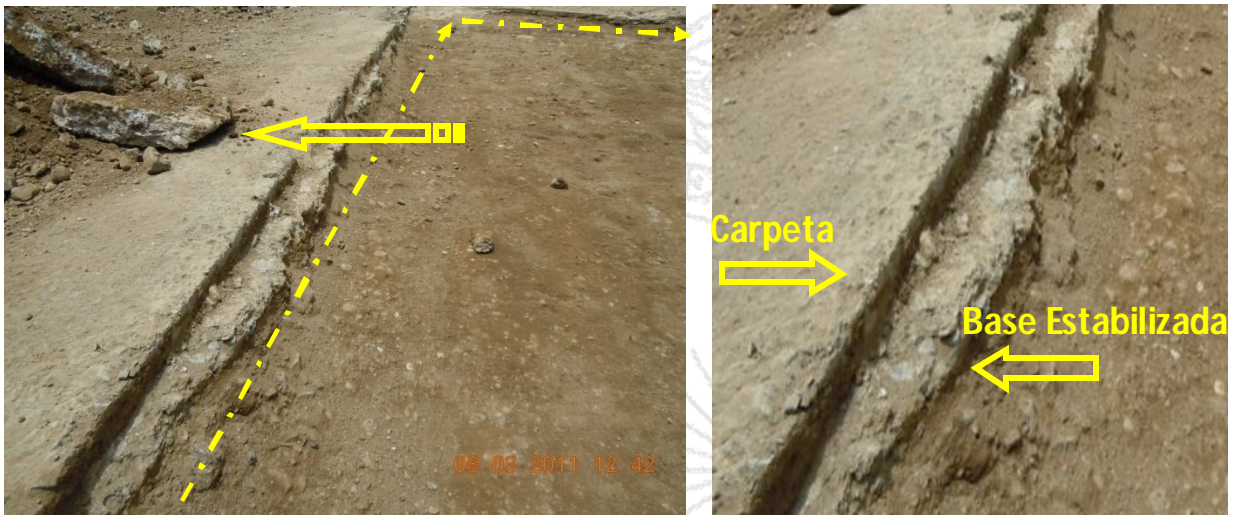
Figura 14: Remoción excesiva de material existente en zonas de bacheo sector norte. Fuente: LanammeUCR, 2011.
