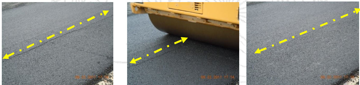
Figura 37: Secuencia de corrección de grieta dejada por la pavimentadora. Fuente: LanammeUCR, 2011.
